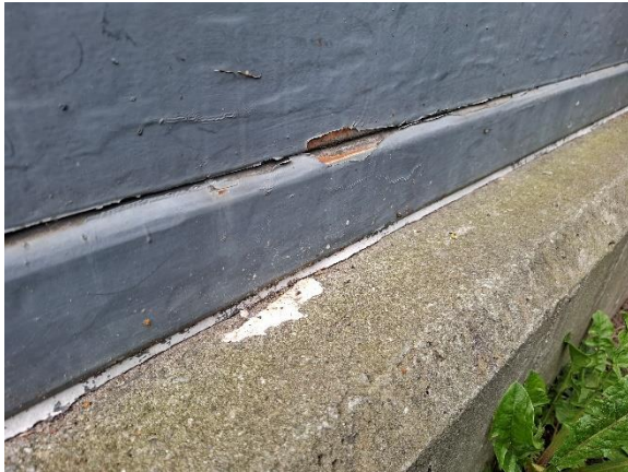
Elevatortårn bygning E med afskallende maling og begyndende rust.
