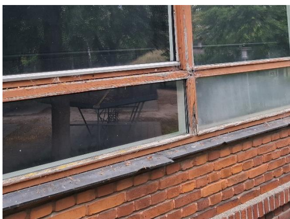
Vindue på bygning D med råd i karme og løse sålbænke som er gledet ud.
