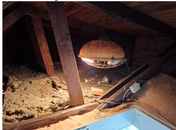
Installationer ved loftlem
