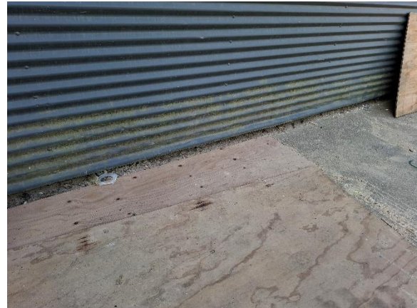
Facade og sokkel bygning H med alger.
