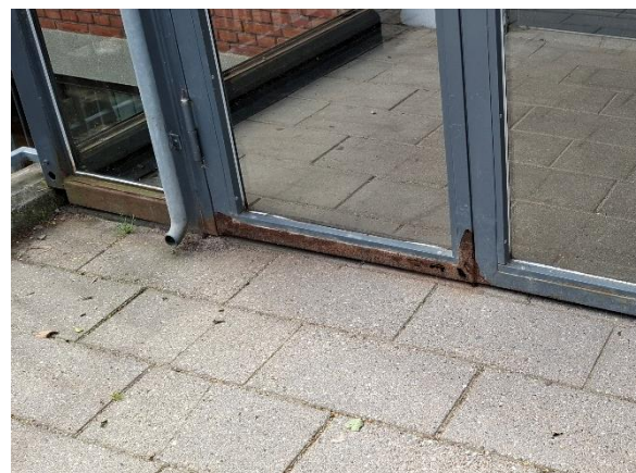
Dør til vindfang i bygning E mod øst er gennemtæret i bundramme.
