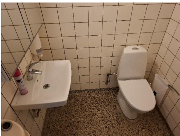
Nyere toilet med 2 skyl og armatur med 1 greb
