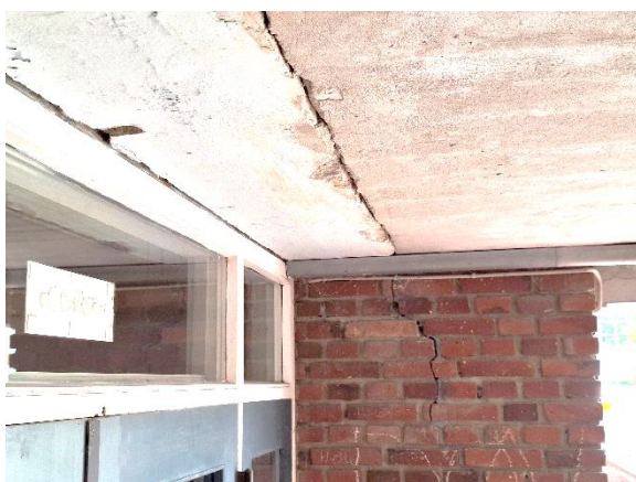
Revne mellem bygning C og G fortsætter ned i facademurværk.
