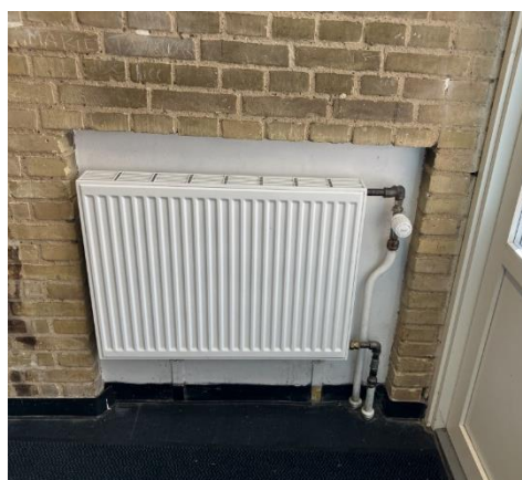
Nyere lav-temperatur radiator med nyere termostatventil
