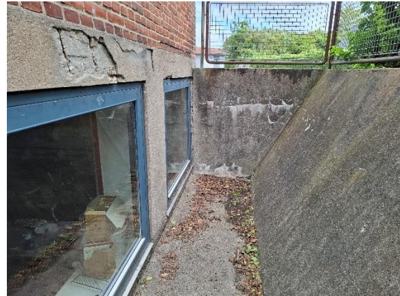
Lyskasse til billedkunst i bygning E er med korroderede jern hele vejen over vinduerne. Hvor der ikke er betonafskalninger, er yderste betonlag med manglende vedhæftning. Lyskasse har revner i alle støttemure og top ved montering af værn.
