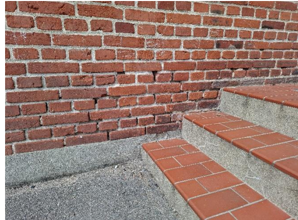
Manglende fuger pga. saltning ved trappeopgang mod syd bygning E
