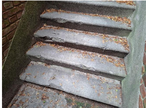
Afslag i beton på trappe til kælder i bygning D
