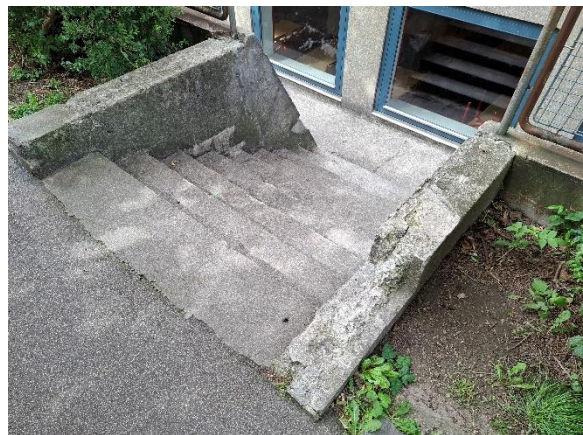
Trappe med betonskader på støttmure til lyskasse mod bygning E mod syd
