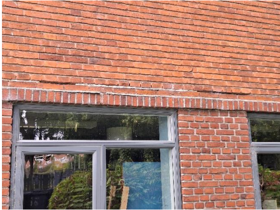
Løse og krakelerede fuger over vinduer i stuen, bygning D mod øst
