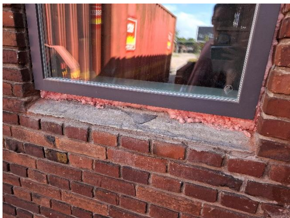
Vindue fra 2016 hvor sålbænk og fuger mangler på to vinduer i bygning A. Vindue monteret med skum.
