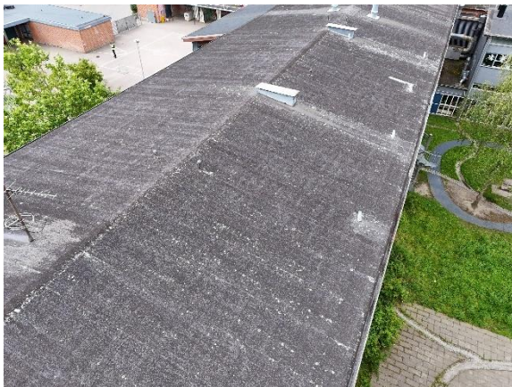
Slidte tagflader på bygning C
