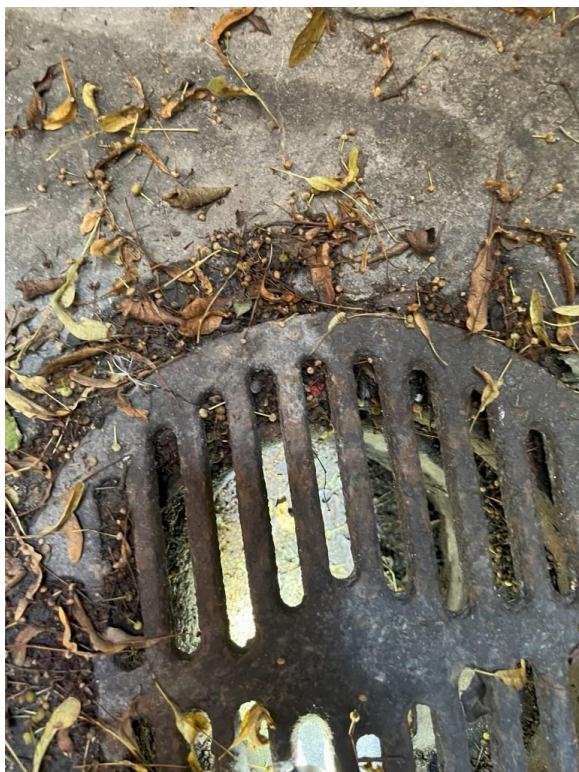
Sandfyldt regn afløb
