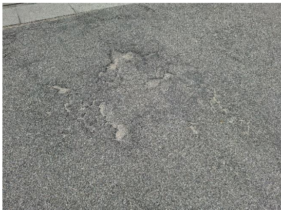
Begyndende skader i asfalt skolegård.
