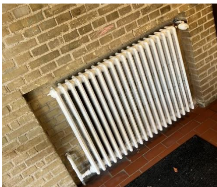
Originale støbejernsradiator, med nyere termostatventiler
