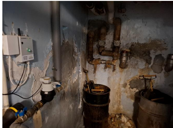
Opfugtede kælderydervægge i bygning D
