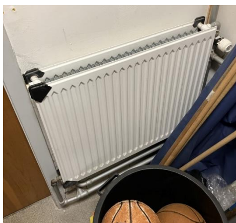
Ældre radiator med ældre termostatventil
