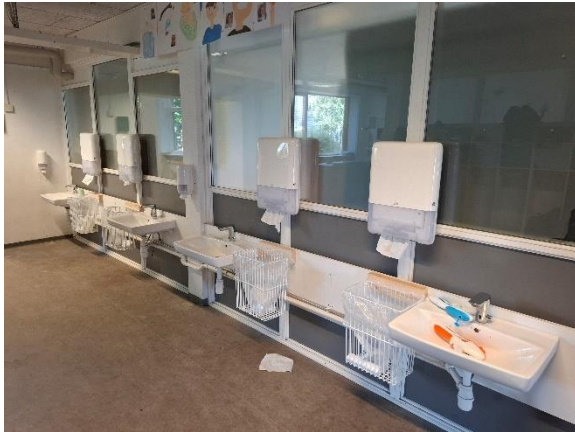
Armaturer med følger på håndvaske i gangen til bygning C
