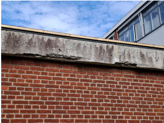
Afslag i betonen på bygning F mod syd med blottet, tæret armering
