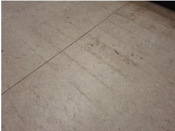
Linoleumsgulv i bygning C stuen er krakeleret og med synlige golvplanker.
