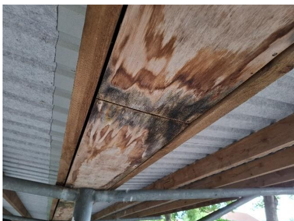
Skotrende underside på cykeloverdækning.
