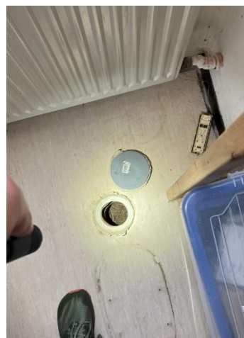
Toiletrum omdannet til lager; klosettilslutning mørnet. Der skal anvendes korrekt Muffeprop.
