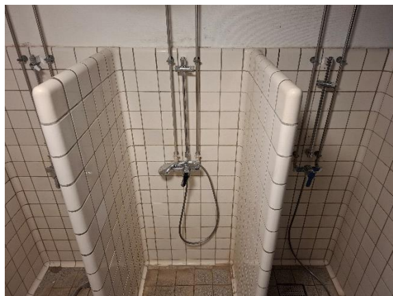
Brusearmaturer i bygning F
