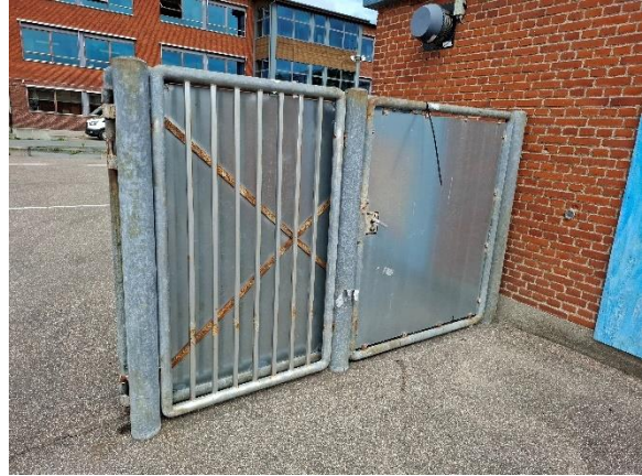
Der ses begyndende korrodering af jern og hængsler.
