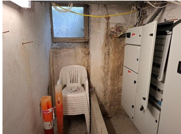
Hovedtavle i ubrugt kælder
