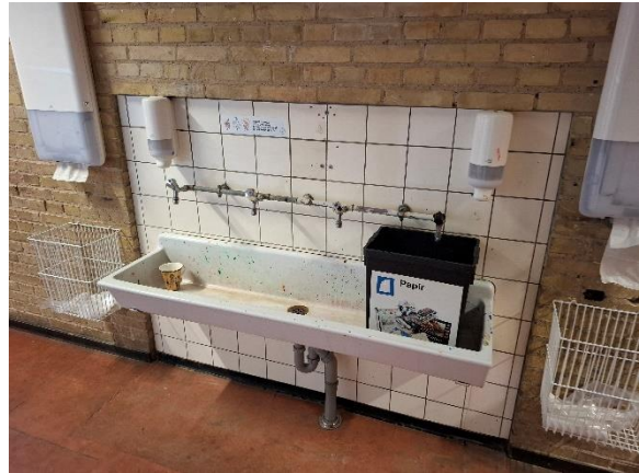
Håndvask med 1-grebs armatur i gangen til bygning E
