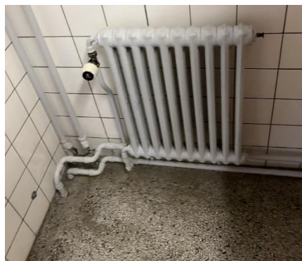
Original støbejern med ældre termostatventil.
