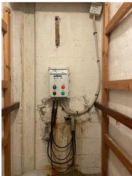
Pumpestyring i kælder under 1954 bygningen. Fabrikant Desmi
