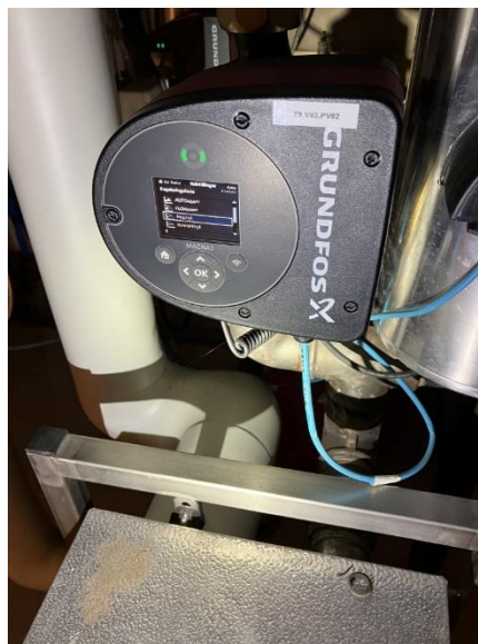
Nyere Magna 3 pumper i nyere fjernvarme installation
