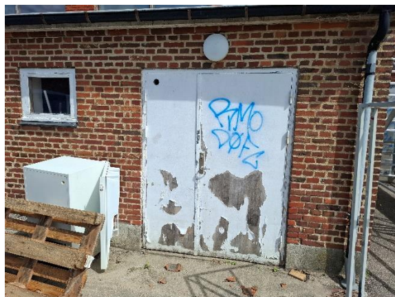
Trædør i bygning B mod vest med afskallende maling
