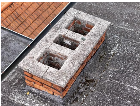
Knækket skorstensafdækning i bygning C
