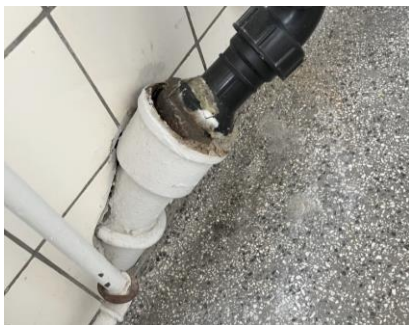
Personale toilet med åben kloak på toilet
