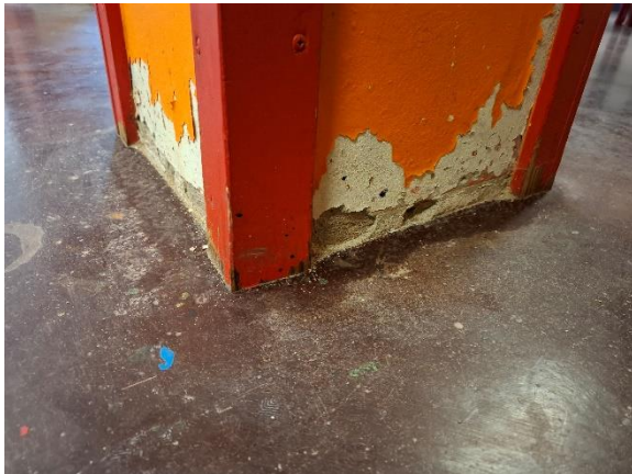
Opstigende grundfugt i søjle billedkunstlokale i bygning E
