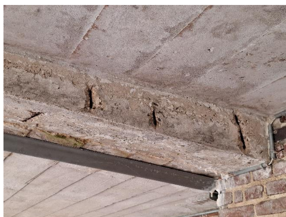
Afslag og korroderede jern i in-situ tagkonstruktionsoverdækning mod gården i bygning F og G.
