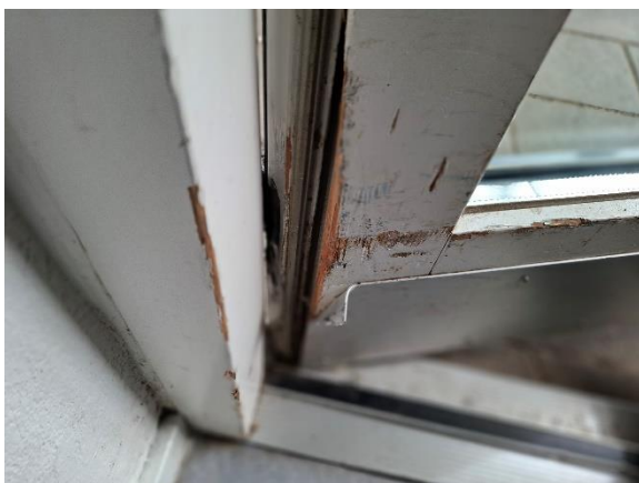
Træ/alu dør til indgangsparti i bygning E mod øst er slidt.
