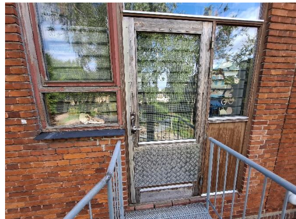
Dør til klasselokale fra 1976 har udtjent sin levetid.
