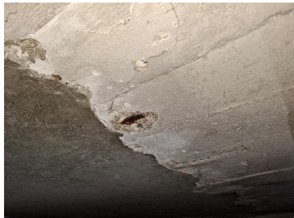
Afskalning ved korroderet jern i varmecentralen bygning B
