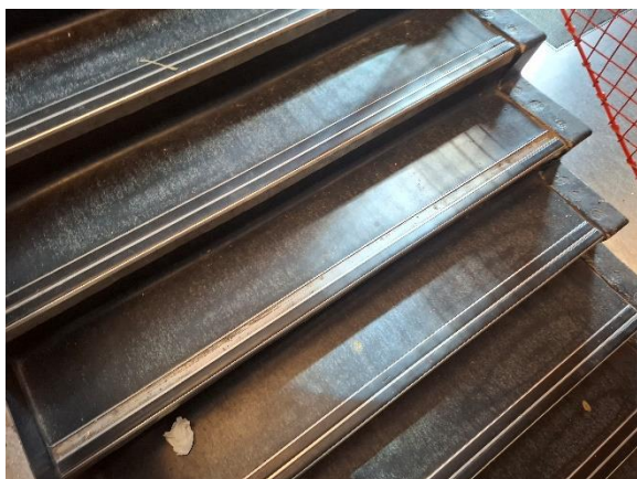
Trappe i bygning E syd med manglende liste i stålforkant
