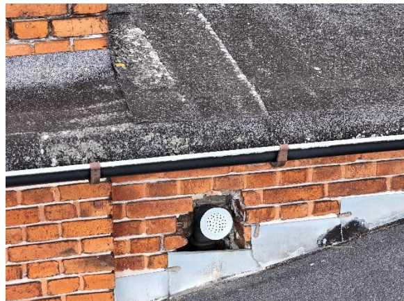
Gennemføring af rør bygning C mod vest er ikke afsluttet i facade.
