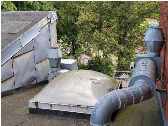
Ovenlys med hul i bygning D. Der mangler inddækninger langs den forskudte tagflade og beklædning er tæret
