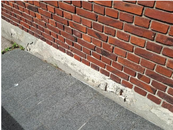
Afskallende puds og blotlagte korroderede jern i sokkel ved rampe til indgang mod vest bygning E
