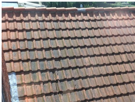
Knækkede teglsten i bygning A. Rygningssten mangler to steder.
