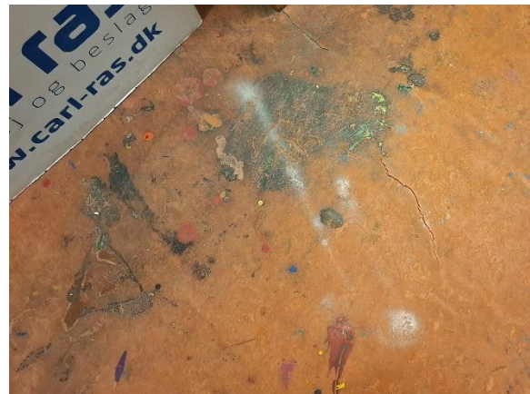
Linoleumsgulv i kælder er krakeleret og indtørret
