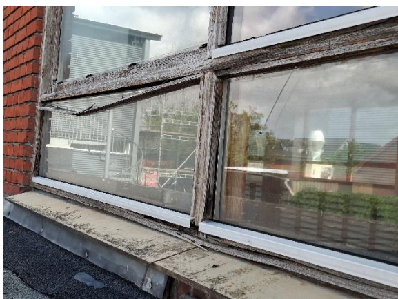
Vindue i bygning B mod syd er med nedbrydning i karme og glaslister er rådnet helt og delvist faldet af.
