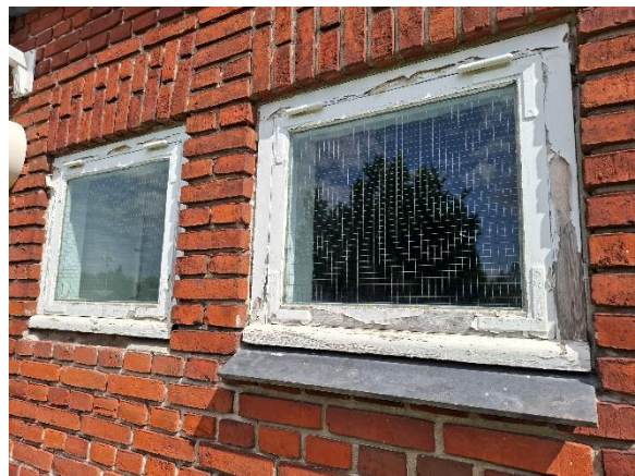
Manglende sålbænk og afskallende maling på vinduer i bygning G
