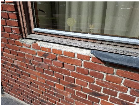
Manglende sålbænk under vindue i bygning C ved rampe
