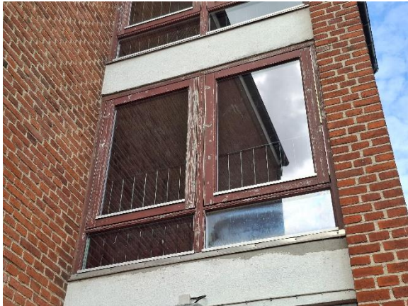
Afskallende maling på vindue i trappetårn i bygning E mod syd.
