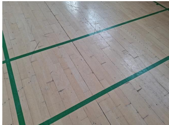
Gulv i gymnastiksalen i bygning B er slidt
