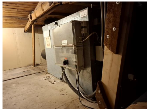
Ventilationsenhed på loft fra Exhausto
