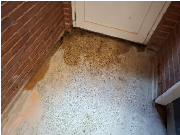
Indtrængende vand gennem kælderskakten i bygning D.
