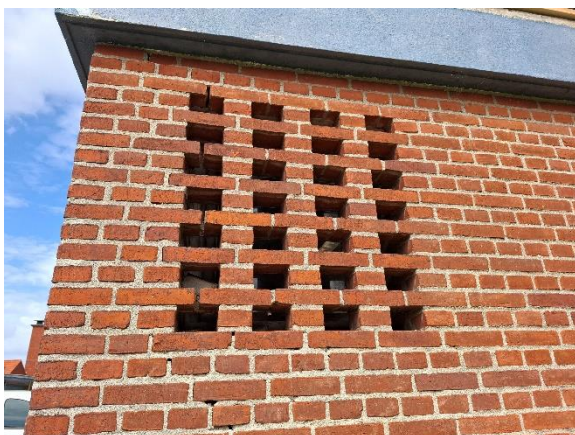
Bygning F mod syd. Fuger mangler ved vindue.
