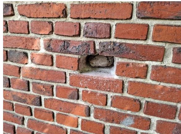
Manglende sten på facade mod vest i bygning D
