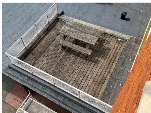
Tagterrasse bygning G mangler værn til en side.
