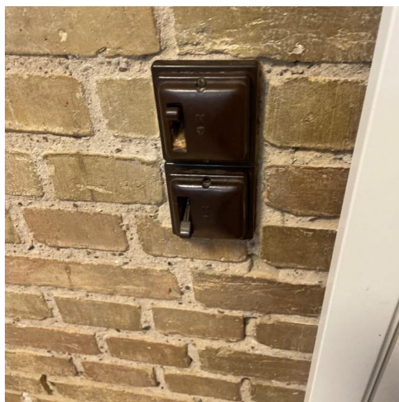
Eksempel på forældet installationsmateriel
