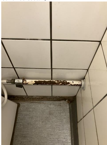
Tydelig overfladetæring på rørinstallation
