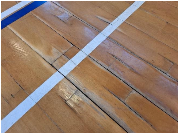
Tidligere vandskade på gulv i gymnastiksalen i bygning F
