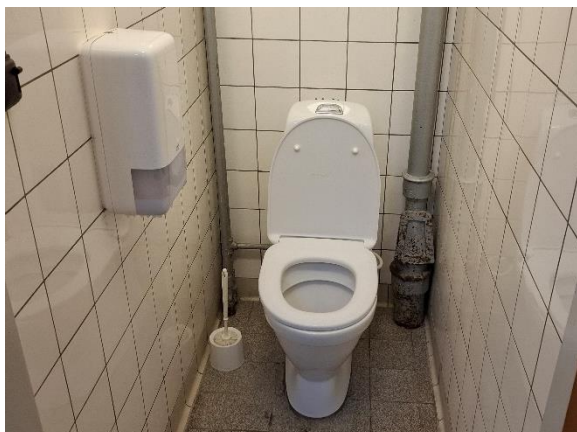
Nyere toilet med 2 skyl.
