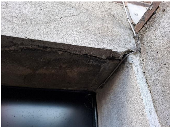
Krakeleret og løst puds med manglende vedhæftning efter korroderet jern over dør til varmecentral i bygning B
