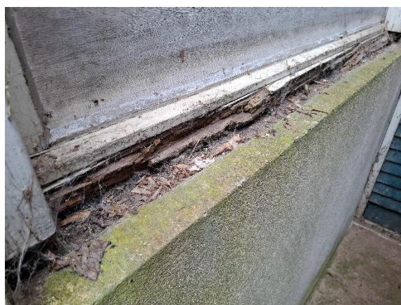
Kældervindue i bygning E med nedbrydning i bundkarm
