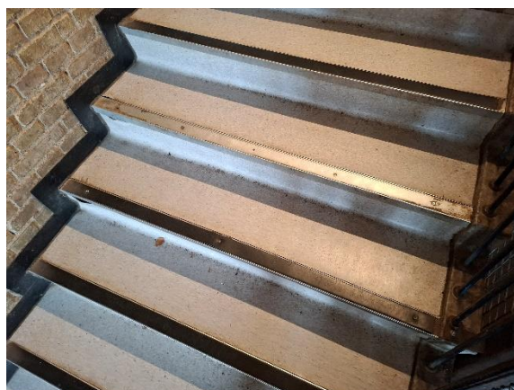
Slidte flader og manglende trinfor-kant på trappe i bygning E nord.
