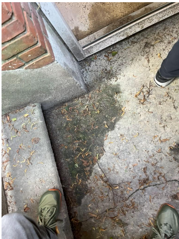
Vand har stået i 10-20 cm.
