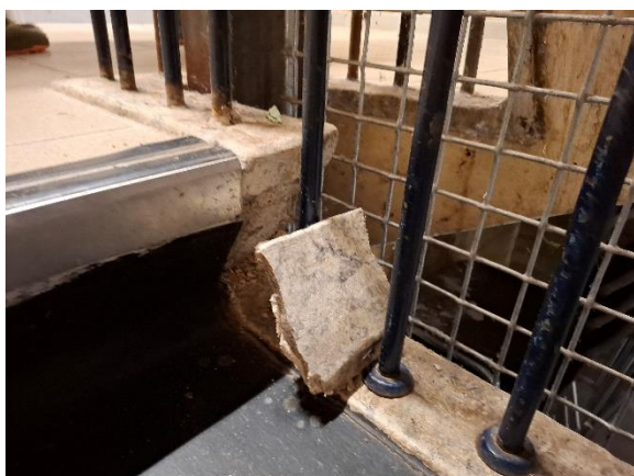
Afslag i betonkanter i bygning E nord
