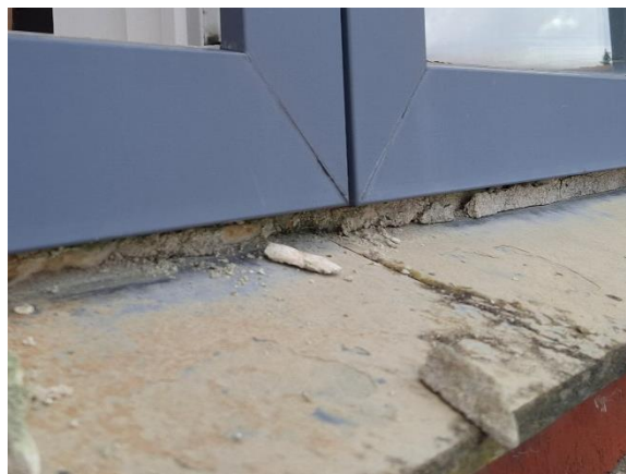
Løse fuger med manglende vedhæftning på nyere vinduer i bygning B
