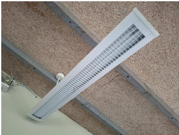
HF-armatur i fælleslokale
