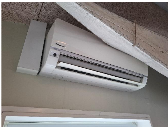
Varmepumpe, indvendig del
