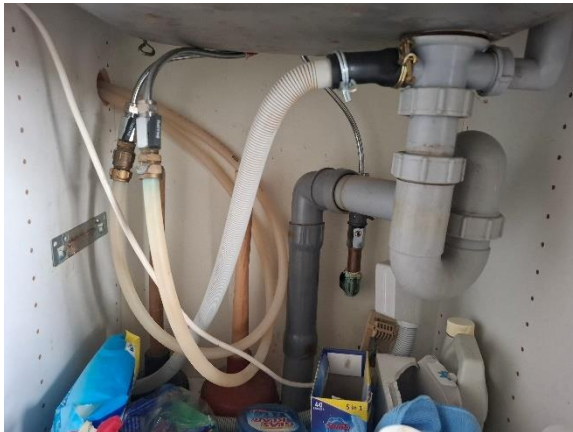
Afløbsinstallation under køkkenvask
