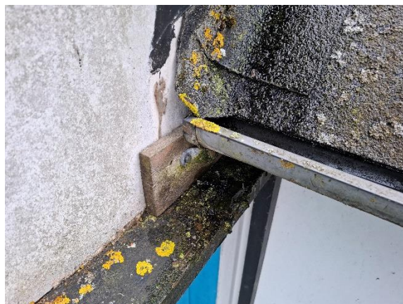
Utæt sammenbygning mellem tagflade og gavl på båd-hustilbygningen.
