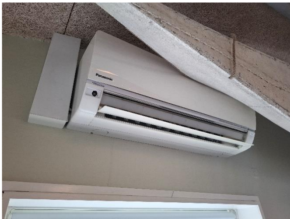
Varmepumpe, indvendig del
