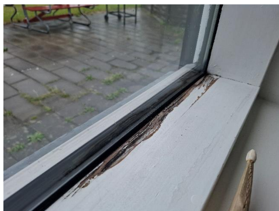
Nedbrudt træ indvendigt på karme.
