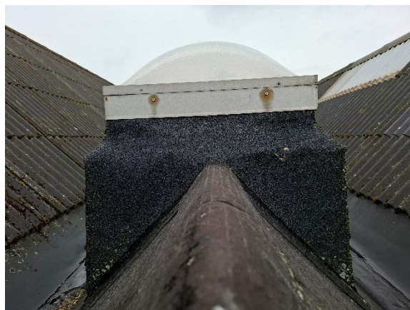
Ovenlyskupel i fordelingsgang.
