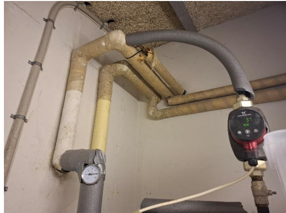
Cirkulationspumpe med rørsystem
