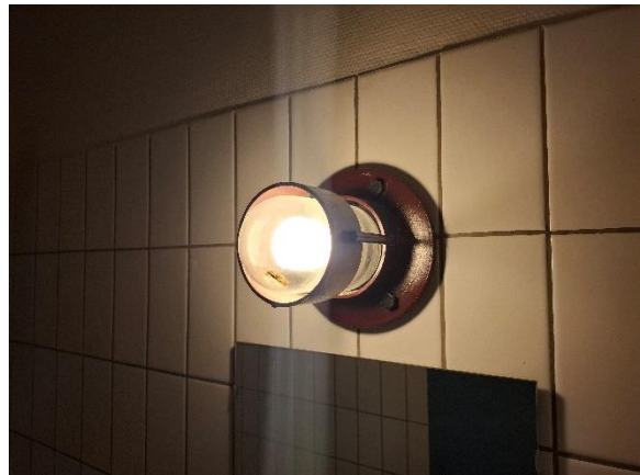
Armatur i omklædningsrum
