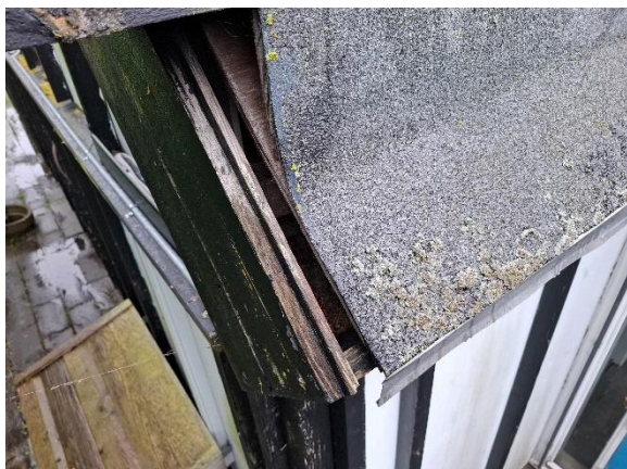
Manglende inddækning mod nord resulterer i vand i konstruktionen.
