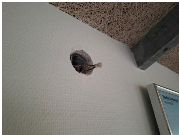
Samlingsdåse mangler afdækning
