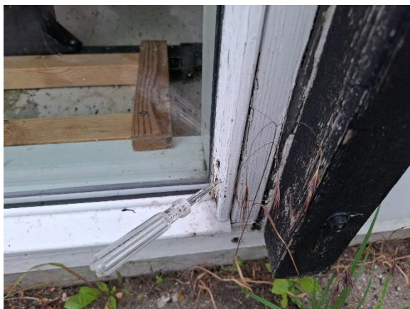
Nedbrudt glasliste i vinduesparti til træningsrum
