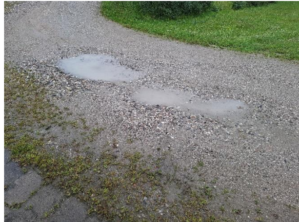
Lunker i adgangsvej
