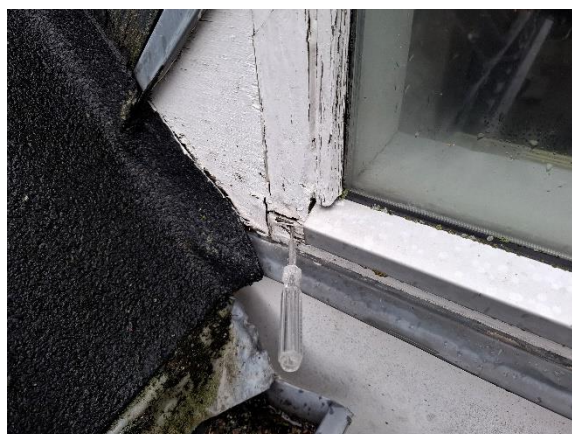
Nedbrudt træ på vinduesoverpartier i fordelingsgang
