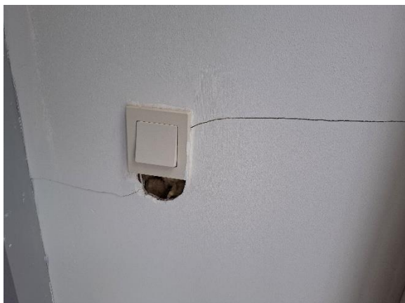
Afbryder med manglende afdækning
