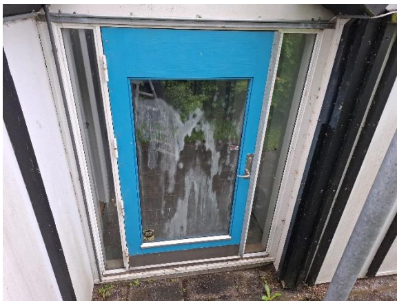
Punkteret rude i nordvendt dør i fordelingsgang.
