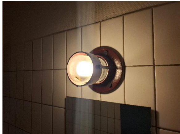
Armatur i omklædningsrum
