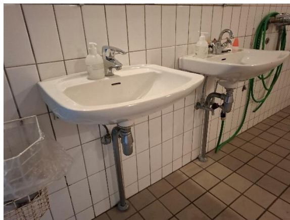
Håndvaske i omklædningsrum
