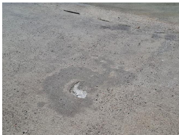
Betonafskalning i rampe til havnen
