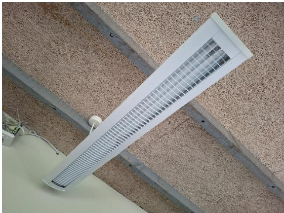
HF-armatur i fælleslokale
