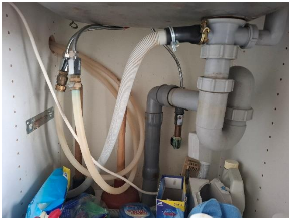
Brugsvandinstallation i dykkerklubbens køkken
