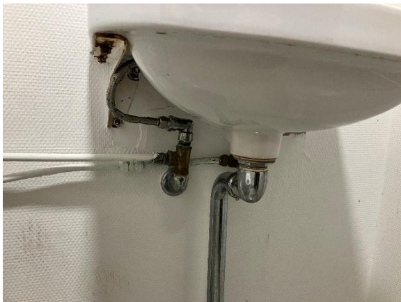
Kobberrør under håndvask
