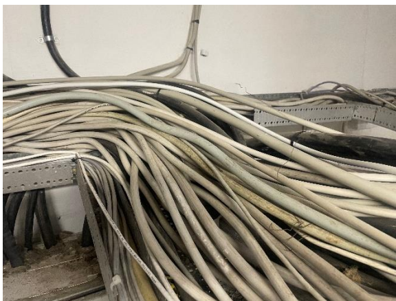
Fuglerede af kabler i kabelbakke over hovedtavle
