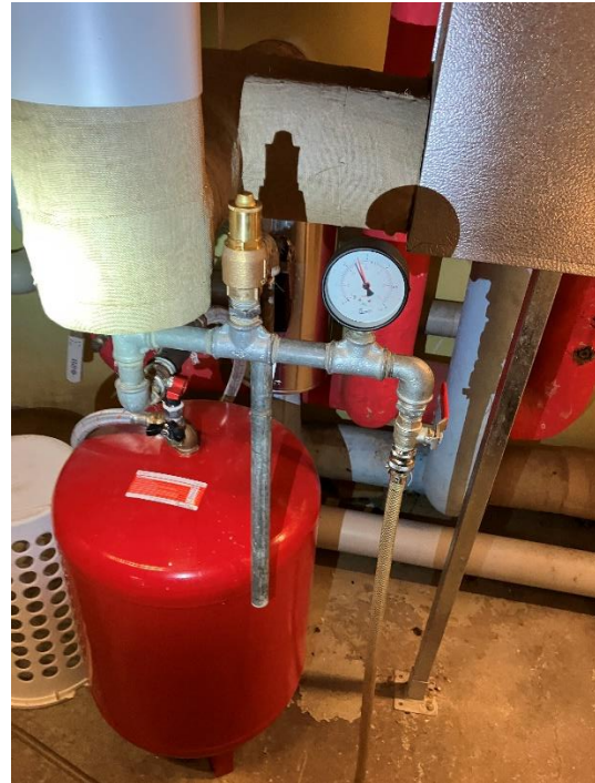
Ekspansion beholder med sikkerhedsventil og en varmeveksler øverst til højre.
