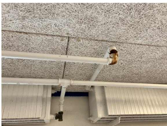
Utætheder og rust.
