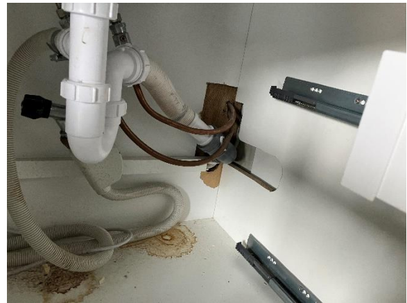
Vandlås under håndvask i køkkenskab
