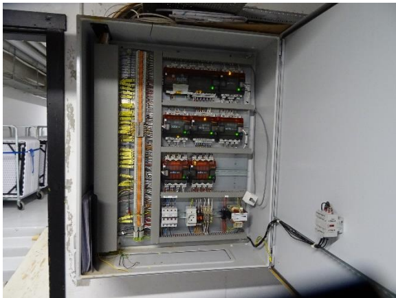
Automatik for varmestyring i varmecentral
