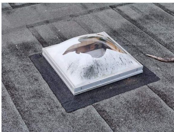
Tag og defekt ovenlys på udhus ved cykelparkering
