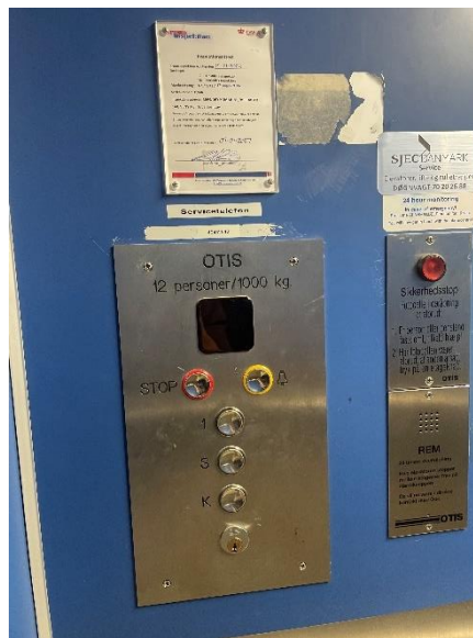
En af de to OTIS elevatorer. Begge er fra 1971
