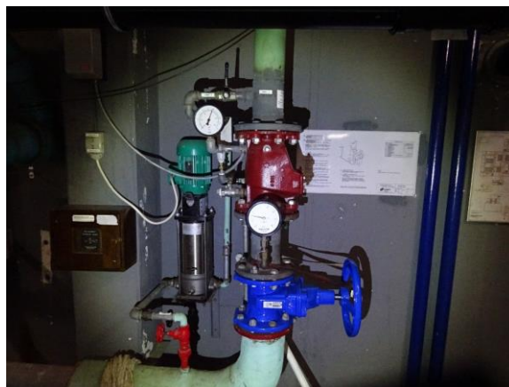
Alarmventil og sprinklerpumpe
