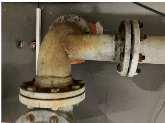
Zink er brugt op i overfladen på galvaniseret rør.
