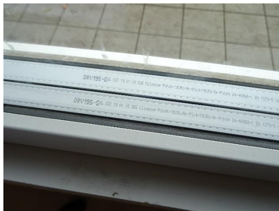
Skolens vinduer, 3-lags fra 2016
