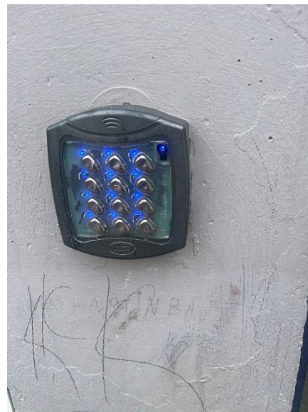
Adgangskode panel ved hovedindgang B
