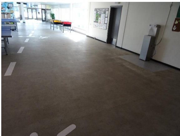
Hovedfordelingsgang som har noget af det mere slidte linoleum
