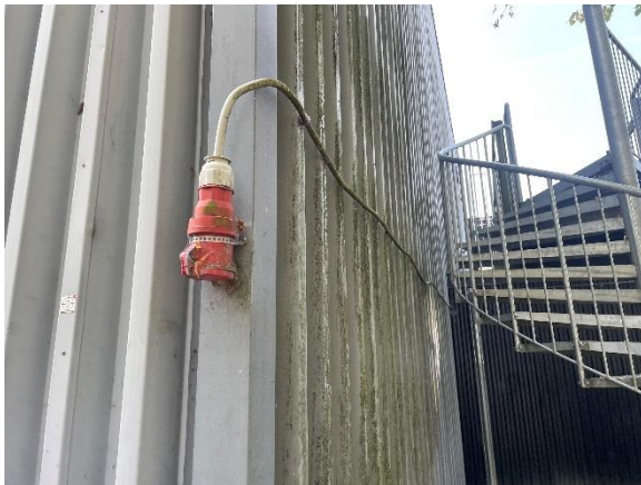
CEE stik forkert afsluttet på væg af idrætshallen
