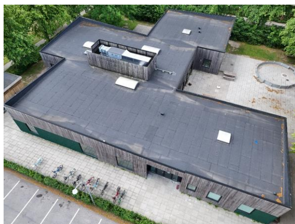
Tag på Ventilen
