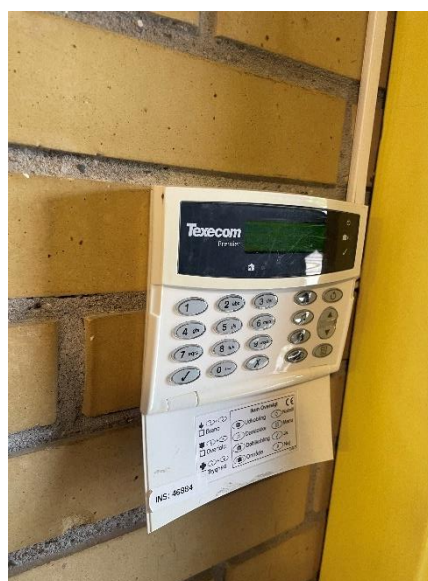
Alarm panel ved hoveddør
