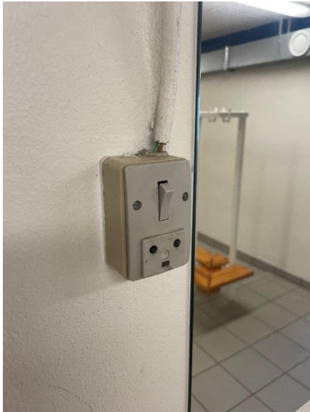
Kabel ikke afsluttet i ældre stikkontakt
