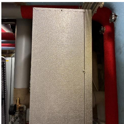
Varmeveksler i hallen
