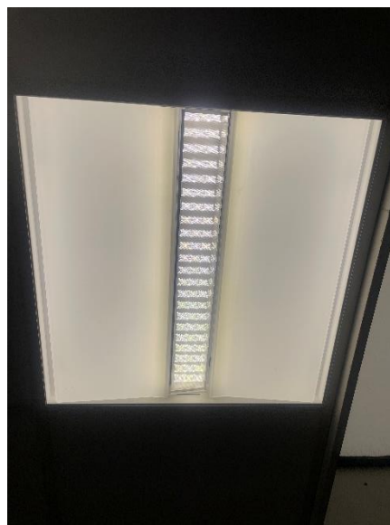
Belysningsarmatur med LED
