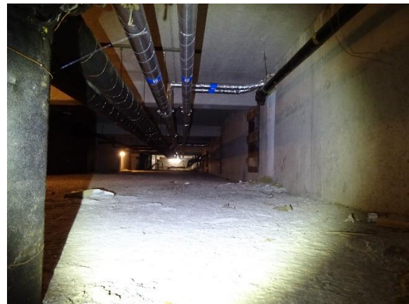
Brugsvandsrør på skolen
