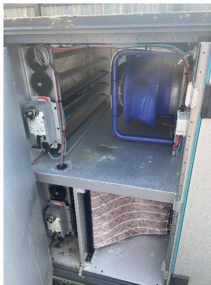
SFO Ventilen anlæg fra 2021
