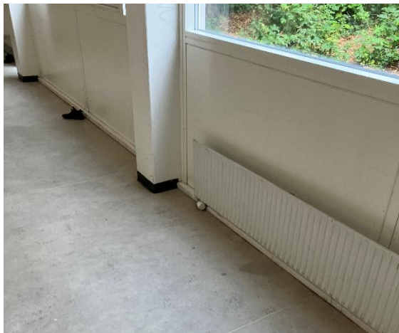
Mange ældre enkeltpladeradiatorer der ikke har nødvendig afkøling ved lavtemperatur fjernvarme
