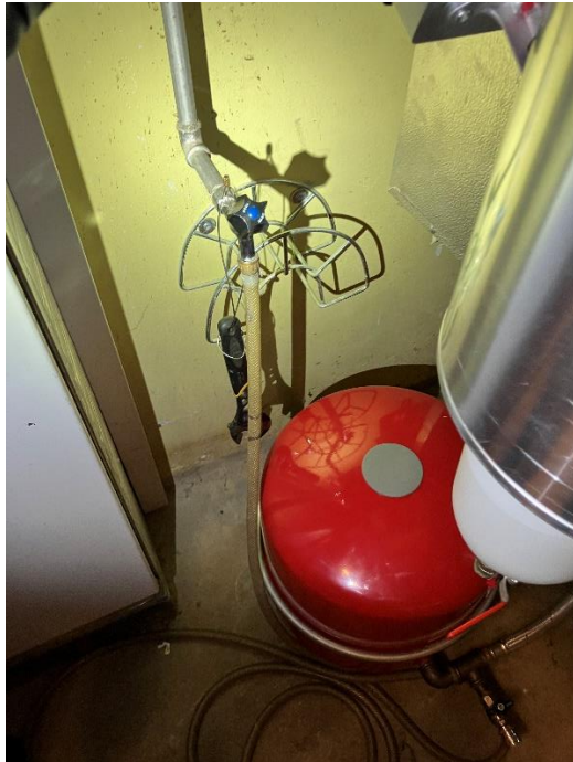
Postevand på varmeanlæg er generelt en rigtig dårlig ide. Her mangler der yderligere en tilbageløbssikring hvilket ikke overholder gældende regler.
