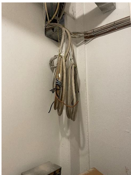
Uafsluttede kabler i bundt, kælder
