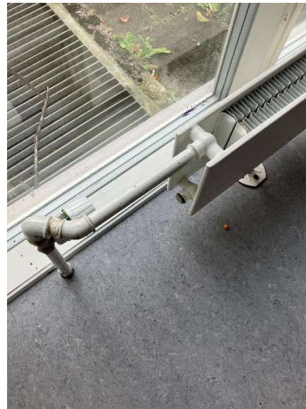
Rustgennembrydning af malede rørflader. Men nyere termostatatventiler
