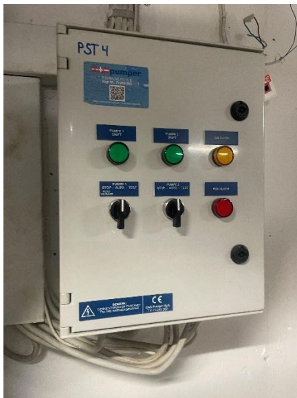
Pumpe styring til grundvandspumpe fabrikant DESMI
