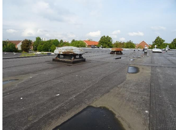
Tagventilatorer som står for udsugningen
