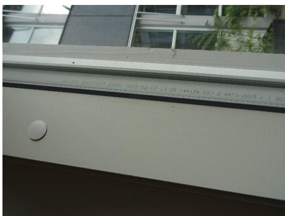
Skolens vinduer, 2-lags fra 2015
