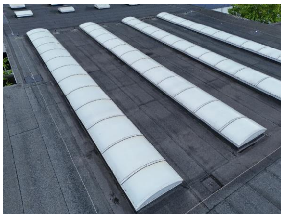
Ovenlysbånd over PLC
