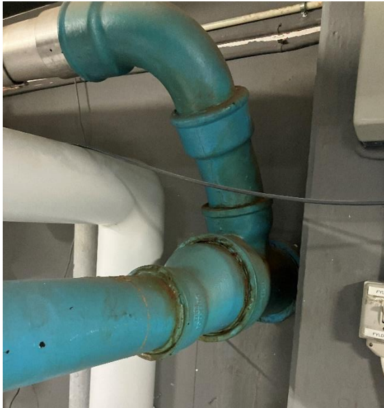
Mengering o-ring er begyndende nedbrudt og der vil komme utætheder.
