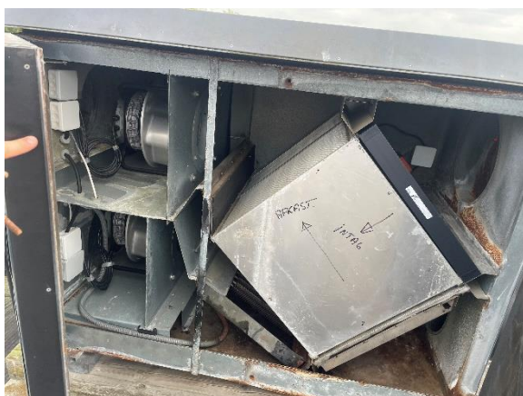
Ventilationsenhed med X-varmeveksler. Ventilering af køkken. Lader til at have modtaget en udskiftning af ventilator motorer.
