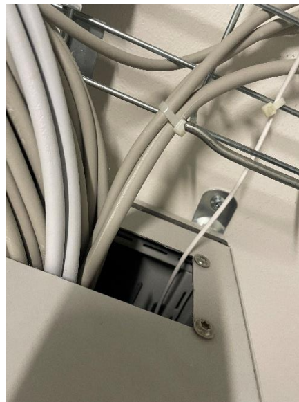
Ukorrekt afsluttet gennemføring i tavle i idrætshallen
