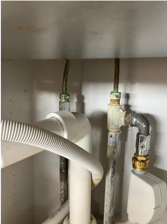
Korrosion af overflader grundet kondens på overflader
