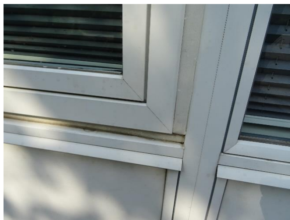
Træ/alu vinduer med træ karme fra 2014-2016
