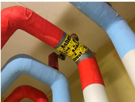
Der er konstateret Asbest i hallens varmecentral
