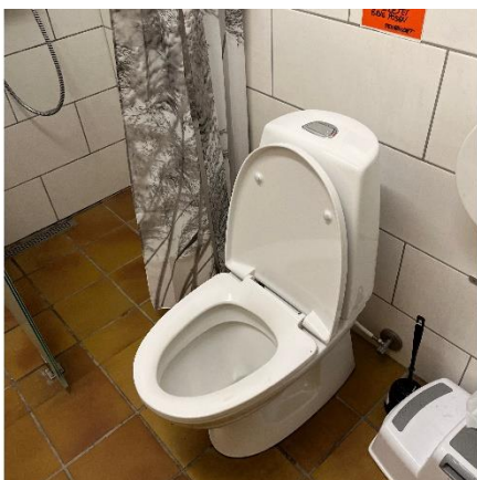
Toilet med to-skyl
