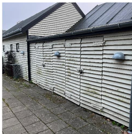
B2 Træfacade med mos og alger
