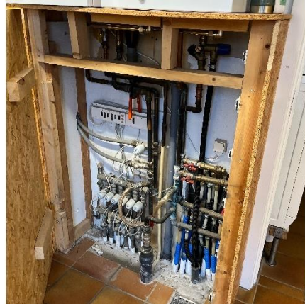
Gulvvarmeinstallation i skab
