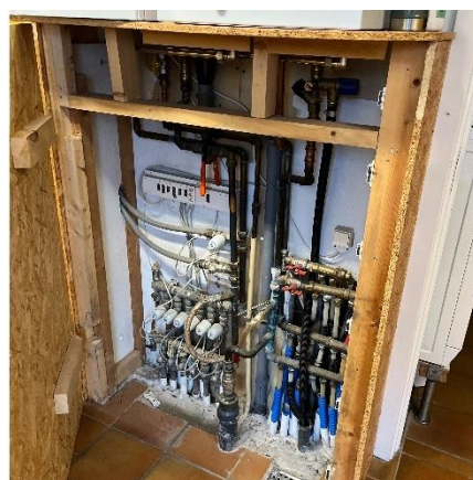
Gulvvarmeinstallation i skab
