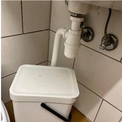
Afløb i plast på toilet
