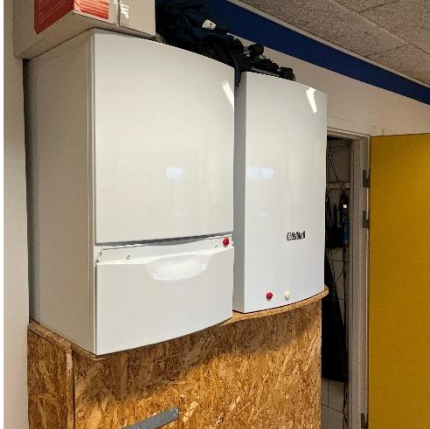
Gaskedel og varmtvandsbeholder
