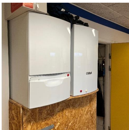
Gaskedel og varmtvandsbeholder
