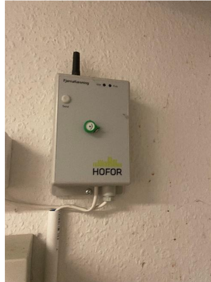
Fjernvarme styrings unit
