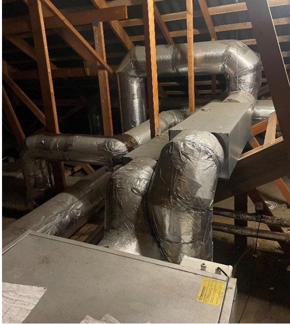
Aggregat og lyddæmpere på loft
