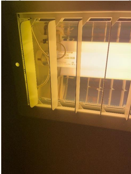
36 w lysstofrør med konventionel for kobling.
