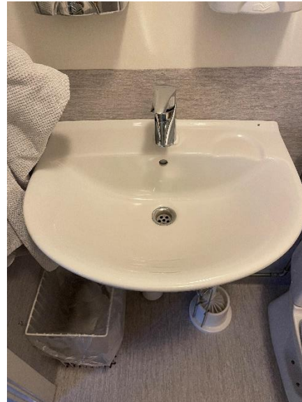
Vandarmatur ved håndvask
