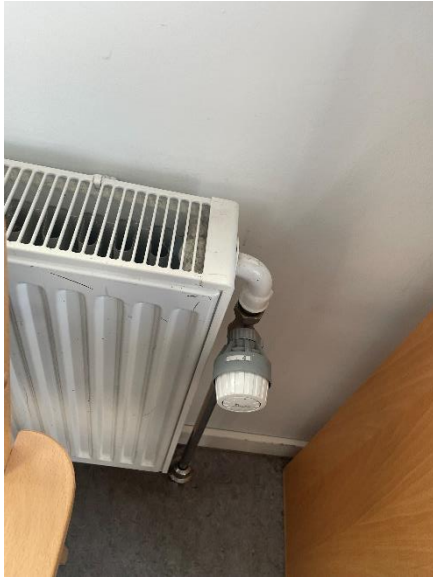
Radiator med termostat
