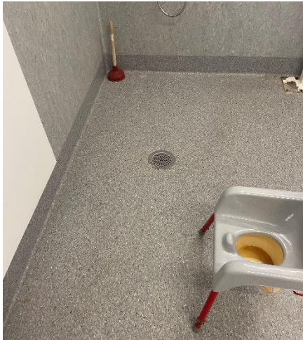
Afløb på handicap toilet.
