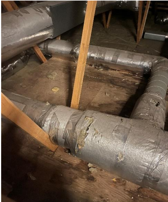
Skader på isoleringen af rør
