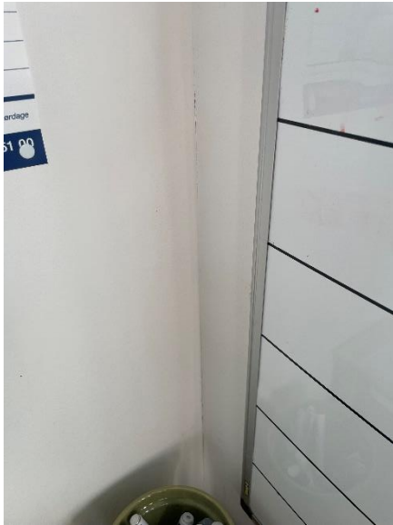
Gipsvæg med slidmærker og revner i samlinger
