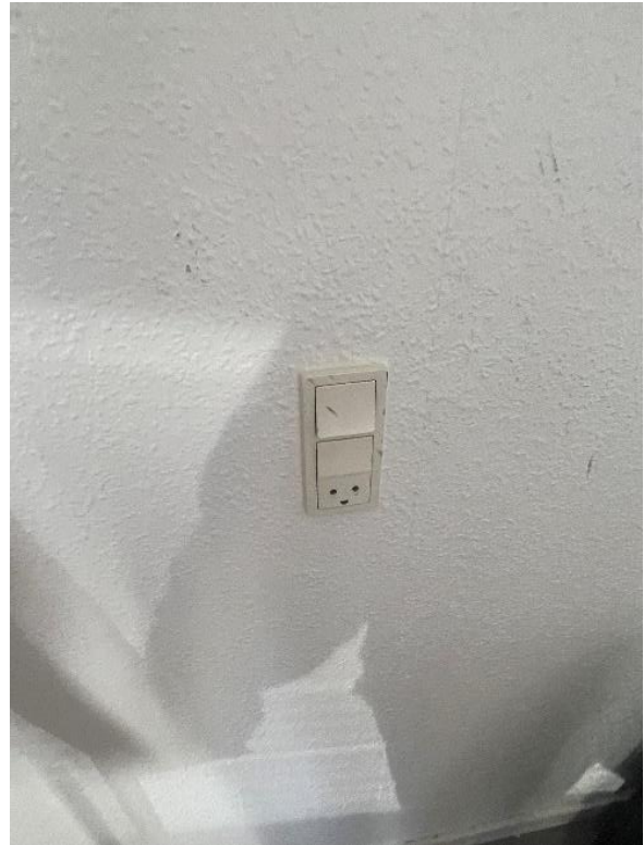
Ældre beskidt stikkontakt og afbryder
