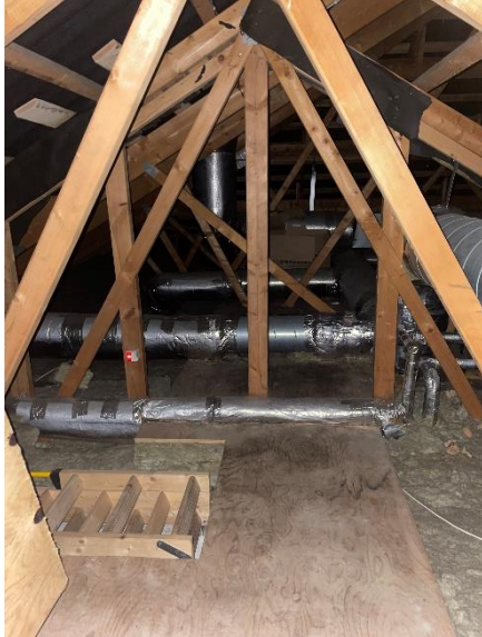
Ved trappeopgang i tilbygningsenden
