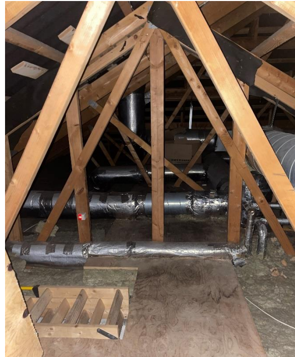
Kanaler på loft
