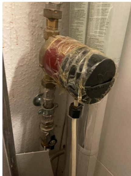
Grundfos pumpe med plastik/tape over sig, grund kendes ikke
