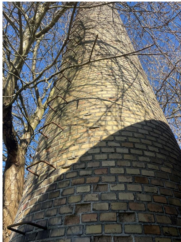
Afslag fra mursten på skorsten kan ses på billedet.
