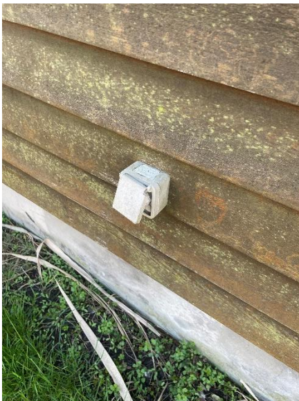
Skadet stikkontakt udvendigt
