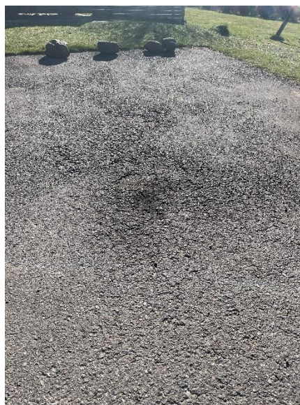
Brud i asfalten på parkeringspladsen foran bygningen
