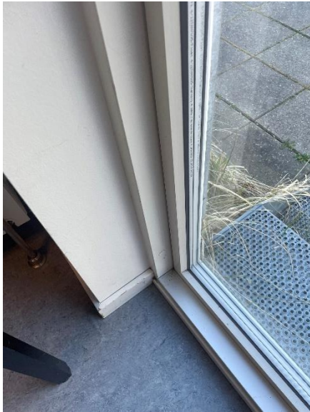
Glasdør med tre lags energirude kold kant
