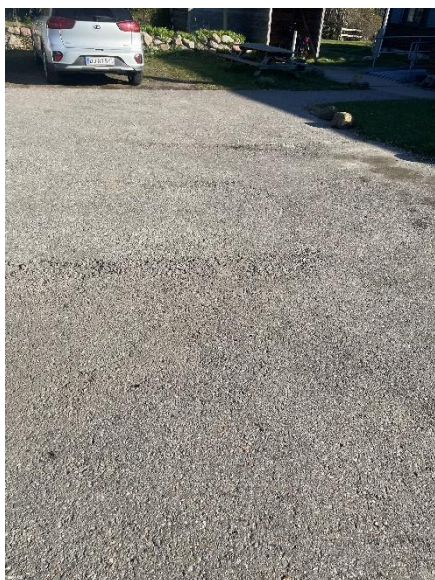
Brud i asfalten på parkeringspladsen foran bygningen
