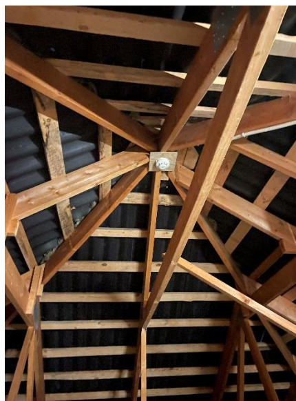
Brandalarm i tagkonstruktion over ventilationsanlæg
