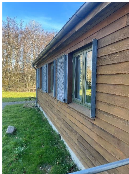
To lags energiruder med kold kant i træ ramme fra 2005 set udefra
