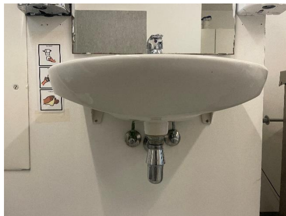
Afløb under håndvask i personale toilet
