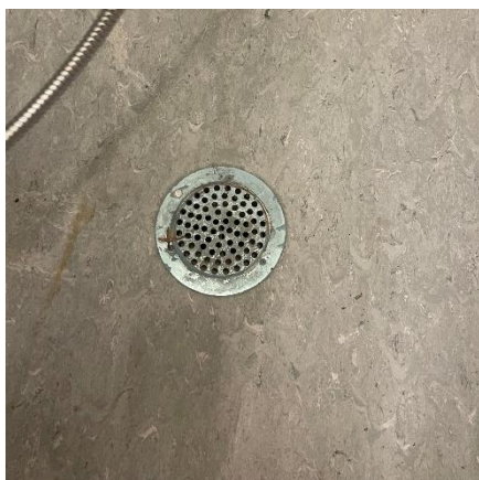
Afløb ved bad/omklædning i vinylgulv
