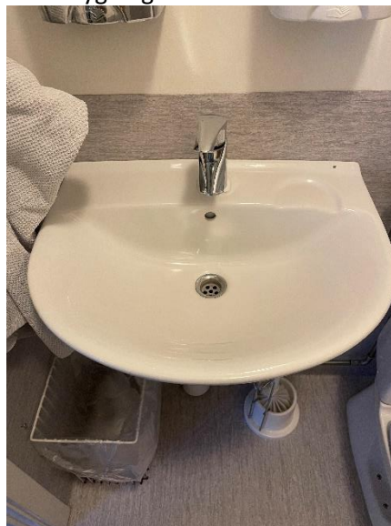
Der er brugt samme type håndvask og armaturer i alle 3 toiletter.
