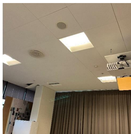
Møde-/opholdsrum med kompakttrør
