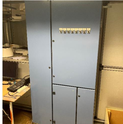
Styringstavle til ventilation
