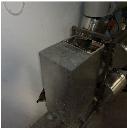
Varmeveksler i teknikrum
