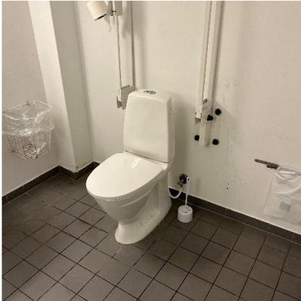
Toilet med to-skyll
