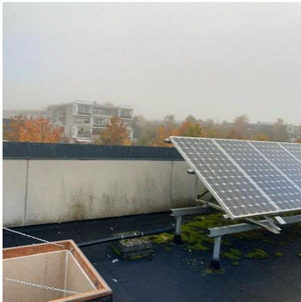
Tagkonstruktion og solcelleanlæg
