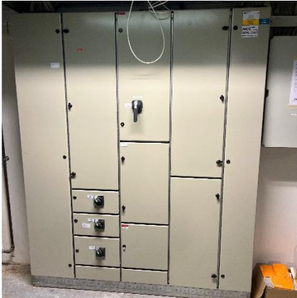
Hovedfordelingstavle i kælder
