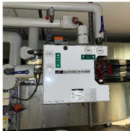
Shunt enhed til ventilation
