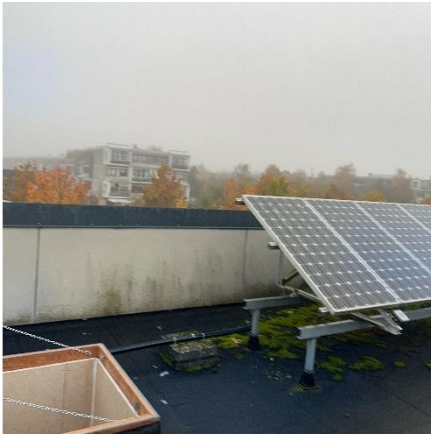
Tagkonstruktion og solcelleanlæg
