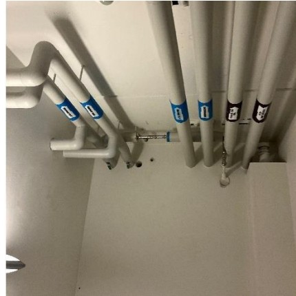
Varme- og brugsvandsrør ført under loft
