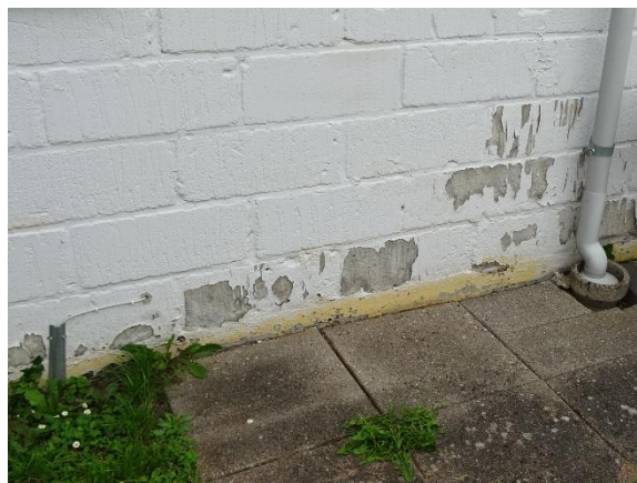
Facader med afskallende maling.
