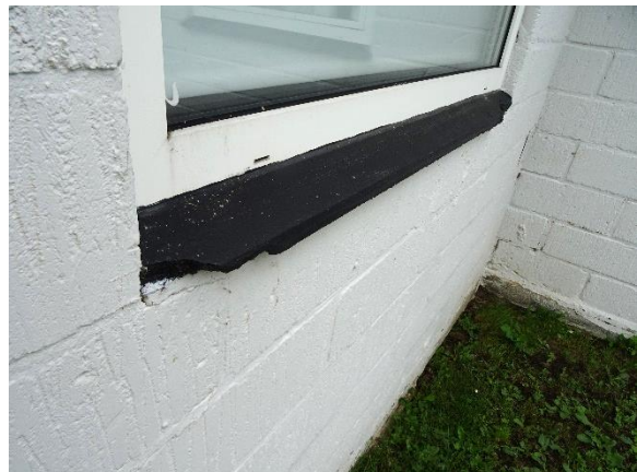
Sølbænk med skader
