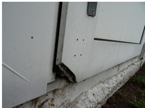
Skadet hjørne på plastdør
