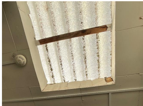
Ovenlys med tegn på fugt i lysning
