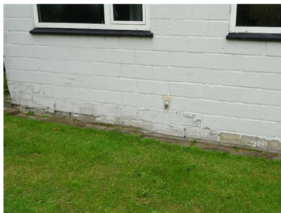
Sokler med afskalning i betonen
