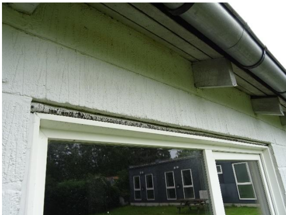
Manglende fuge over vindue med synligt bagstop.
