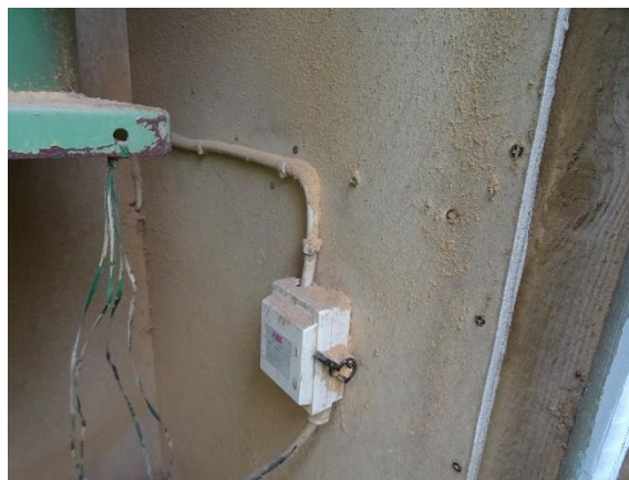
Sikkerhedsafbryder til spånsug uden membran og indhyllet i støv kan medføre brandfare.
