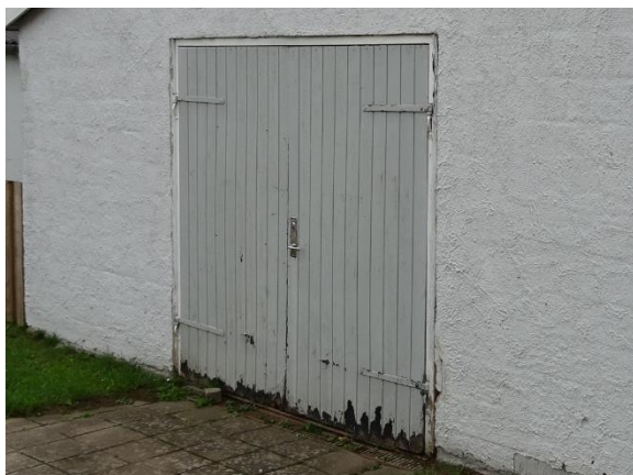
Stalddør i gavl med afskallende maling mod terræn
