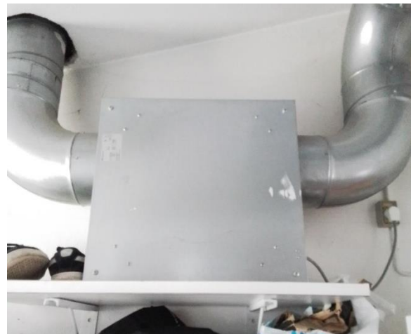
Ventilator i teknikrum
