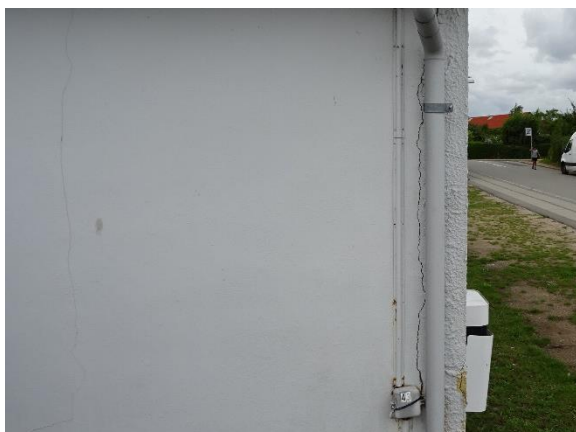
Lodret revne i hjørne bag nedløb mod sydøst.
