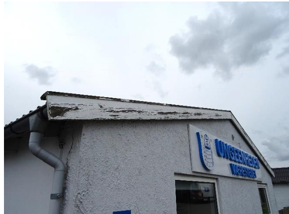
Vindskede og nedløb i plast.
