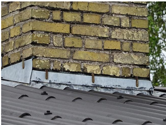
Skorsten med manglende fuger over inddækning
