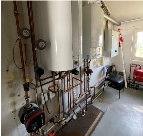
Teknik og Varmtvandsbeholder
