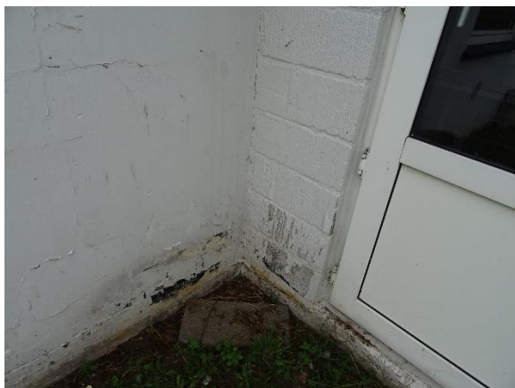
Facader med afskallende maling.
