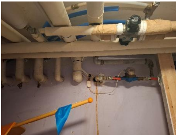
Forsyning til bygning 3, Væksthuset bimåler
