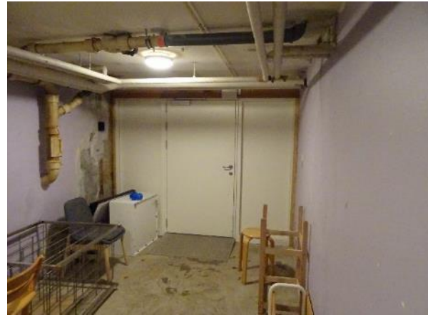
Dårlig stand Installation med bagfald efter nyt gulvafløb er efter monteret.
