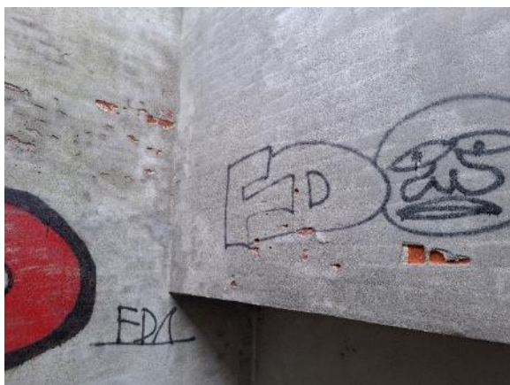
Begyndende afskalninger på pudsede flader
