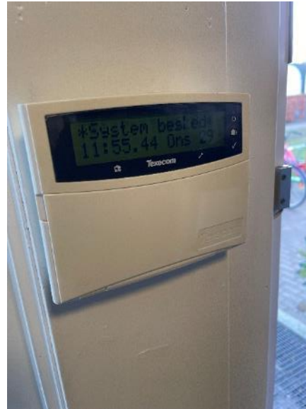
Alarm central ved hoveddøren
