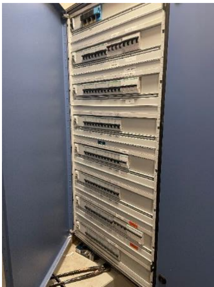
Tavle for den sydlige del af bygningen, med tavlemateriel af nyere årgang. (placeret sydligt i kælderen.
