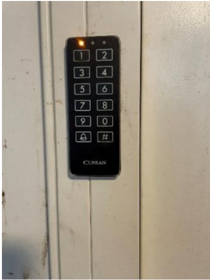
Kodetastatur ved kælder dør mod rampe
