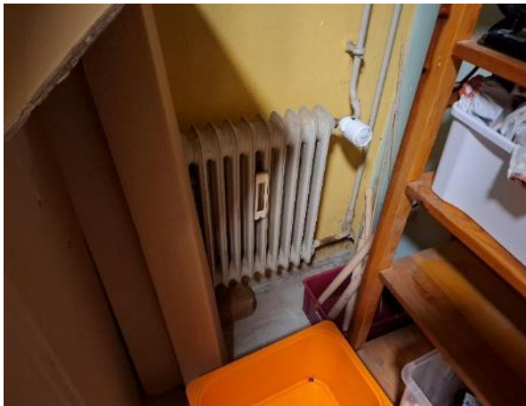
Søjleradiator fra opførelsen
