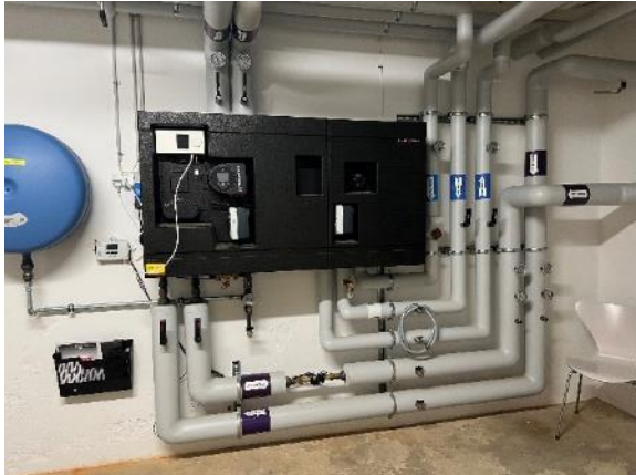
Ny fjernvarme unit med gennemstrøms brugsvand veksler og varme veksler.
