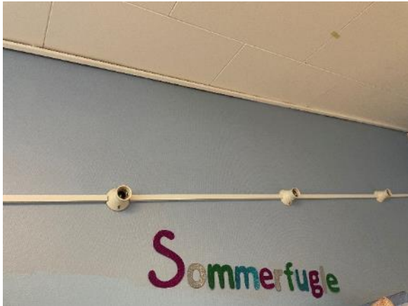
Ubrugte lampeudtag i pudsle/toilet rum, FARE for Elektrisk stød.
