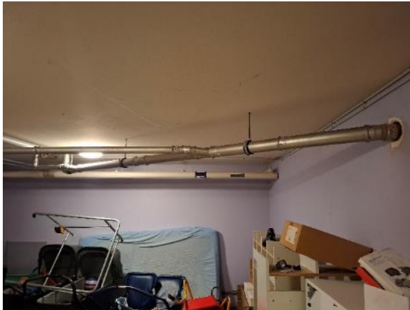
Ny installation Rustfast bøjning er samlingen ikke fuldfør til mufte stop.
