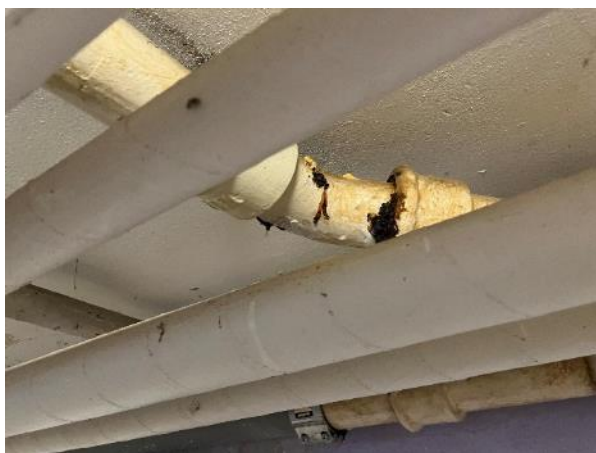
Ud blomstring på original støbejerns rør.
