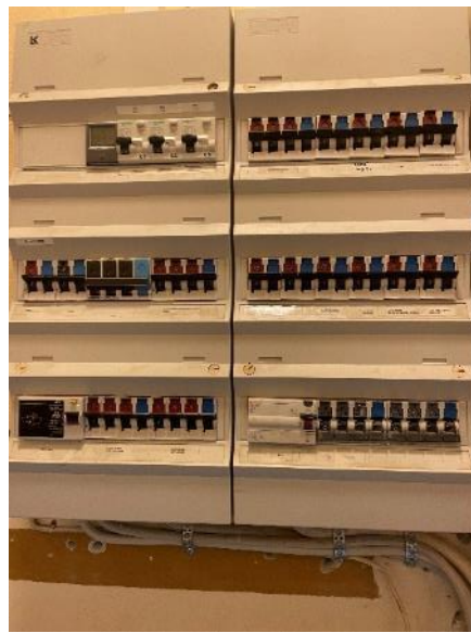
Tavle for den nordlige del af bygningen med tavlemateriel af forskellig årgang. (placeret midt i bygning i WC rum)
