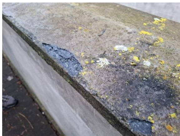
Delaminering af murafdækninger på støttemur
