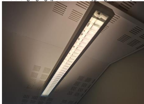
Armaturer med 28 spolerør halo.
