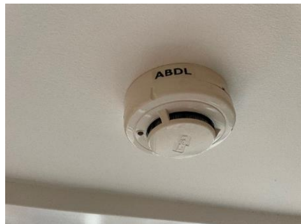
Røg alarm koblet på ABDL
