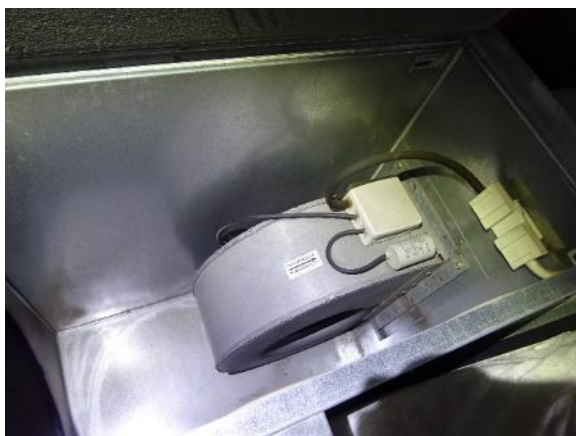
Indblæsningsventilator i aggregat. Centrifugaltype
