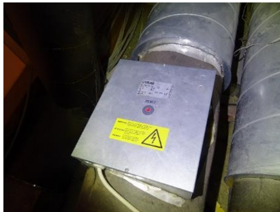
Elvarmefflade på kanal
