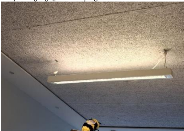
Armatur indbygget med led lyskilde
