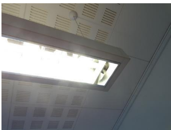
Armatur med konventionelt lysstofrør
