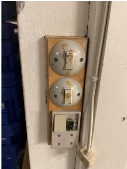
Gammel installations materiale i kældervaskerum
