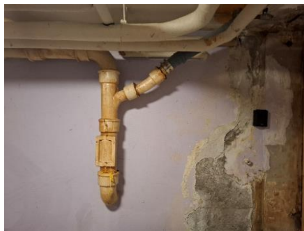
Skadet ved original støbejerns Samle muffe.
