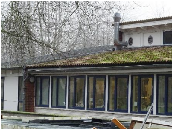
Mosbegrøninger på betontegl
