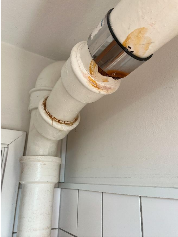
Utætheder/tæringer på afløbsrør
