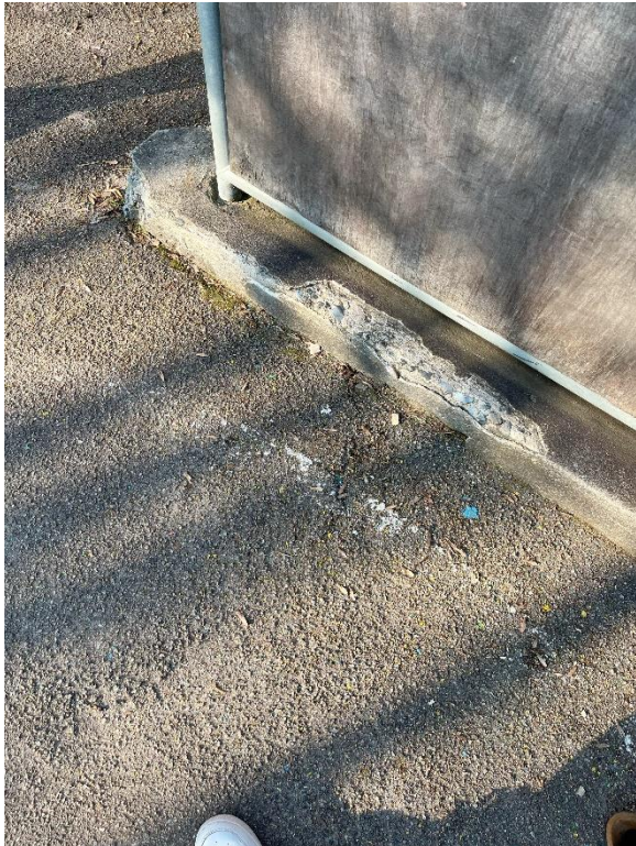
Afslag fra sokkel til kælderhals
