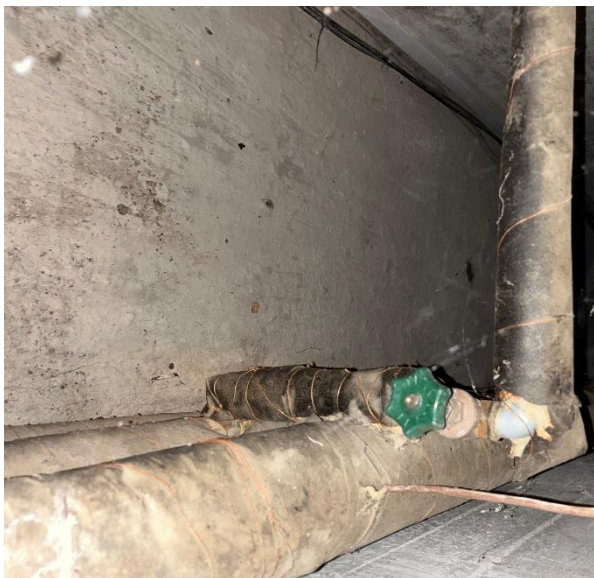
Rør og ventil i rørkanal i kælder.
