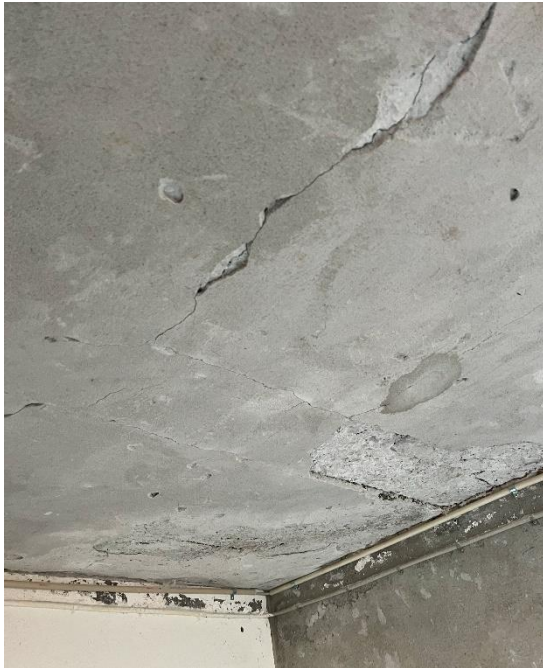
Afskalning af overflader grundet korrosion af armering.
