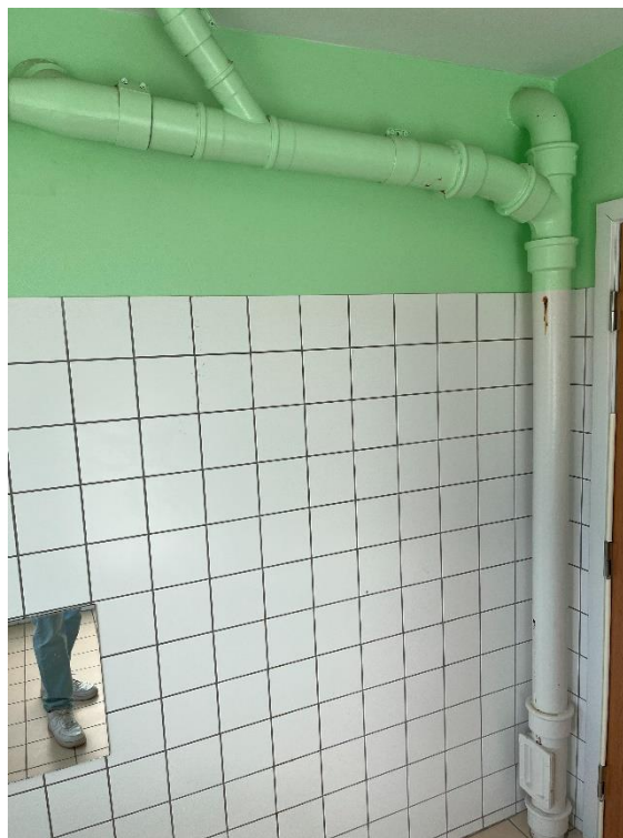
Rust sår på faldstamme
