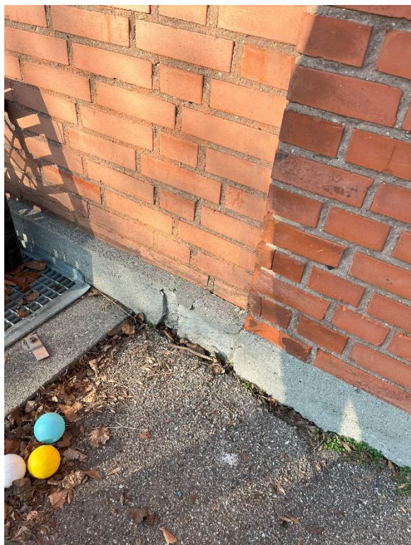
Pudsskade på sokkel
