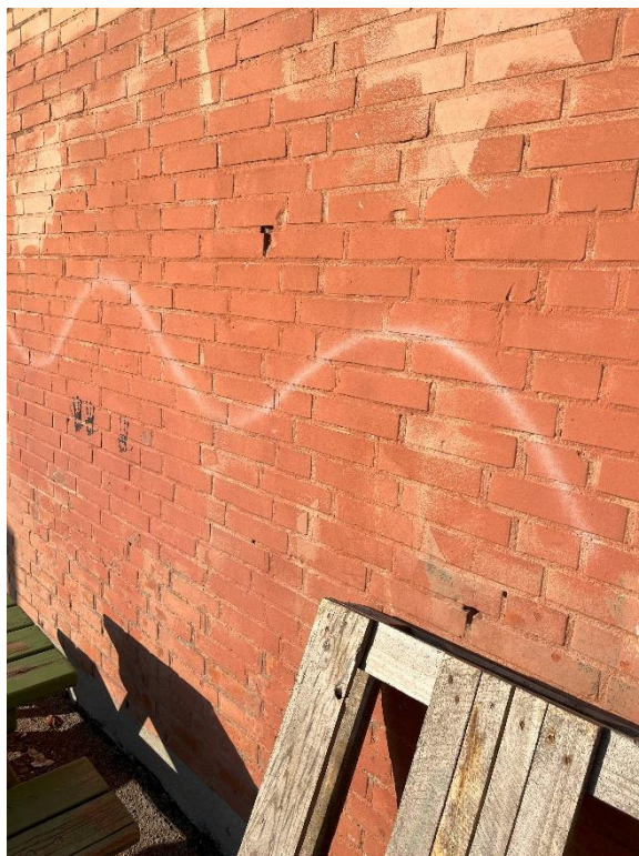
Murværk og teglsten med afslag
