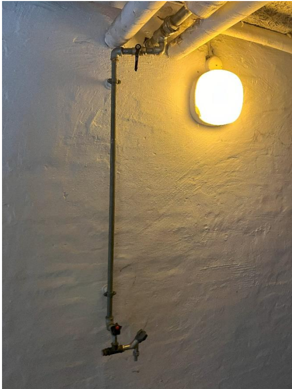
Udendørs hane i kælder
