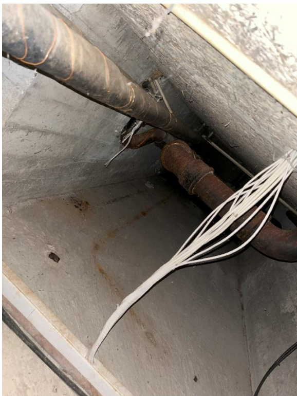
Utætheder/tæring på afløbsrør i rørkanal i kælder
