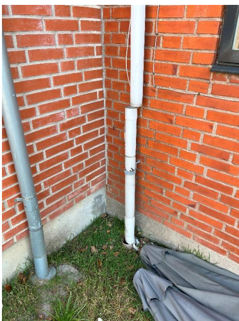
Nedløbsrør i plast, mangler samling og brøndkrave.
