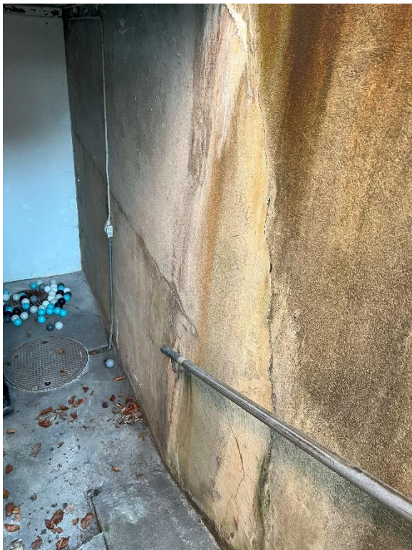
Revnedannelse på baggrund af korrosion i armering.
