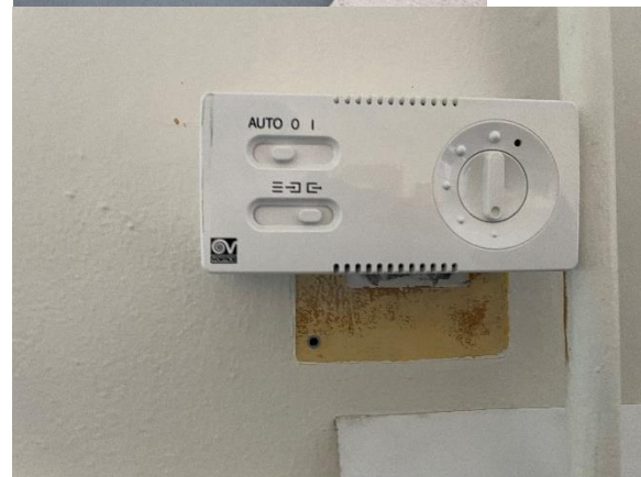
Styringer for vægventilatorer
