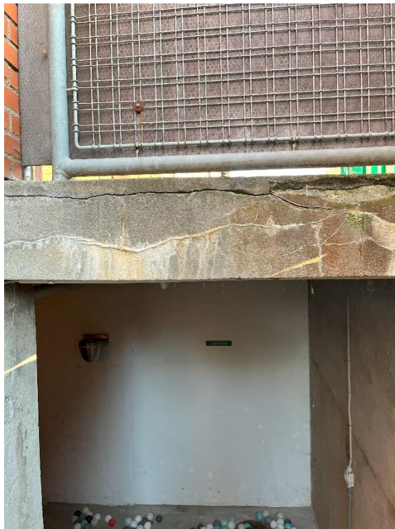
Delaminering/afskalning/revner, årsager er tørsaltning, utæt/manglende topmembran.
