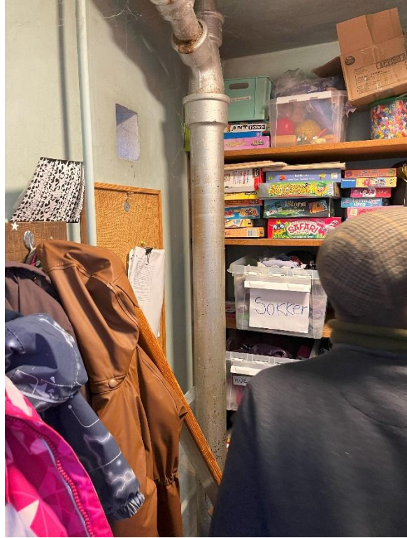
Afløb med blyholdig maling af tæring
