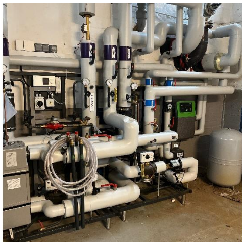
Ny fjernvarme unit
