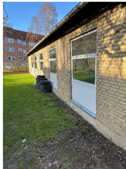
Afskallet puds på sokkel mod sydvest
