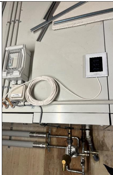
Styring til anlæg
