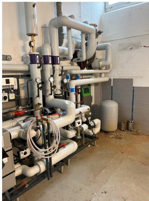
Fjernvarme installation med varmeveksler og vejrkompensering.
