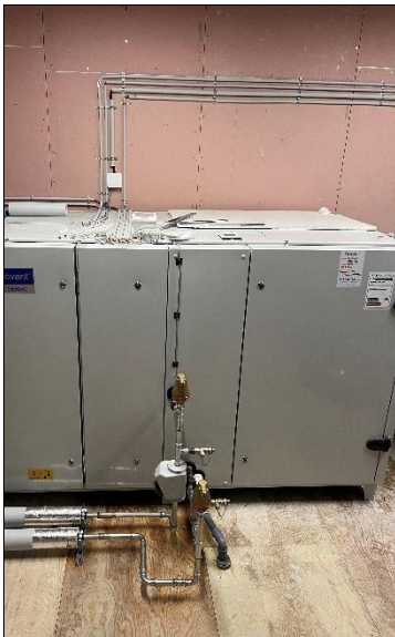
Nyere ventilationsanlæg i tilbygning
