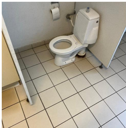
Toilet med et-skyl
