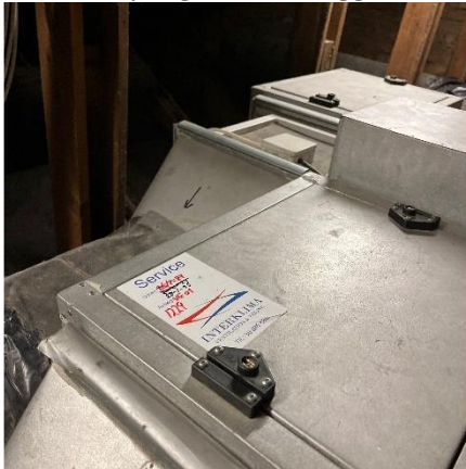
Anlæg over loft i hovedbygning
