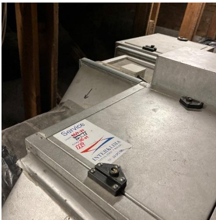
Ældre ventilationsanlæg på loft
