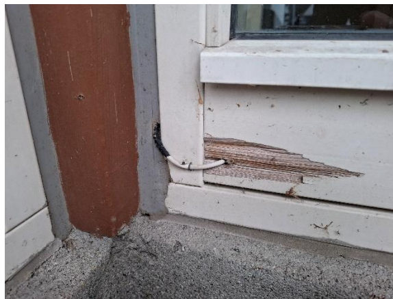
Elastiske fuger mod nord. Gennemføring har beskadiget vindueselement.
