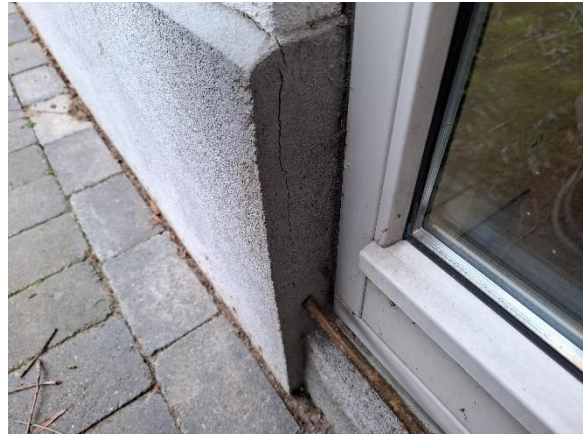
Sokkelpuds har sluppet underlaget flere steder.
