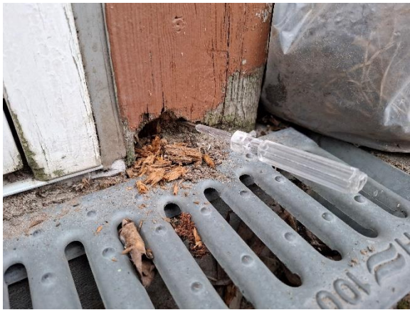
Træsøjler til terræn ved karnap til terrassen mod syd er nedbrudt mod terræn. Søjlerne anbefales udskiftet til uorganisk materiale.
