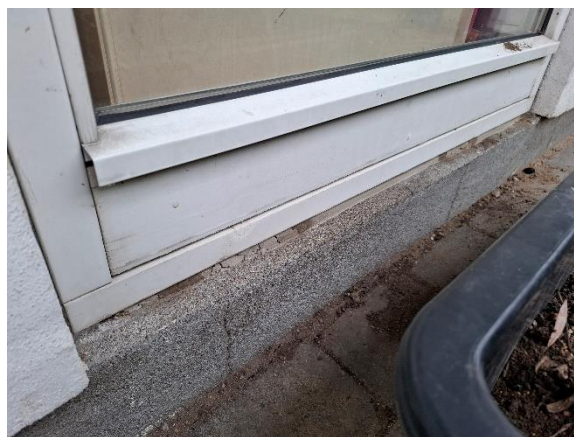
Krakeleret fuge under vindue mod øst
