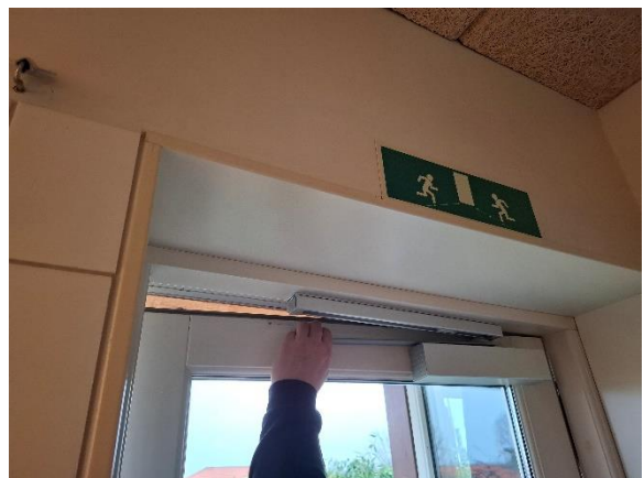
Frakoblet dørpumpe på dør mod øst
