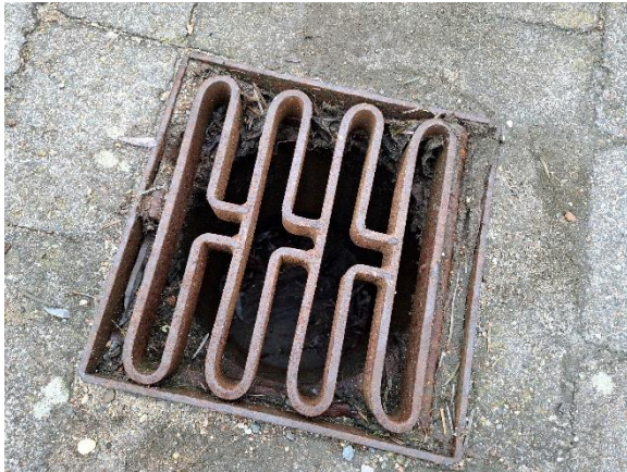
Overfladebrønd m. sandfang – Fyldt med materialer
