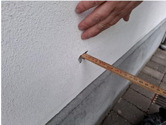
Facade hvor pudsen har sluppet væggen. Pudsen hænger 10 mm ud fra underlaget.
