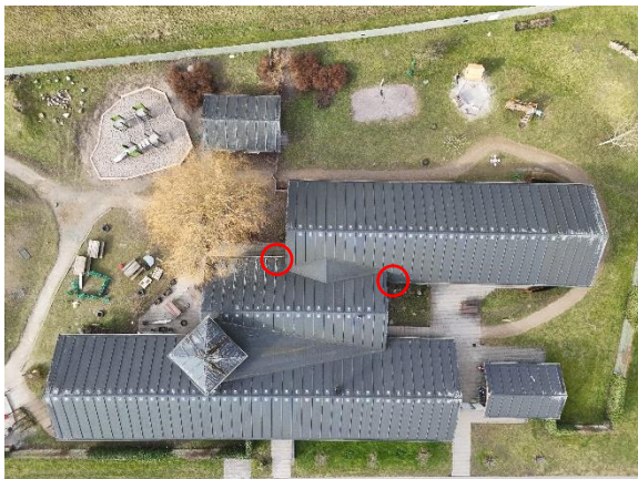
Tagflader. Utætheder observeret ved udløb fra skotrende er markeret med rødt.
