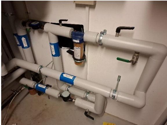
Vandinstallation – Vandmåler og filter
