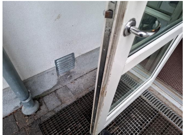
Dør med slidt tætningsliste
