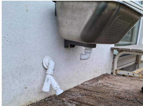
Manglende tilslutning af afløb til udevask.
