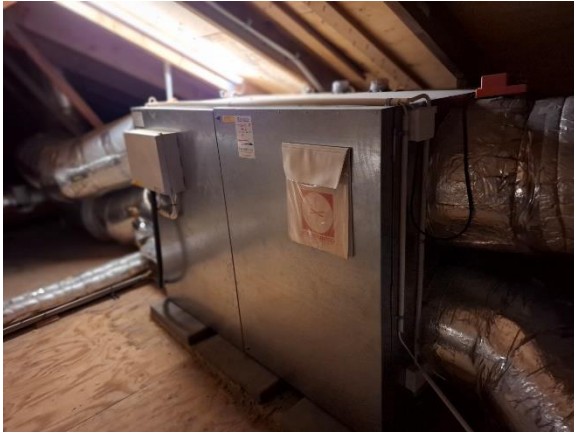
Aggregat med krydsveksler i loftrum
