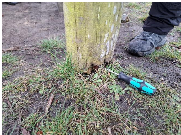
Råd i stolpefødder på overdækning
