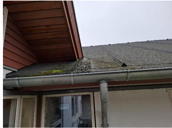
Andet sted med utæthed i samling ved udløb fra skotrende.
