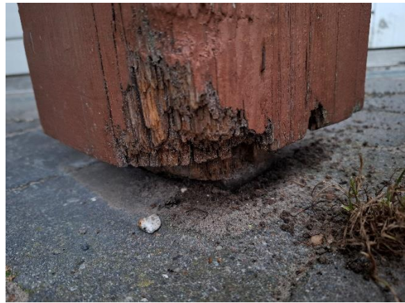
Søjler ved tagets overdækning mod syd fremstår med nedbrud i søjlefødder.
