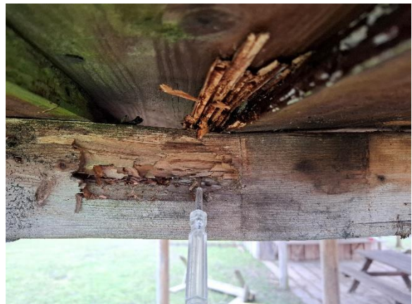
Overdækning – Meget svækket grundet råd
