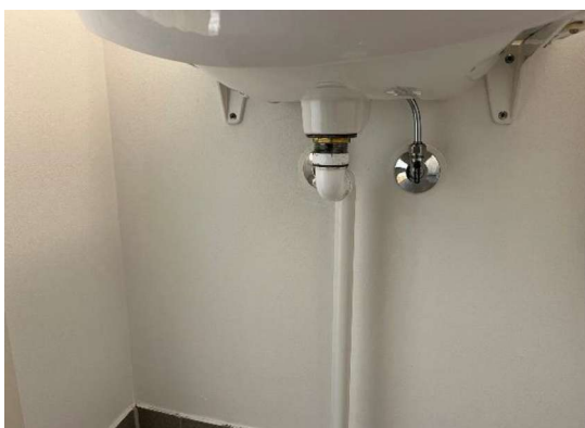
Afløb i plast under håndvask
