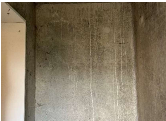
D: Kældervæg ved kældertrappe, bygning 12
