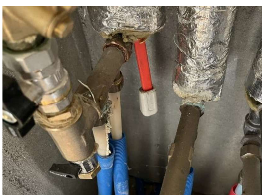
Rørinstallationer i teknikskab, utætheder.
