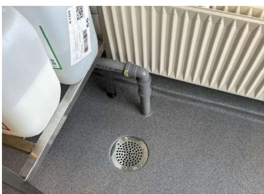
Gulvafløb i vinylgulv, vaskeri
