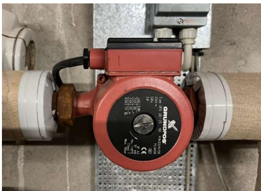
Cirkulationspumpe til ventilationsvarmefflade
