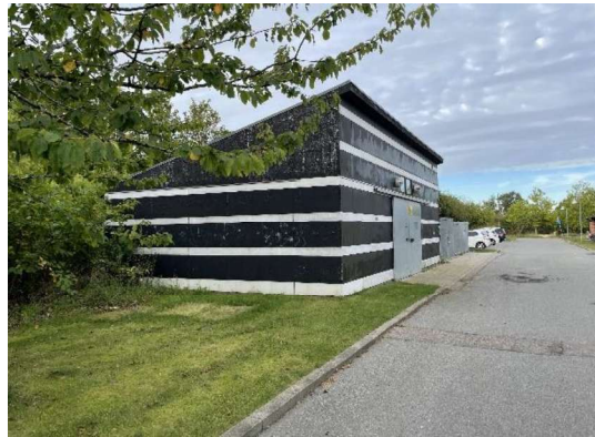
Slidte facadeplader på maskinhus
