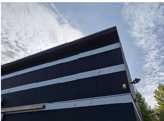
Løs facadeplade på maskinhus
