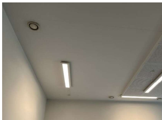
Armaturer for udsugning i loft, vaskeri
