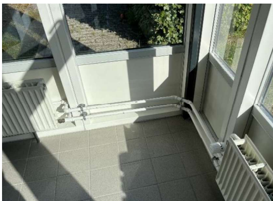
Centralvarmerør og radiatorer.
