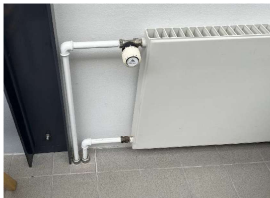
Radiator på væg
