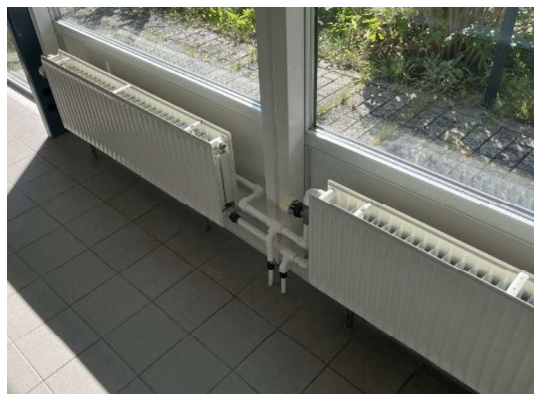
Centralvarmerør og radiatorer.
