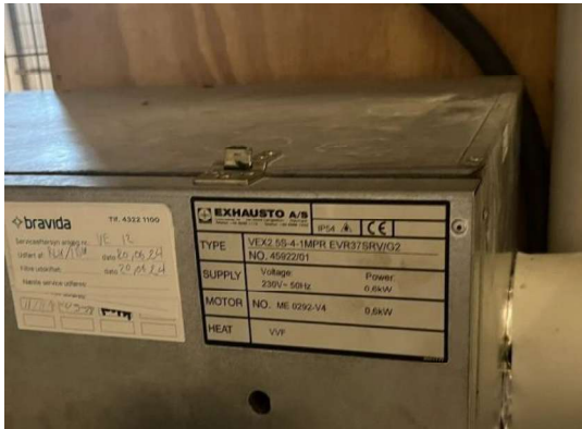
Ventilationsanlæg i kælder, VEX2 med varmegenvinding
