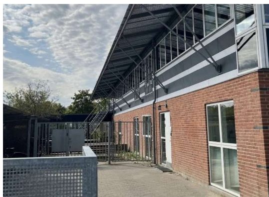
Tagnedløb ved facade
