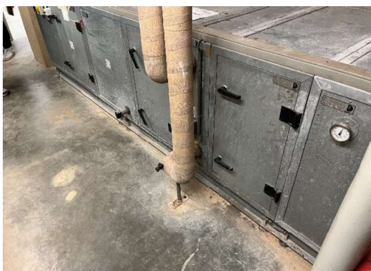
Ventilationsaggregat med varmegenvinding og varmeplade
