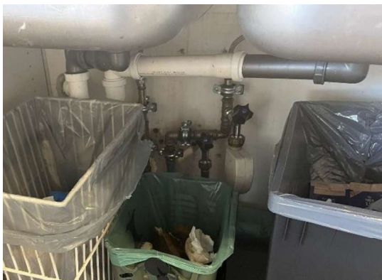
Afløb i plast under køkkenvask i fælleskøkken.
