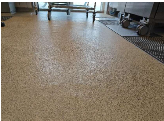
Buler i gulvbelægning
