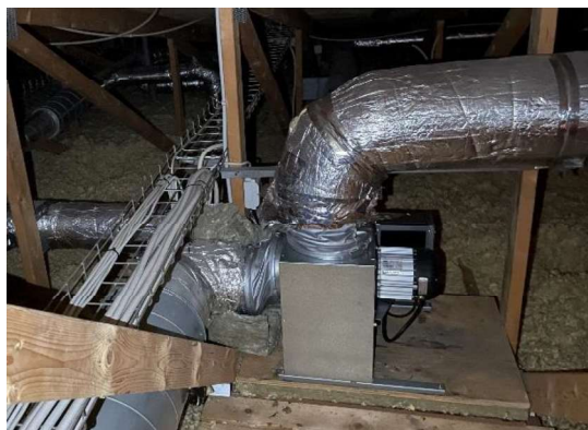
Ventilationskanaler og ventilator i tagrum
