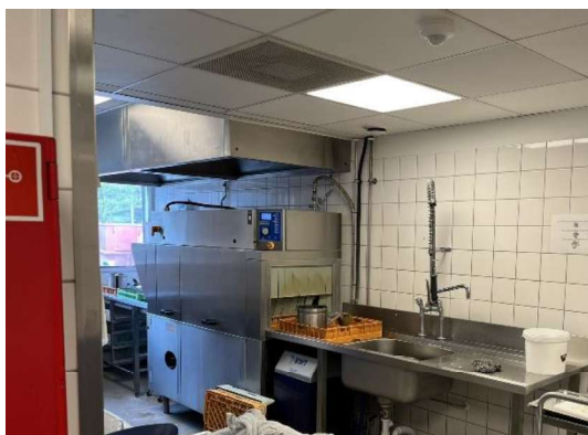
Emfang og udsugning i storkøkken
