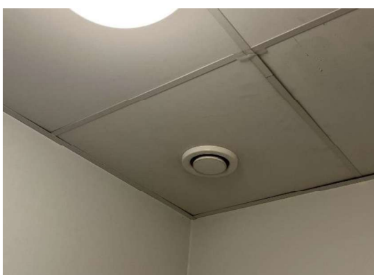
Armaturl for udsugning i loft
