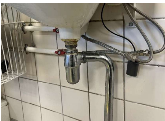
Afløb fra håndvask i forkrømede messingrør
