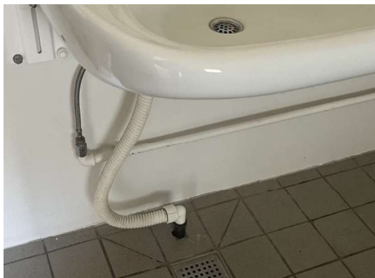
Afløb i plast fra håndvask i bolig.
