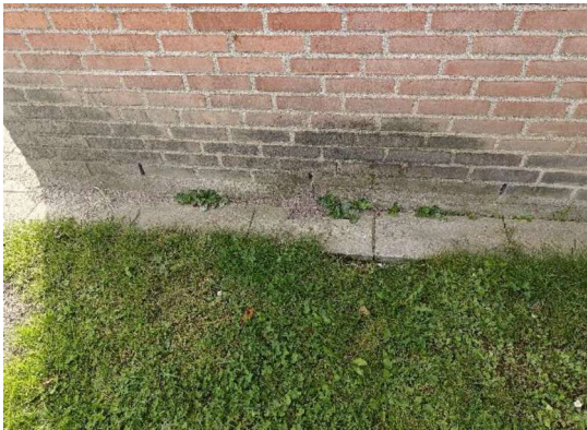
Studsuge med opfugtning af omkringliggende murværk
