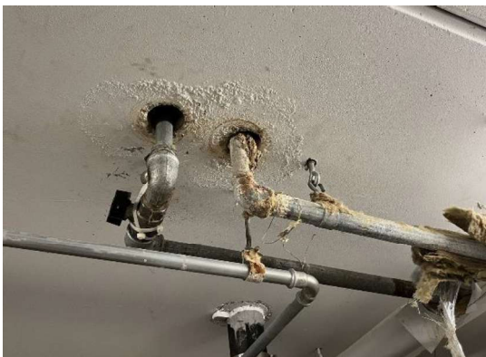
Vandrør under loft kælder, punktvís udskiftning og tæring.
