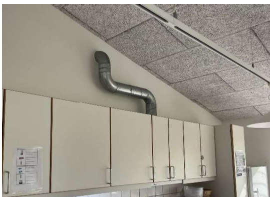
Kanaler fra emhætte i køkken
