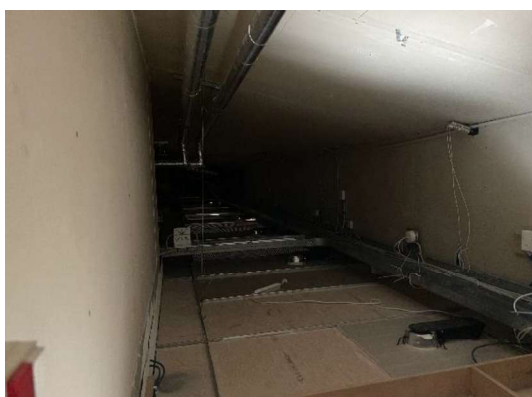
Loftsrum med installationer
