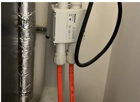
El-frostsikring af vandrør
