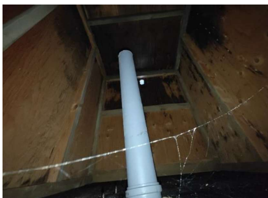
Taggennemføring mangler på faldstammeudluftning
