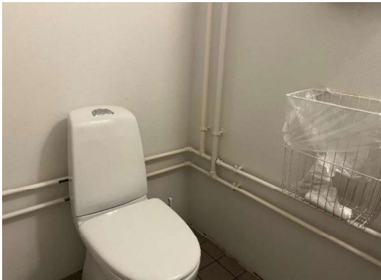
Synlige vandrør på væg i galvaniseret stål
