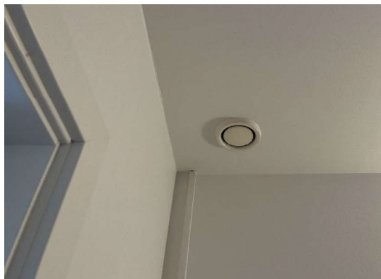
Armatur for udsugning i toilet/bad.
