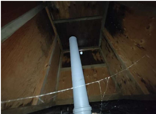
Tagrum over vaskeri med faldstammeudluftning og opfugtet træværk, grundet kondens.
