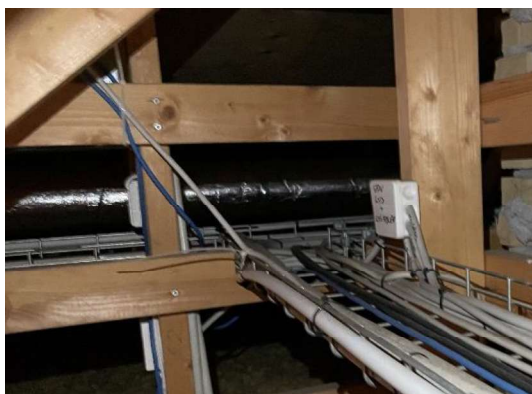
Vandrør i tagrum.
