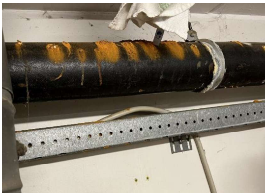
Afløbsrør under loft i kælder, gennemtæret
