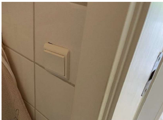
Løstsiddende afbryder i boligbadeværelse
