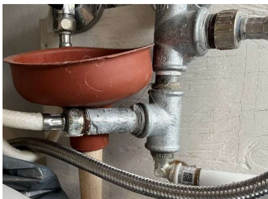
Synlige vandrør i galvaniserede stålør, med begyndende rust på gevind
