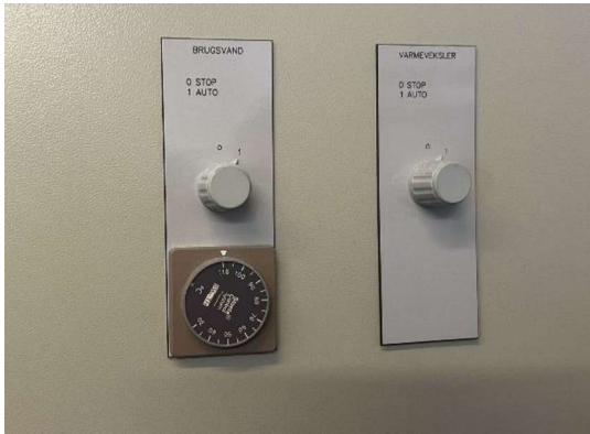
Oprindeligt styrepanel til centralvarme og varmt brugsvand, termometer er defekt.
