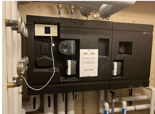
Ny komplet varmecentral (fjernvarmeunit) inkl. automatik og cirkulationspumper i en af bygningerne.
