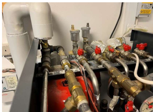
Top på fjernvarmeunit med tilslutninger og automatudluftere
