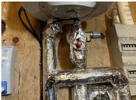
Isolerede vandrør under varmtvandsbeholder i maskingarage
