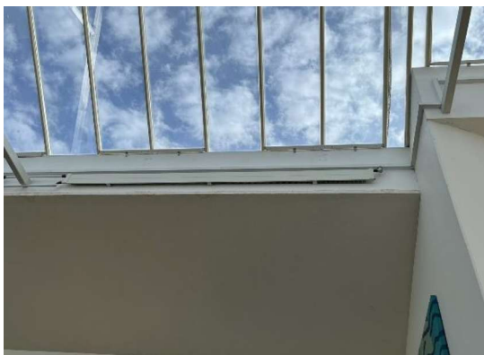
Konvektor under loft i atrium
