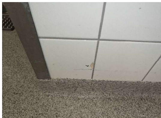
Flise med skade
