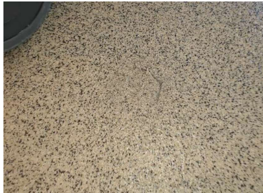
Revne i gulvbelægning
