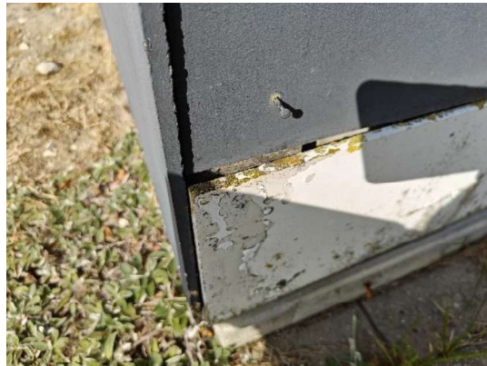
Facadeplade med afskallet maling bygning 12, løse skruer.
