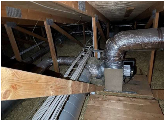
Hovedføringsvej på tekniketagen.
