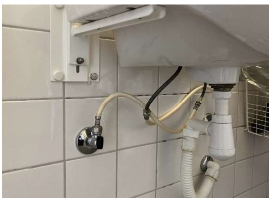
Koblingsdåser fra pex-rør til håndvask.
