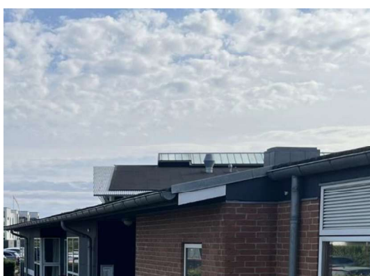
Taggennemføringer for ventilation
