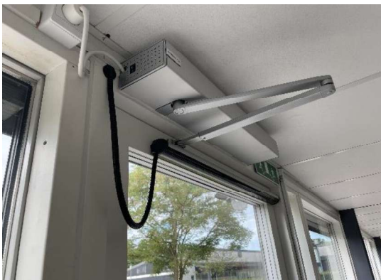
Dørpumpe på dør
