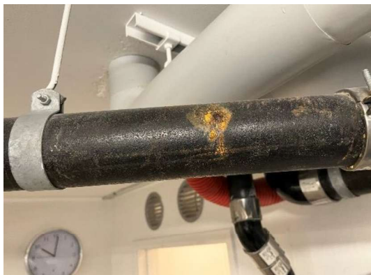
Afløbsrør under loft i kælder, gennemtæret
