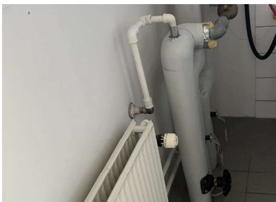
Vandstik og rørføring til udendørshane.
