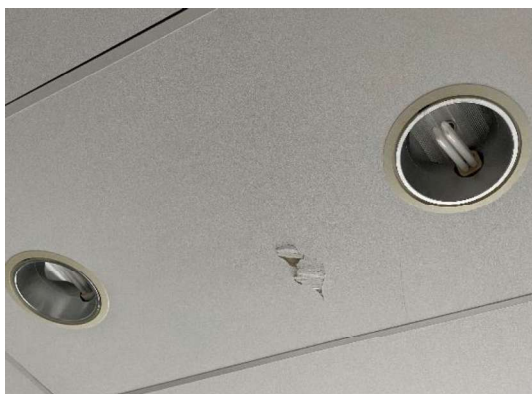
Ældre belysningsarmaturer med lysstofrør.
