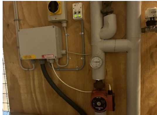
Automatik m.m. for ventilationsaggregat i kælder.
