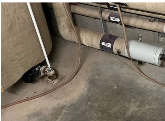
Gulvafløb ved varmtvandsbeholder i varmecentral
