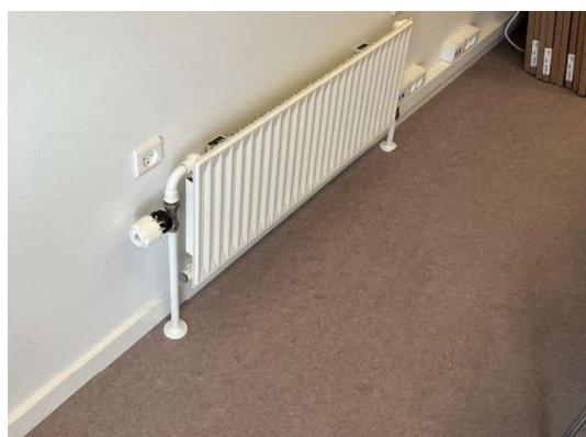
Radiator på væg
