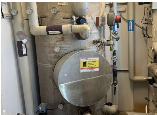
Oprindelig varmecentral med varmtvandsbeholder og rørinstallationer.
