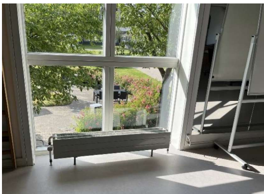
Konvektor på gulvbæring
