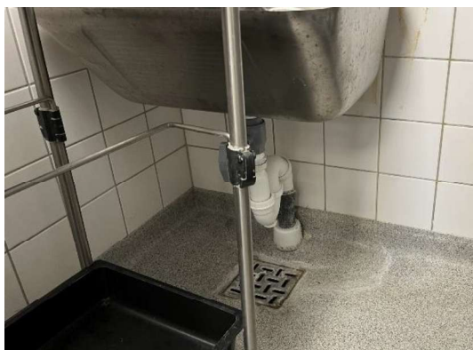
Afløb i plast fra rengøringsvask ført til gulvafløb
