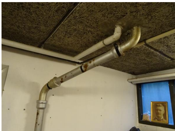
Faldstamme i kælder med flere tæring
