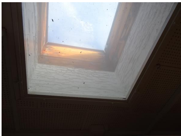
Ovenlyskuppe med fugtskjolder og sprækket maling i lysning
