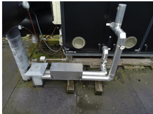
Varmeforsyning anlæg på sydlig bygning
