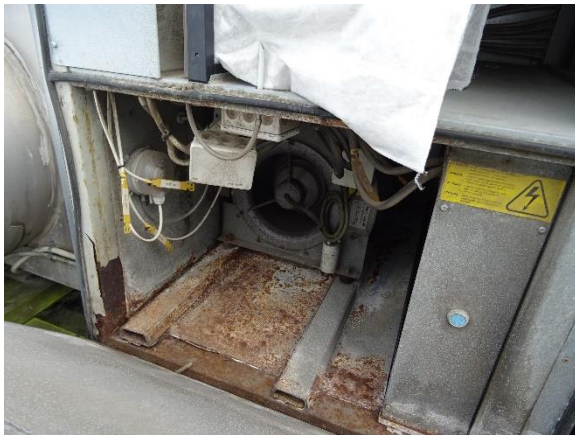
Ventilationsanlæg med gamle ventilatorer
