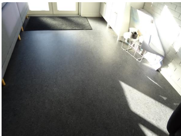
Få år gamle gulv i midter bygning
