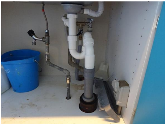
Rør under vask i galvaniseret stål
