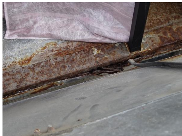
Anlæg er tæret op i bunden
