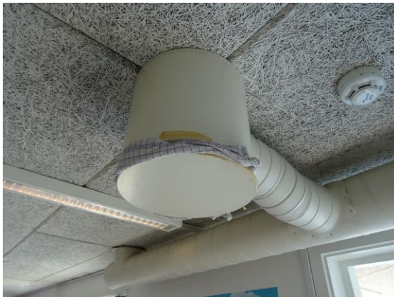
Armatur blokeret med viskestykke
