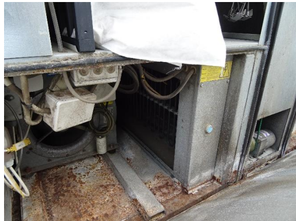
Elvarmeblade i anlæg
