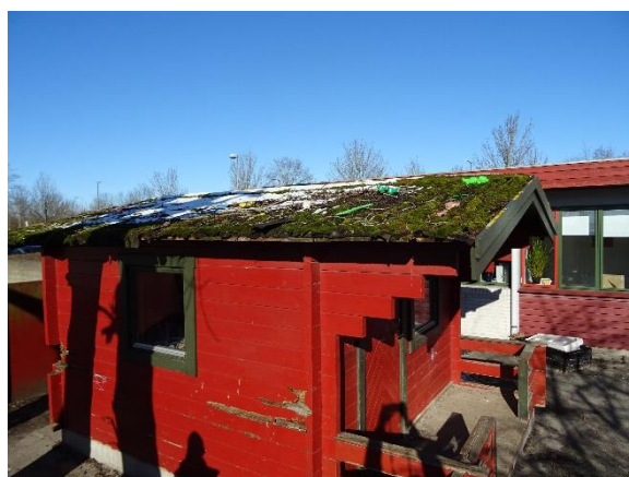
Bjælkehytte med nedslidt tag og træværk
