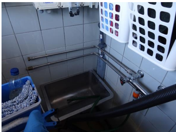
Rustfri installation med døde ender i rengøringsrum
