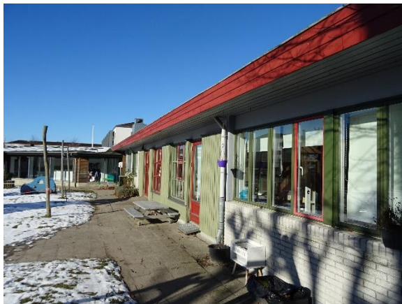
Træ/alu vinduer mod syd
