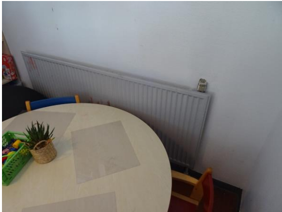
Oprindelig radiator og ventil
