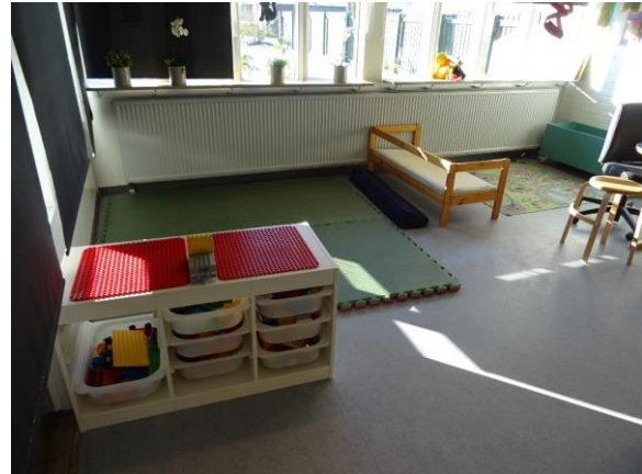
Nyere radiator på stue
