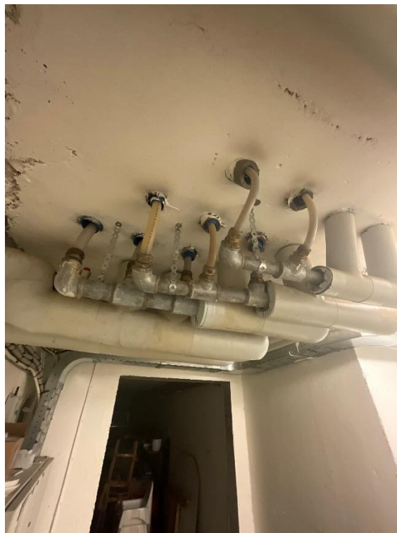
Vandfordeling i kælder, galvaniserede rør
