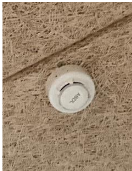
Røg alarm koblet på ABDL
