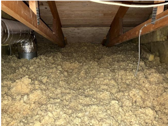
Mineraluldsgranulat på ventilationsloft
