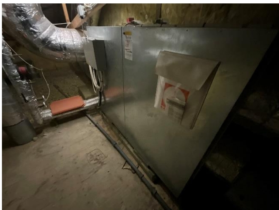
Aggregat og kanaler på loft
