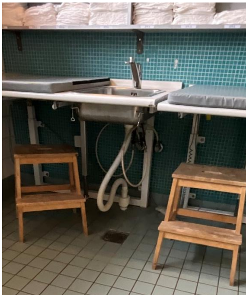
Bord med hævesænke funktion og Flex rør
