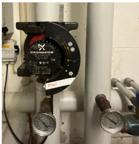
Centralvarmeanlæg cirkulations Pumpe
