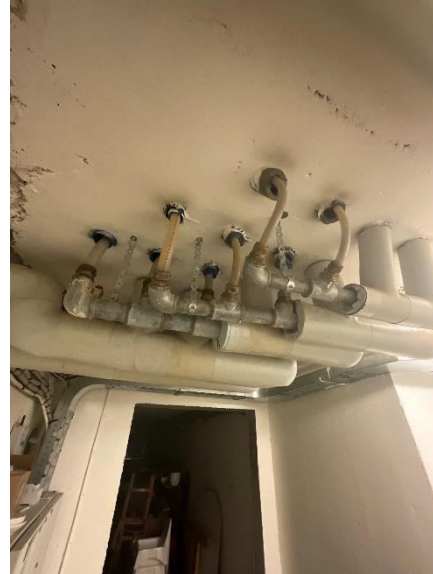
Tekniske lukninger i dækket
