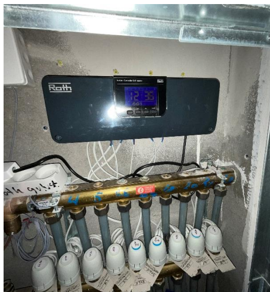
Gulvvarme fordeler af 3 stk.
