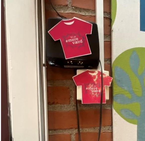
Rumføler dækket med opslag
