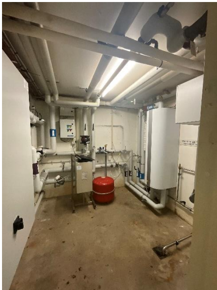
Teknik rum for varmt brugsvand vand
