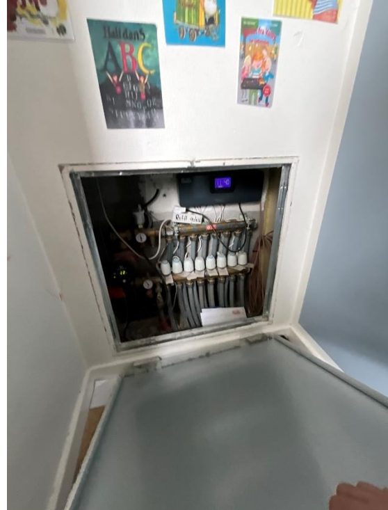
Gulvvarmefordeling og nyere styring
