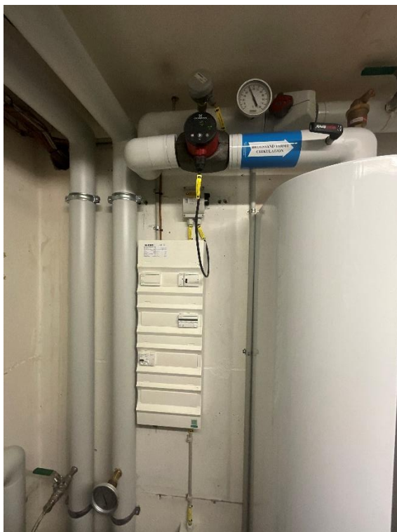
Tavle i varmecentral
