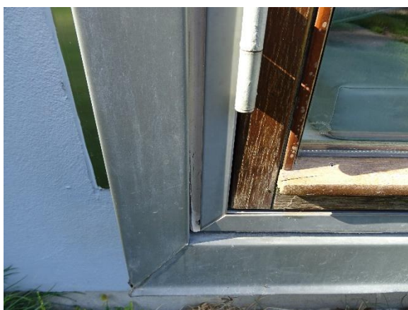
Sydvendte vinduer, trærammen bliver nedbrudt uden overfladebehandling
