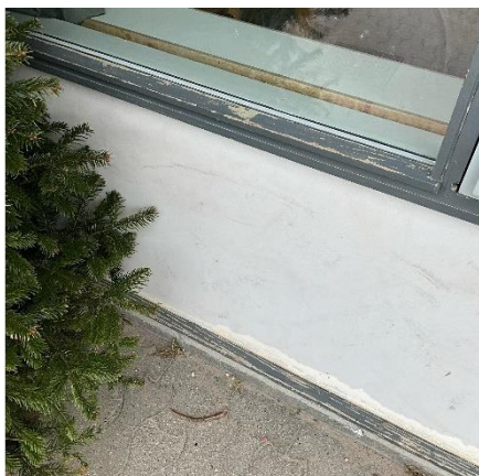
Let facade med afskallet maling
