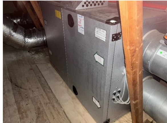
Ventilationsanlæg hovedbygning og liggehal
