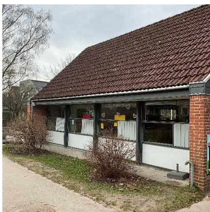
Mosbegrøning på hovedbygning
