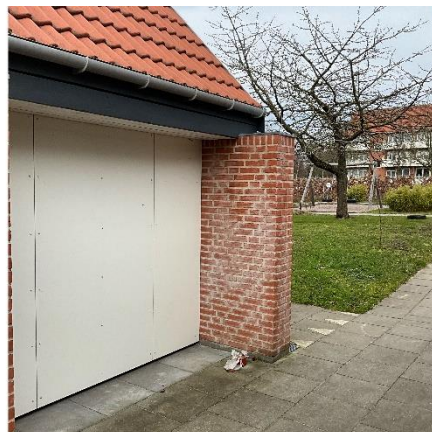
Fritliggende rør forbeholdt tagnedløb stikker op
