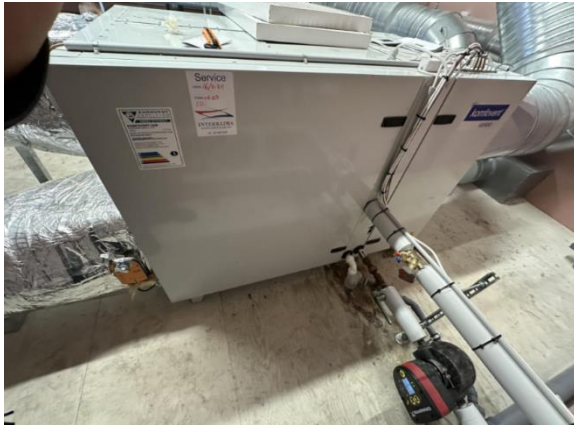
Ventilationsanlæg ny tilbygning
