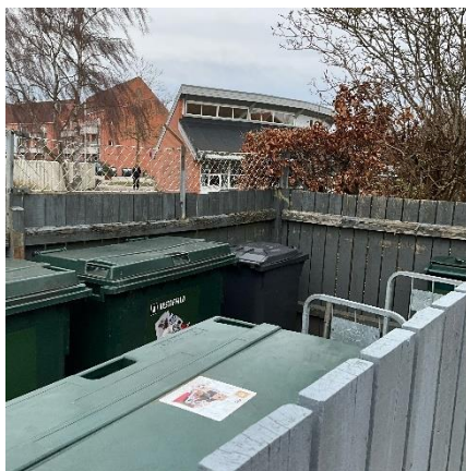
Nedbrudt træværk i affaldsø
