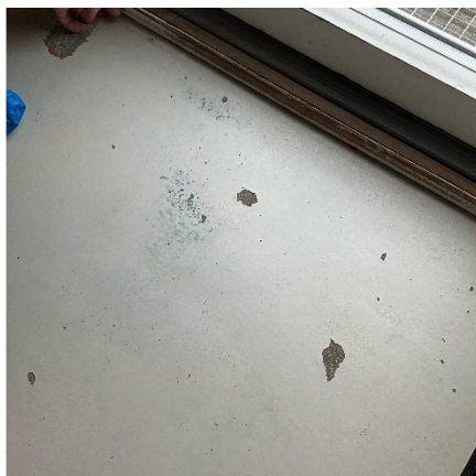
Afskallet maling på epoxygulv
