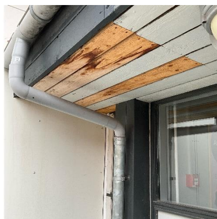
Manglende maling i tagudhæng hovedbygning
