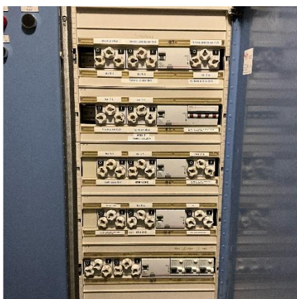
Smeltesikringer, relæer mv. i fordelingstavle
