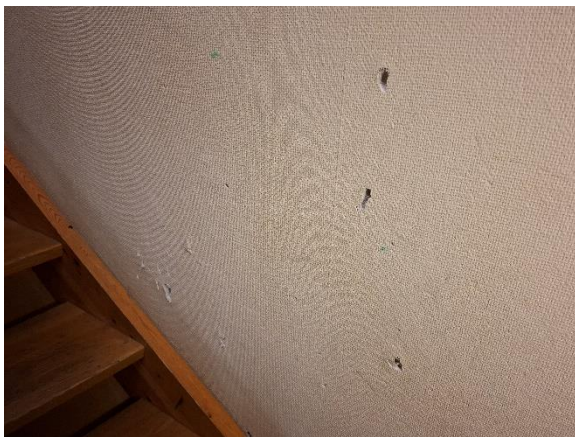
Skader på væg ved kældertrappe
