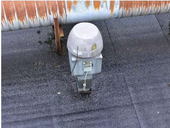
Ventilator til køkken
