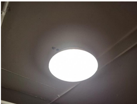
LED armatur i kælder
