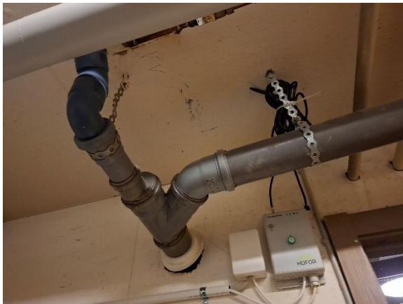
Afløbsinstallation i plast
