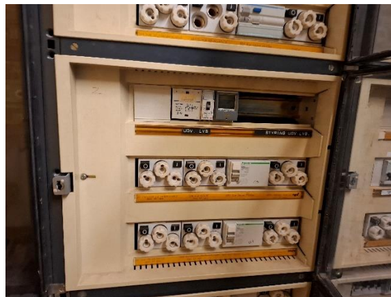
Manglende afdækning i tavle
