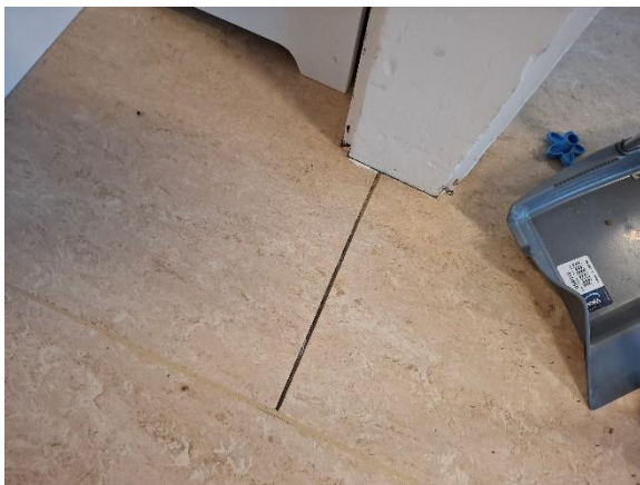
Manglende svejsning linoleumsgulv
