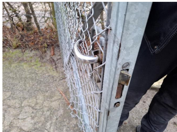
Defekt låsekasse på låge mod syd
