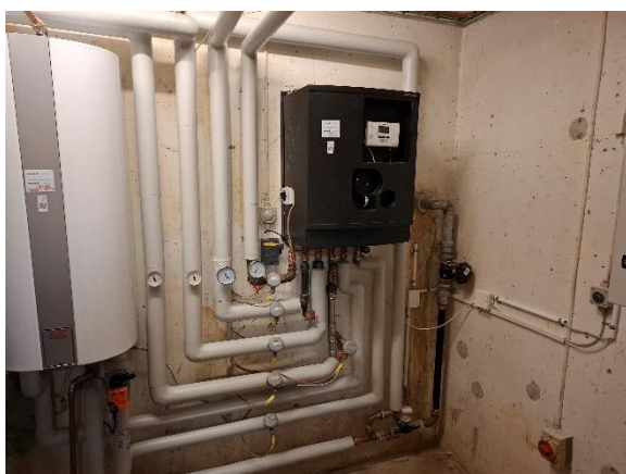
Varmeanlæg i kælder
