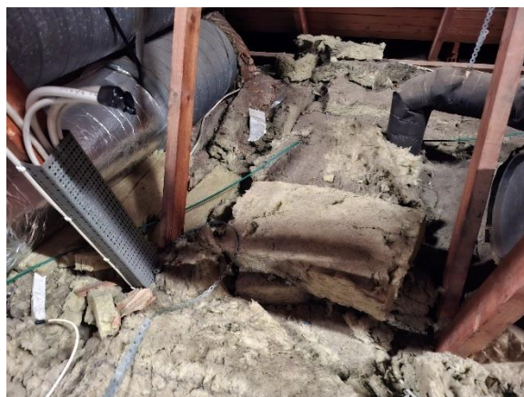
Isolering ligger ujævnt i tagrum blandet med byggeaffald
