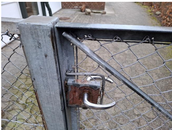
Defekt låsekasse på låge mod syd
