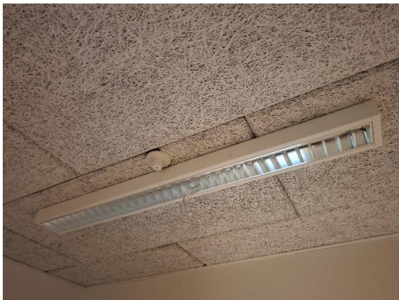
Armatur i stueetagen
