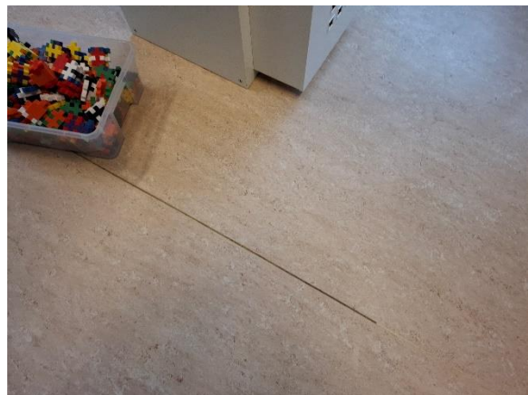
Manglende svejsning linoleumsgulv
