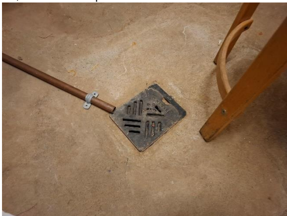
Gulvafløb med højvandslukke i varmecentral i kælder
