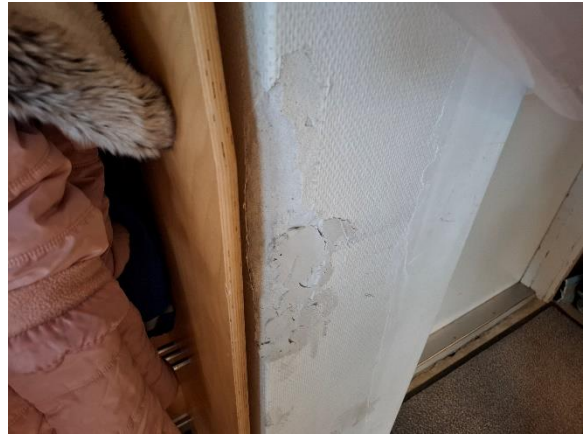
Skader på væg i barnevognsrum
