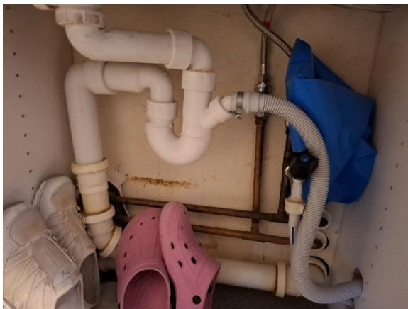
Brugsvandsinstallation i rengøringsrum
