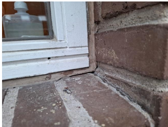
Fugeslip ved fast parti i toiletrum
