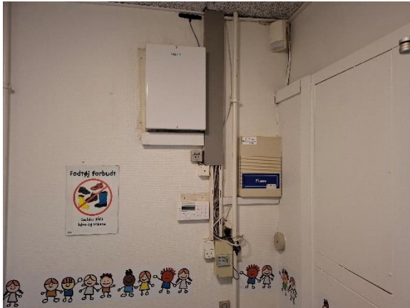
Indbrudsalarm vindfang mod nord
