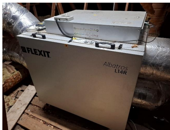
Anlæg 2 - Flexit. Rotorveksler
