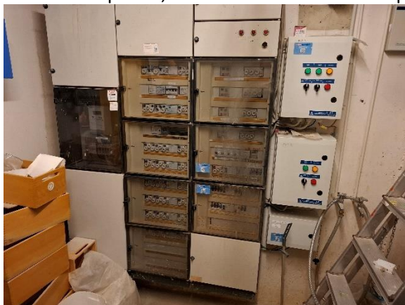
Tavler og styretavler for drænpumper i kælder
