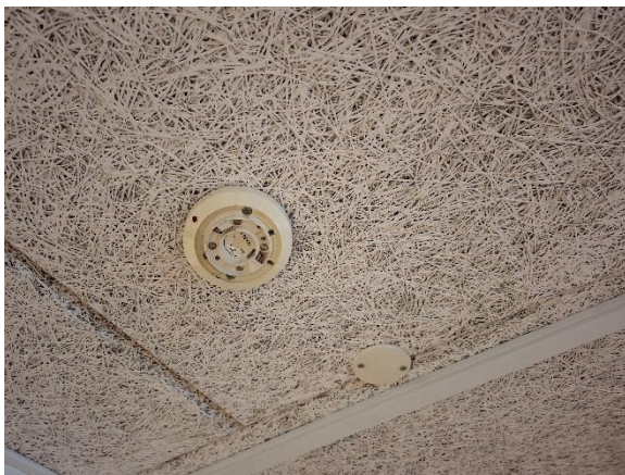
Underlag for montering af røgalarm. Røgalarm mangler.
