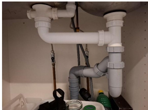
Brugsvandsinstallation i anretterkøkken
