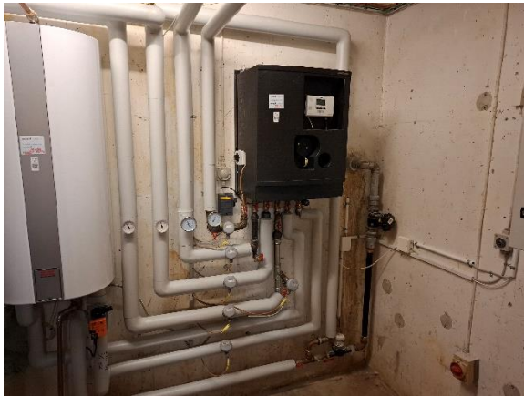
Fjernvarme unit fra 2020
