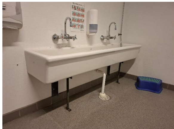
Sanitære forhold i toiletrum for børnene
