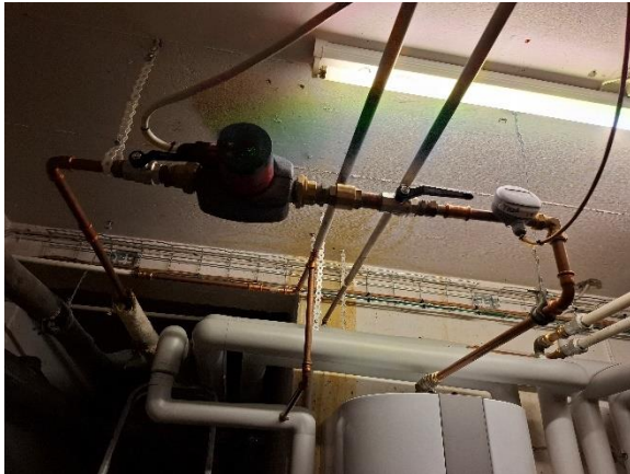
Brugsvandsinstallation med manglende isolering i varmecentral.
