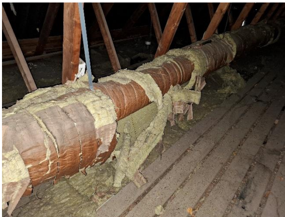
Ventilationskanaler i lofttrum, mangelfuld isolering
