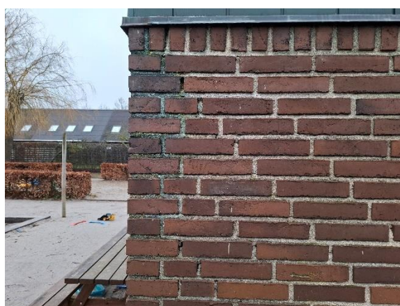
Mangelfulde fuger i murede facader
