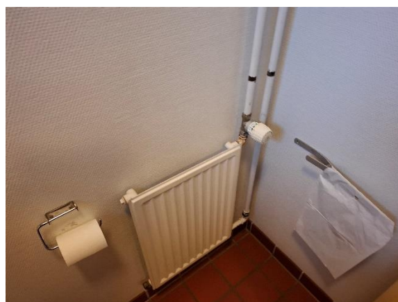
Radiator i stuen med termostat
