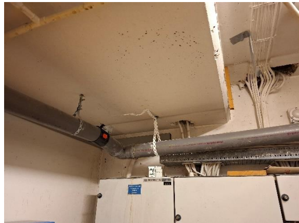
Afløbsinstallation i plast
