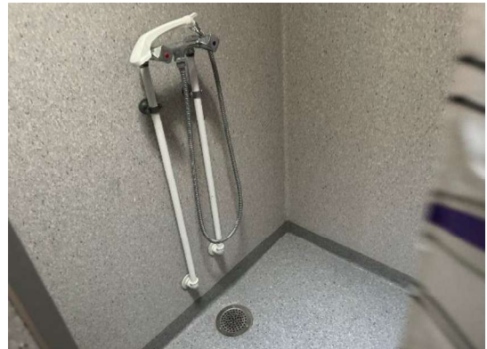
Gulvafløb i bruserum.
