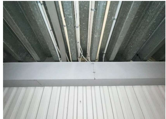
Der er mange forskellige føringsveje i hallen, her et af de pænere steder, med installationerne skruet fast i loftet.
