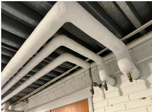
Rørføring med ældre isolering (formentlig kiselgur)
