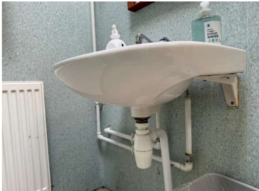
Afløb under vask udført i plast.
