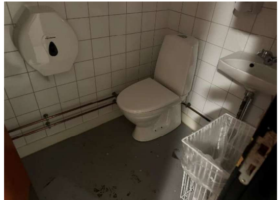
Koblingsledninger udført i kobber
