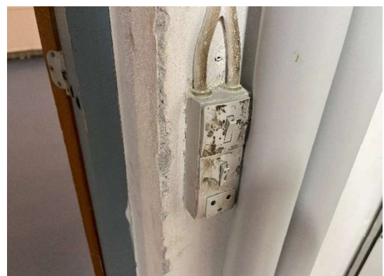
Der anvendes stadig gamle minitangent afbrydere og stikkontakter i hallen.
