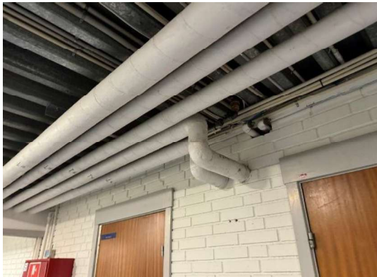
Hovedledninger i gangområdet, muligvis med asbest / kiselgur.
