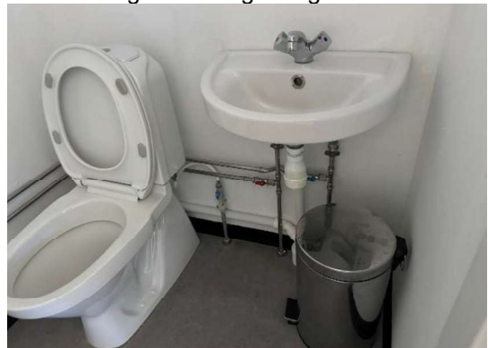
Koblingsledninger på toiletet udført i rustfrie stålrør med pressfittings
