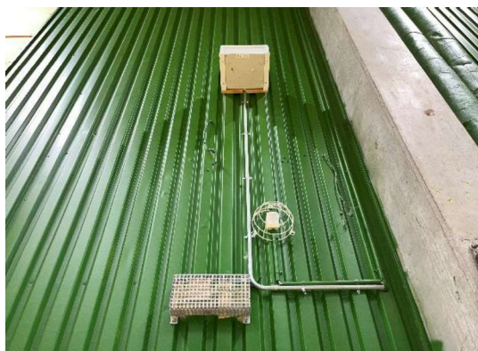
Der hænger løse installationer flere steder i hallen.
