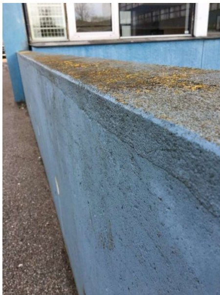
Vange mod lysgård nedbrudt, med mange revner og afskalninger.
