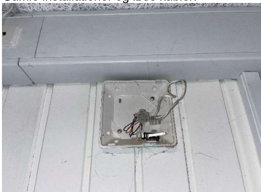
Der er løse installationer, som ikke er blevet demonteret. Der er ikke berøringsfare, da det er svagstrøm.
