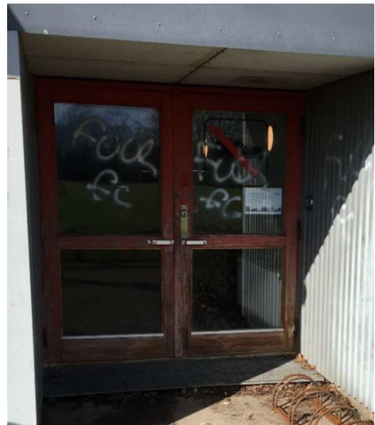
Indgangsdør meget slidt
