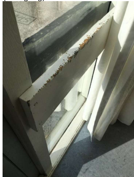
Stort slid på vinduer indvendigt
