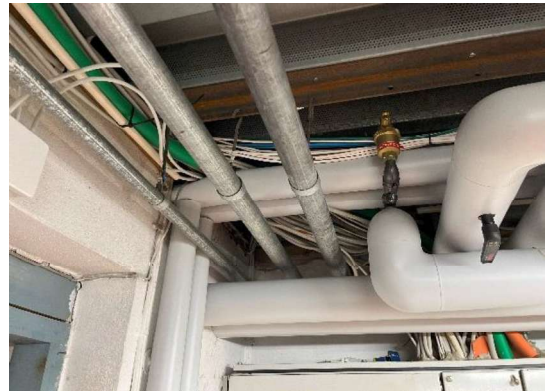
Der er generelt mangler på føringsveje i hallen.
