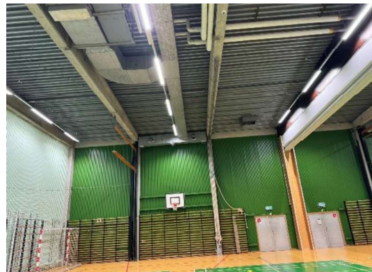
Ventilationssystem i loftet i hallen.
