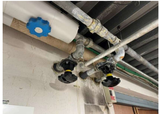
Rørføring med nyere isolering og begyndende tæring.
