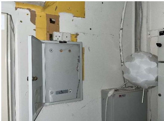
Gamle installationer og løse kabler.
