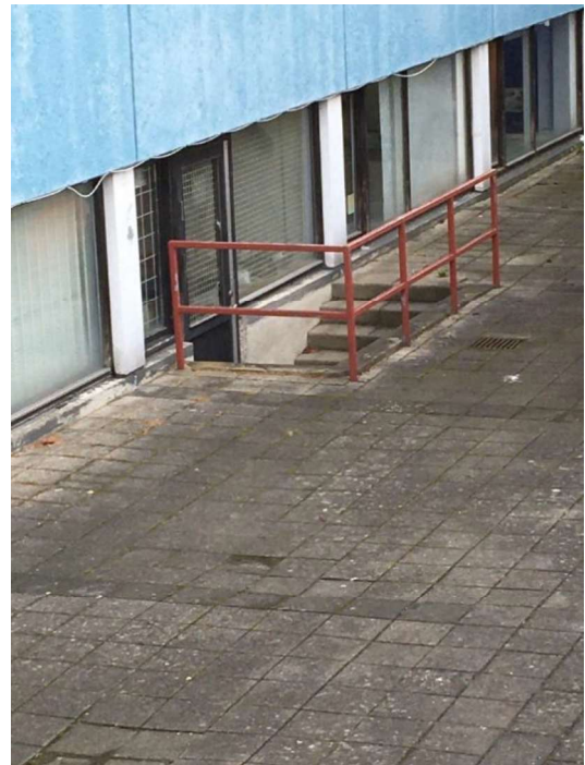
Udv. betontrappe, meget slidt.
