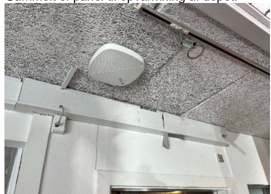
Installationskanal med defekt låg under loft, som er tilpasset af flere omgange. Samt halogenspot på lysskinne, uden lyskilde.
