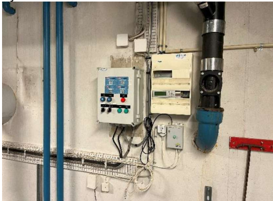
Styretavle og UG-tavle med manglende afdækning.
