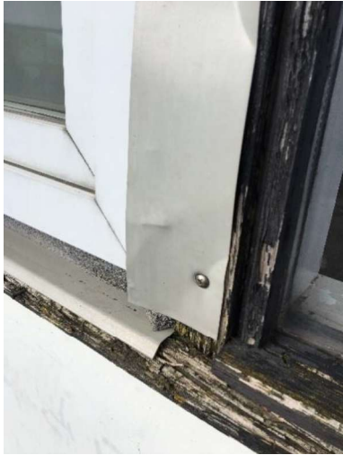
Vinduer er generelt meget nedslidt (malingslag) og rådskadet
