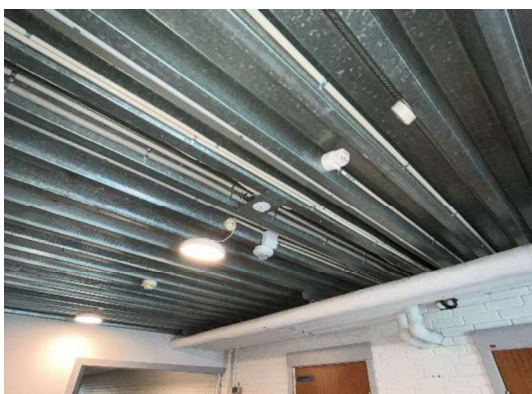
Der er mange forskellige installationer i lofterne, som er udført løbende i bygningens levetid.
