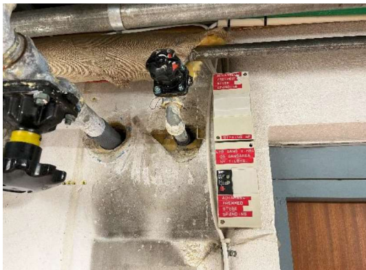
Styretavle og UG-tavler i varmecentralen. Der er løbende blevet renoveret og ombygget på installationerne.
