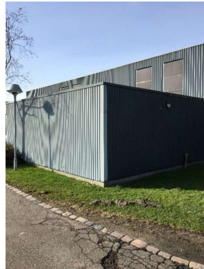
Stålfacade fremstår slidt med mange buler og falmet maling.
