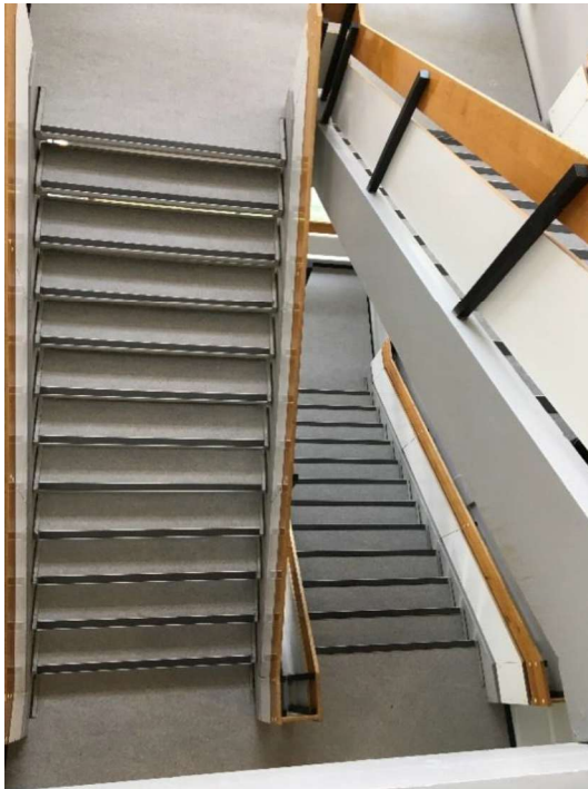
Indv. betontrappe, meget slidt. Konstruktioner er ok, men alle overflader bør skiftes/istandsættes.
