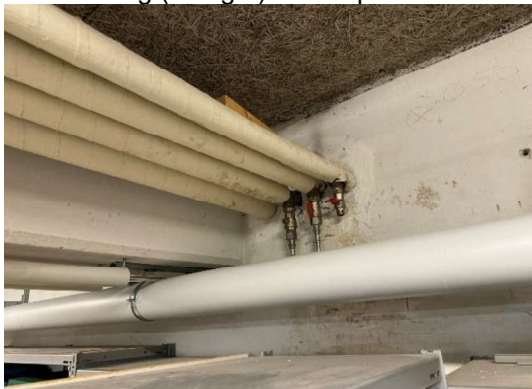
Vandledninger i kælder
