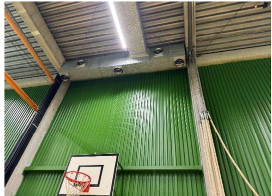
Ventilation i hallen.
