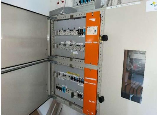
Misligholdt ejendomstavle, med manglende opmærkning.
