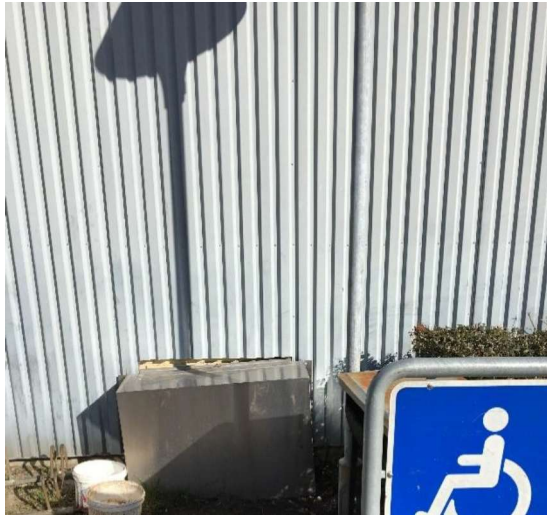
Stålfacade fremstår slidt med mange buler og falmet maling.
