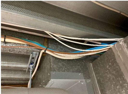
Der er generelt mangler på føringsveje i hallen.
