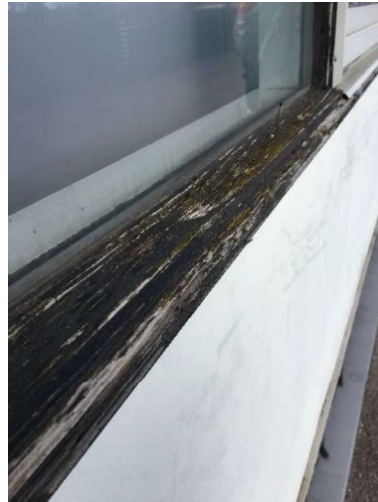
Vinduer er generelt meget nedslidt (malingslag) rådskadet
