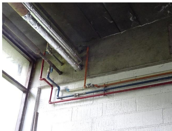
Uisolerede varmtvandsrør og cirkulation i hal
