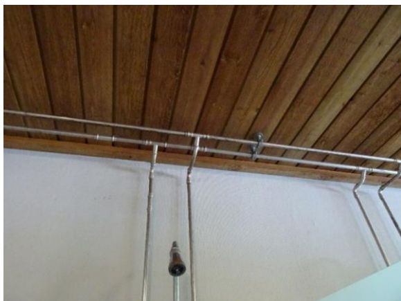
Rustfrie stålør i omklædning
