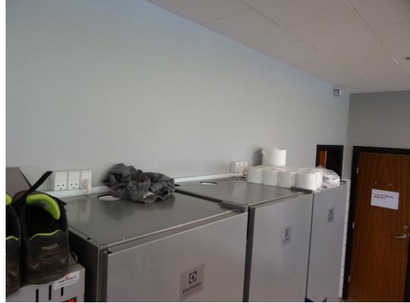
3 tørreskabe med afkast til opstillingsrummet
