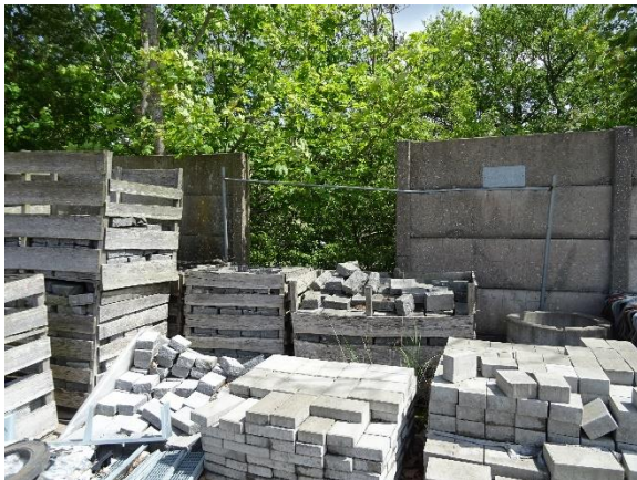
Beton perimeterhegn, ødelagt og lukket med byggepladshegn
