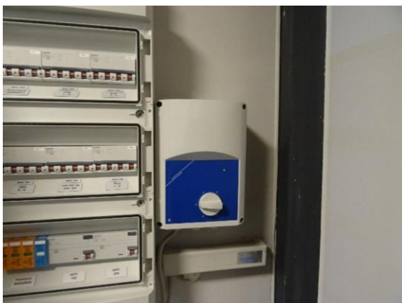
Kalorifere styring i ny bygning 16 (maskinhal)
