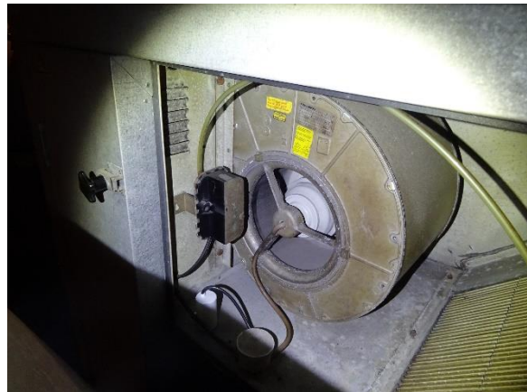
Ventilator i anlæg i kontorbygning
