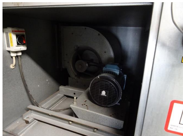
Ventilator i anlæg i værkstedsbygning
