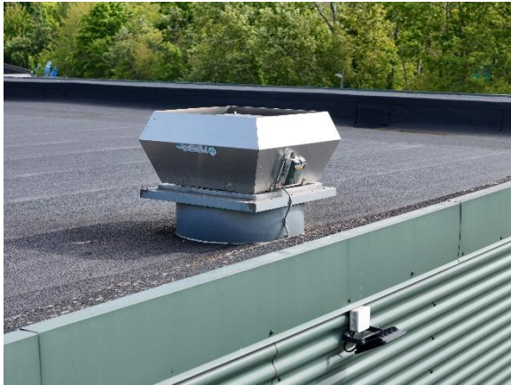
Systemair ventilator på tag over maskinhal
