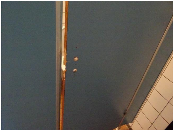
Ødelagt dør i spansk væg, kontorbygningen
