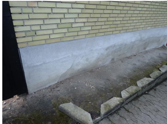
Løs, skruk sokkelpuds kontorbygning nordøst
