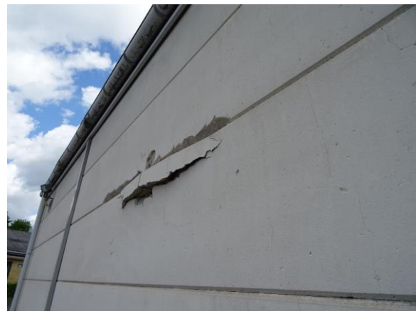
Skadet Siporex element, saltlager
