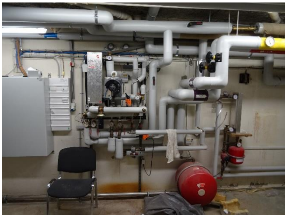
Varmecentral under kontorbygning
