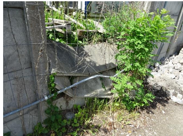
Beton perimeterhegn, ødelagt og lukket med byggepladshegn
