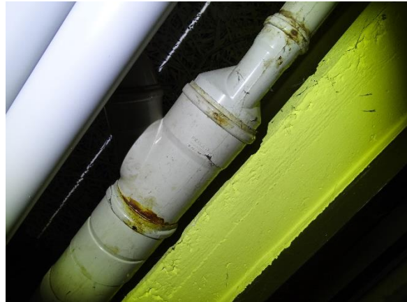
Plast afløbsledning der lækker i samlinger
