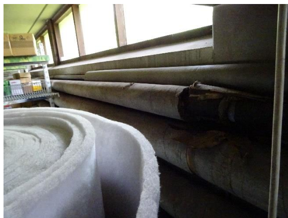
Uisolerede varmtvandsrør 1. sal værkstedsbygning
