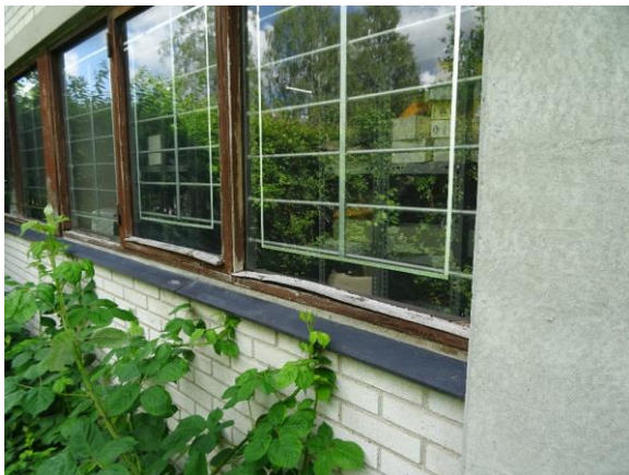
Meget nedslidte vinduer fra 1973, værkstedsbygning
