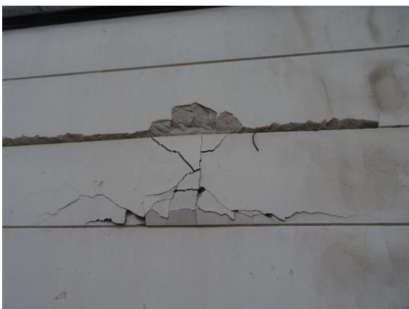
Skadet Siporex element, saltlager
