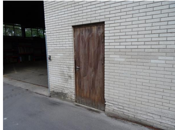
Sydgavl, fugeskader på værkstedsbygning
