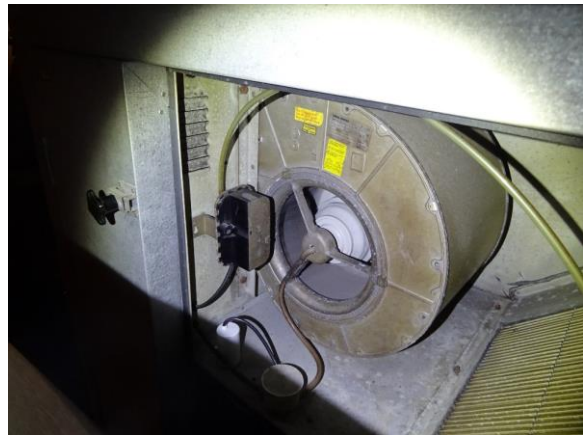
Ventilator og del af krydsveksler i anlæg, kontorbygning
