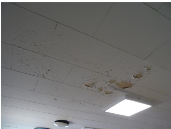
Fugtskadet loft i omklædning, givet pga. tidligere hul i tag
