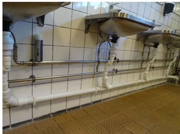
Afløb fra vaske i omklædning
