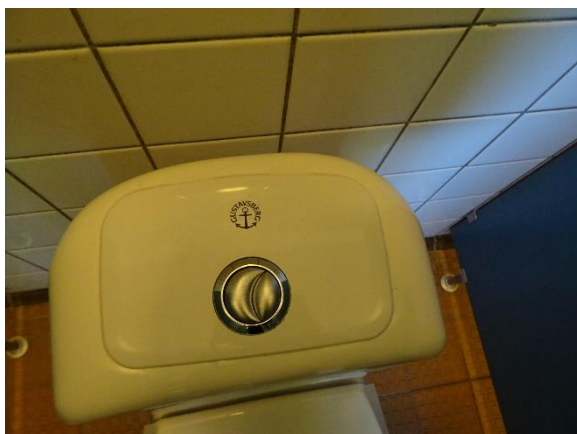
Et af de ældre Gustavsberg toiletter, men med 2 skyl
