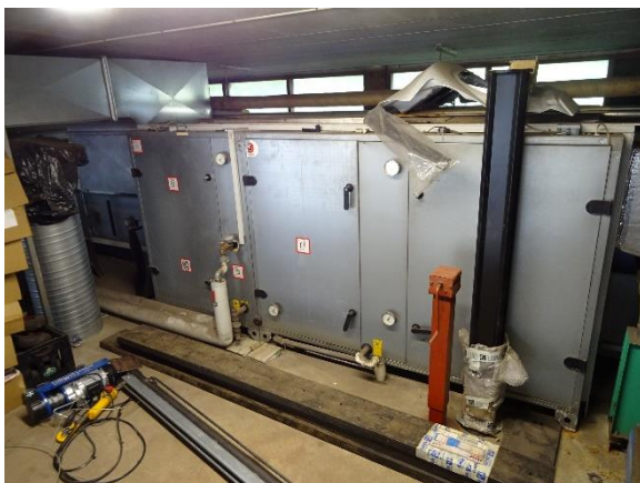
Anlæg i værkstedsbygning
