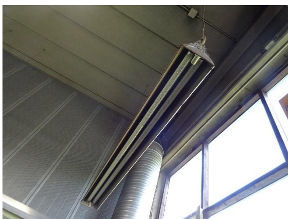
Armatur med LED rør værksted
