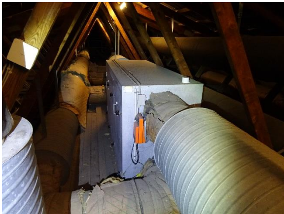
Anlæg på loft i kontorbygning
