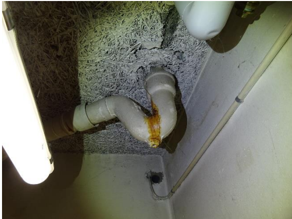
Vandlås i støbejern, der er tæret
