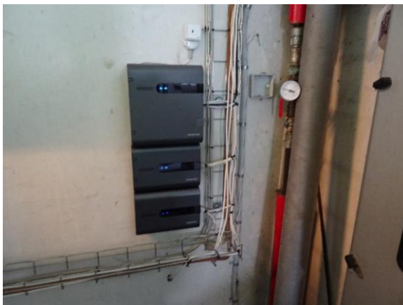
Del af ADK anlæg
