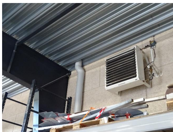
Kalorifere i ny bygning 16 (maskinhal)
