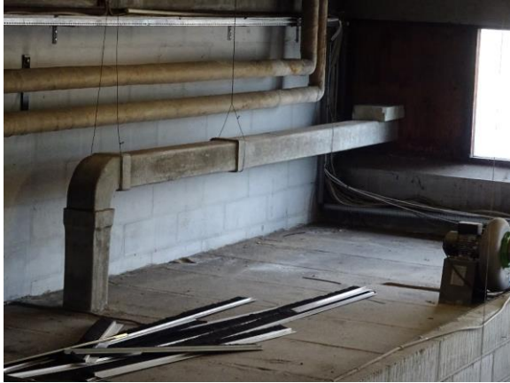
Eternitkanal, mulig asbestholdig
