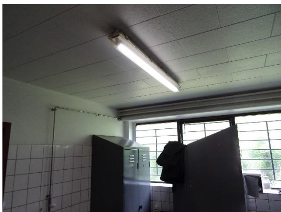
Uisolerede varmtvandsrør over vinduer
