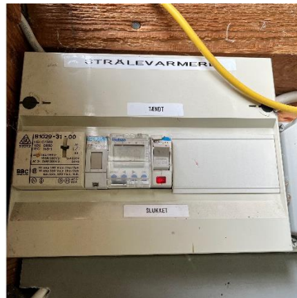
Ml. bygning Eltavle til strålevarmere
