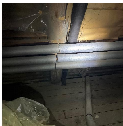
B6 Kobberrør ført på loftsrør
