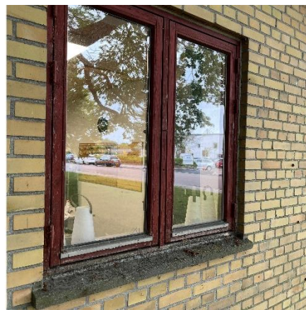
B7 Manglende malervedligehold
