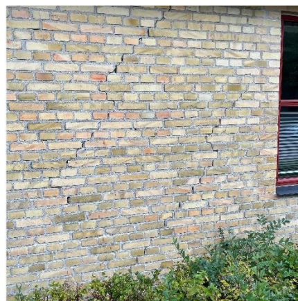
B7 Alvorlige sætningsskader på murfacade m. Brøndby Møllevvej
