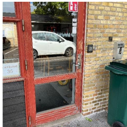
B7 Manglende malervedligehold
