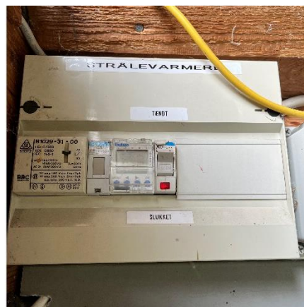
MI. bygning Eltavle til strålevarmere
