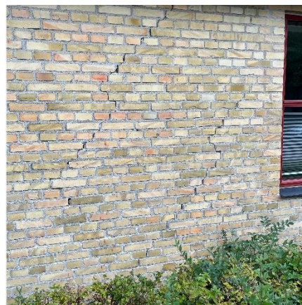
B7 Alvorlige sætningsskader på murfacade m. Brøndby Møllevej
