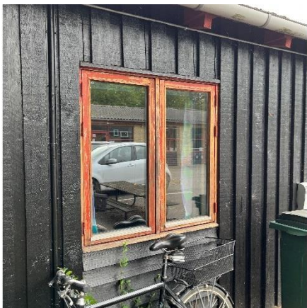
B4 Manglende malervedligehold af vinduesrammer
