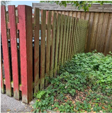
Manglende vedligehold af rækværk
