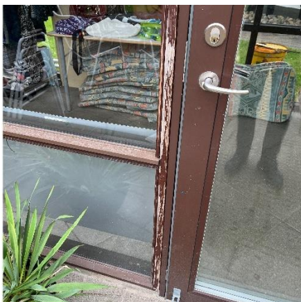
M1. bygning Manglende malervedligehold
