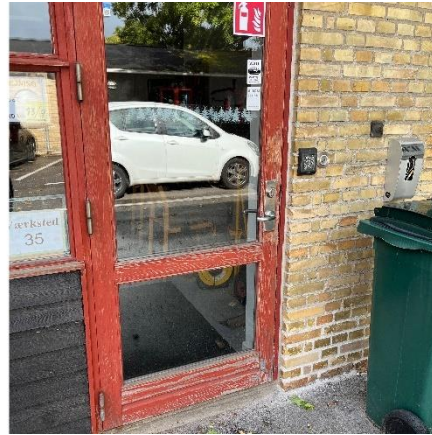
B7 Manglende malervedligehold
