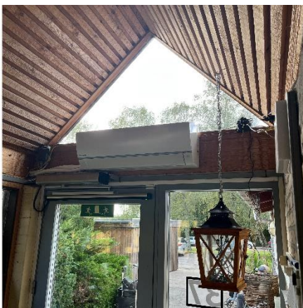
M1. bygning luft/luft varmepumpe fra 2015
