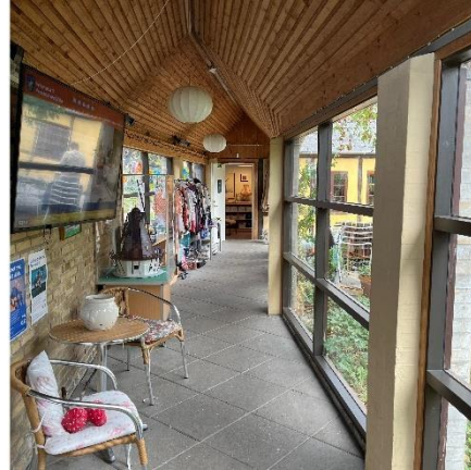
MI. bygning strålevarmere
