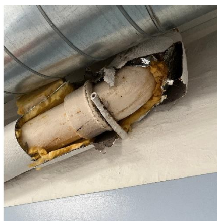
B4 Utæt rør i grupperum 0.020
