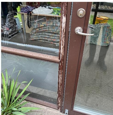
Ml. bygning m. manglende malervedligehold
