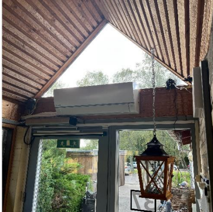
MI. bygning luft/luft varmepumpe fra 2015
