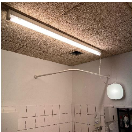
B7 Belysning m. T8-rør og konventionelle forkoblinger
