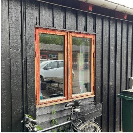
B4 Manglende malervedligehold af vinduesrammer
