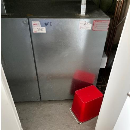
B4 Ventilationsanlæg fra 1997 placeret bag skabs låger på kontor 0.022
