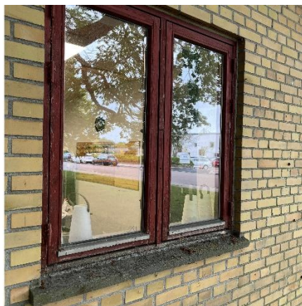
B7 Manglende malervedligehold
