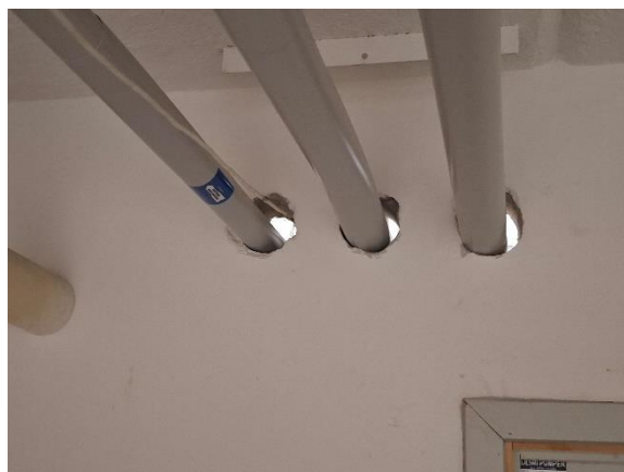
Nyere gennemføringer med manglende tætning i væg.
