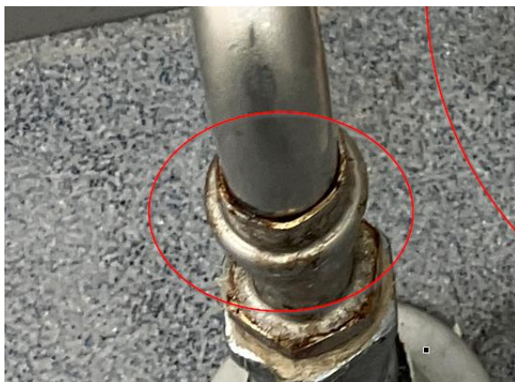
Pressfit udført med skævt monteret eller slidt pres-kæbe, risikere at blive utæt.
