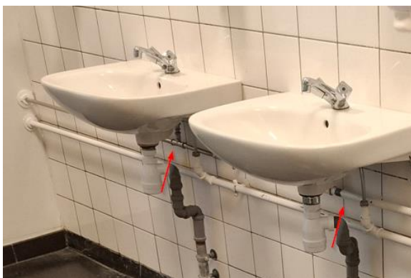
Lille reparation/udskiftning formentligt grundet tæring på varmvandsledning.
