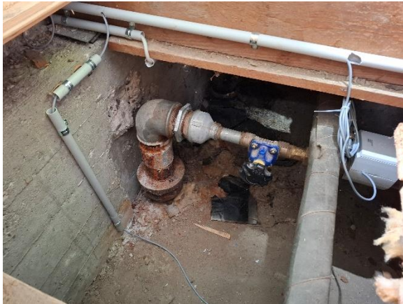
Grov tæring af overflade på vand stikledning
