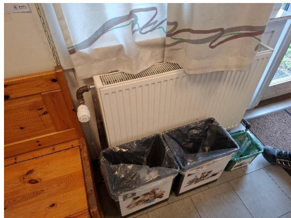
Udskiftet radiator. Fungerer ikke optimalt når spande spærrer konvektion.
