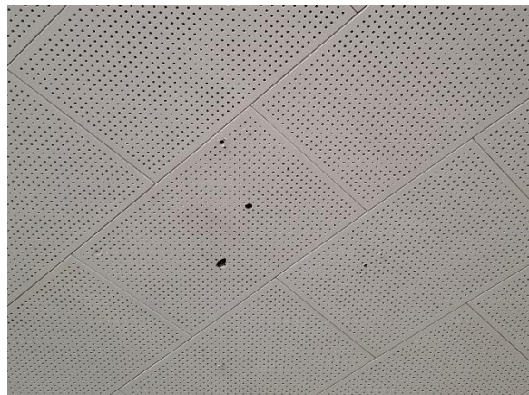
Lofter i svømme- og idrætshallens forhal er med beskadigede plader.
