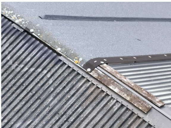
Blottede trælister og manglende rygning ved overgang mellem ståltag og tagpaptag.
