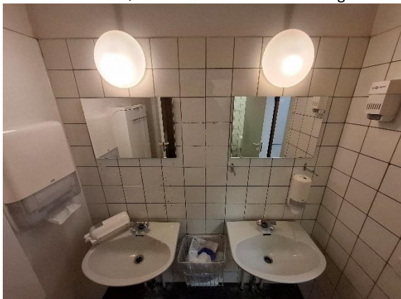
Toiletrum, håndvaskarmaturer med 2 greb.
