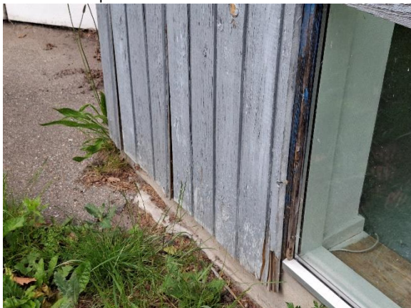
Træfacade på socialdemokratiets lokale har slået sig nederst hvilket gør facaden utæt. Maling er afskallende.
