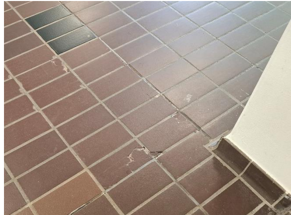
Skader på gulvklinter i svømme- og idrætshallens forhal
