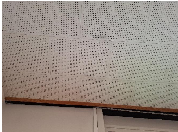
Loft i kontor med misfarvninger efter utæthed i tag.
