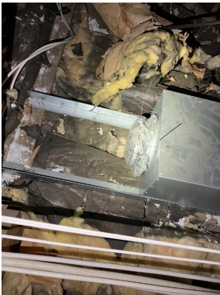
Flere armaturer installeret i loft, men ikke tilsluttet.
