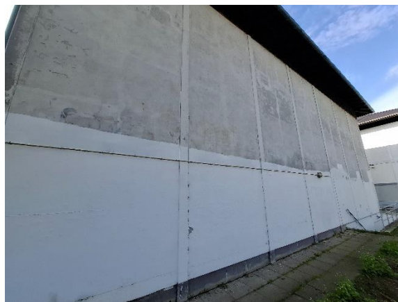
Murede facader på svømmehallen er kun malet 1/3 op fra terræn. Maling skaller af enkelte steder.
