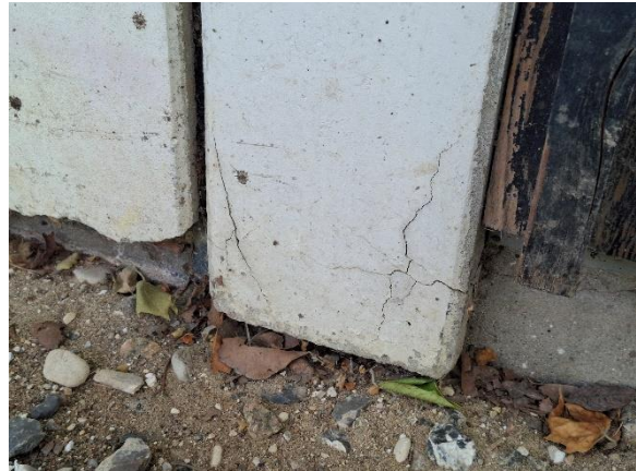
Betonsøjler ses med krakelering nederst. Betonens tilstand bør undersøges nærmere.
