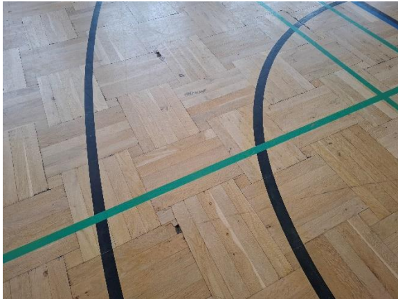
Sportsgulv i idrætshallen er slidt og med huller efter parketstave er faldet af.
