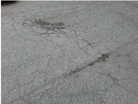
Asfaltbelægninger med revner og lunger
