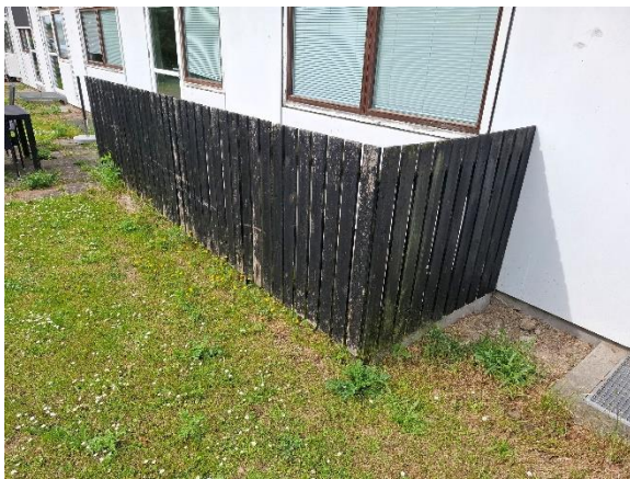
Plankeværk med afskalninger i malingen
