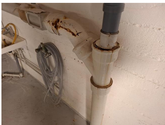
Opsvulmning af mængeringsring og tæringer på rør
