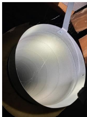
Rør uden funktion.
