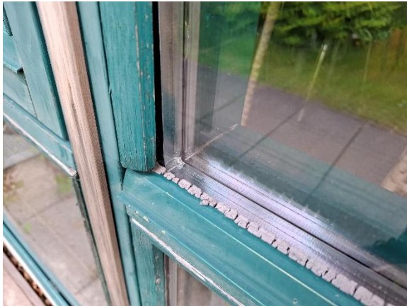
Glasbånd krakleret og manglende på vinduer i multihuset.
