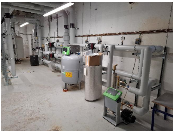
Renoveret fjernvarme central
