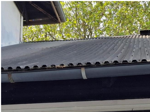
Ståltrapezplader monteret direkte på eternitskifer. Der ses nedbøjning i tagfladerne.
