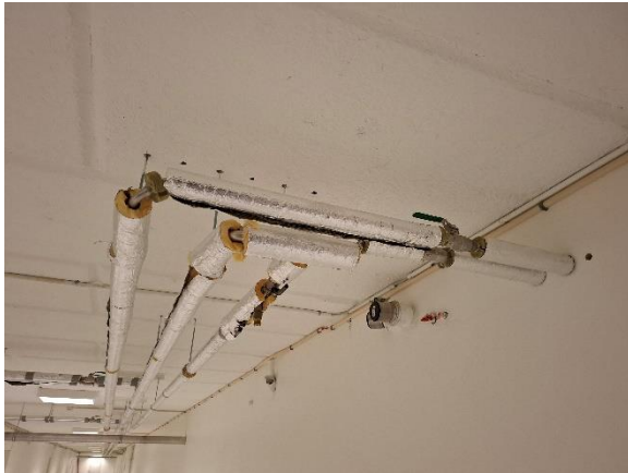
Intermistisk udført isolering.
