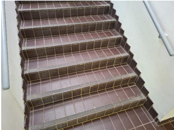
Trappe til 1. sal i svømmehal. Der er afslag i fliseforkanter.
