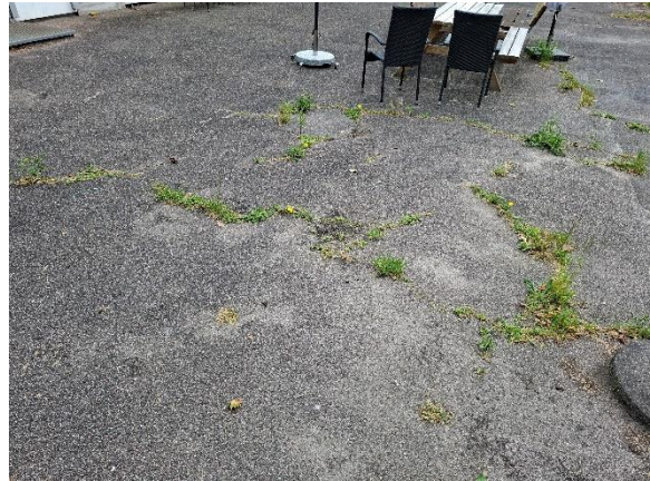
Revner i asfaltbelægninger i gård med begroinger i revner.
