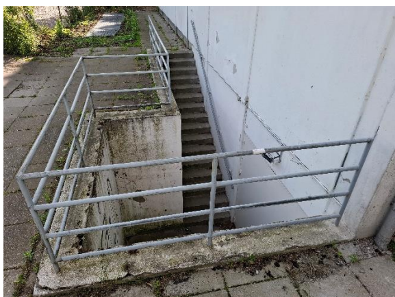
Trappe til kælder under svømmehal. Der er betonafslag på støttmure under rækværk.
