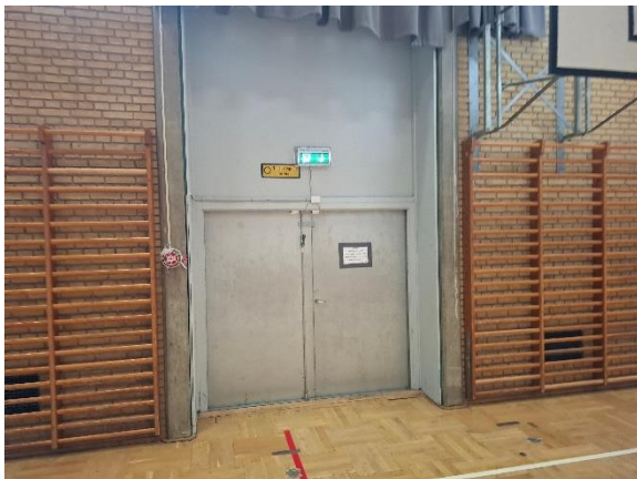
Flugtvejsdør i idrætshal
