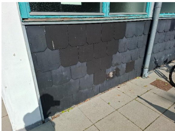
Skiferbeklædning er udsat i sokkelhøjde. Flere er revnet og der ses partielle udskiftninger.
