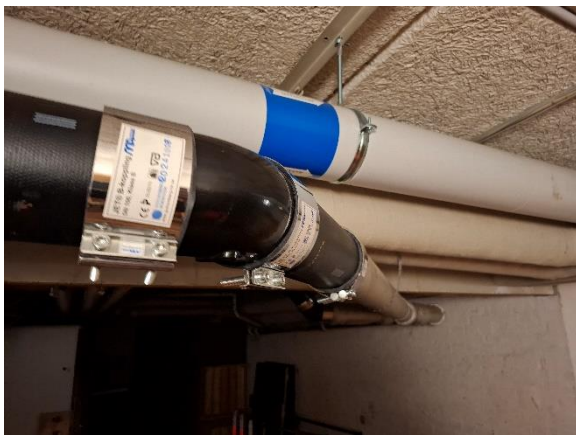
Små reparationer af afløbsrør kunne findes flere steder
