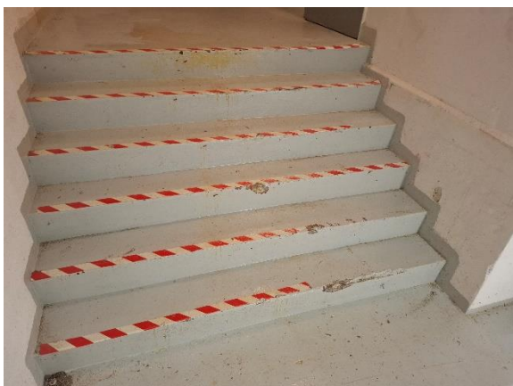
Trappe i varmecentral
