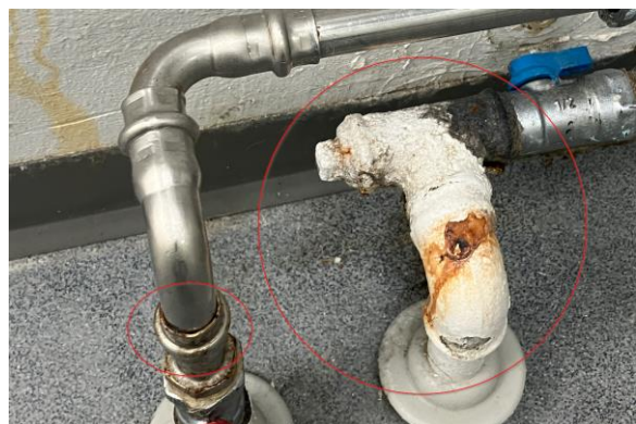
Udtalte tæring på bibeholdt bøjning efter reparation.
