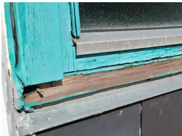
Fastkarmsvinduer på svømmehal. Nedbrudt træværk
