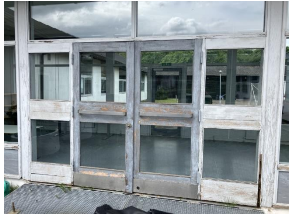
Indgangsparti i træ med nedbrydning i karme flere steder og afskalning
