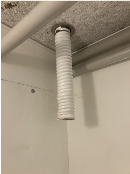
Hvad der formodes at høre til et tørreskab ved toiletter i multihuset. Bør proppes af så ventilation er regulerbart.
