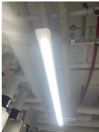
LED belysningsarmatur i kælder
