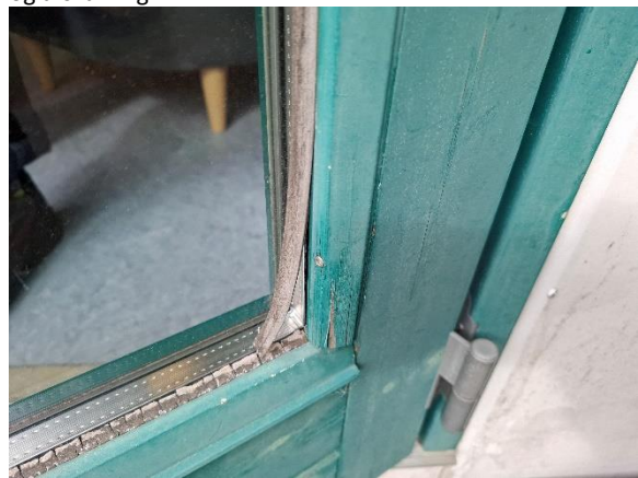
Krakeret og udfaldende glasbånd på dør til multihuset.
