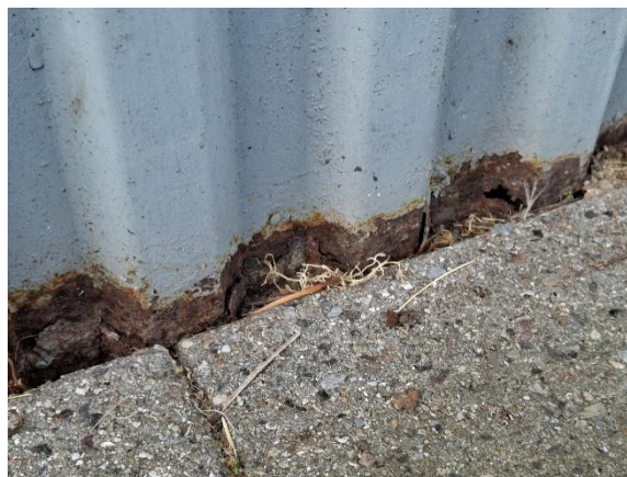
Stålplader er ført helt til terræn. Disse er gennemtæret langs hele facaden.
