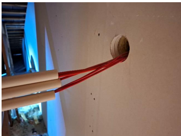
Manglende tætning ved gennemføring i sektionsadskillende væg i lofttrum
