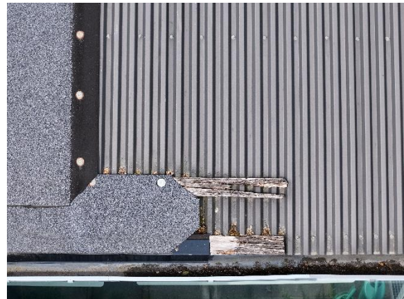
Tagpapbelægning udført på stålplader med uhensigtsmæssig detalje, hvor regnvand trænger ind i konstruktionen.
