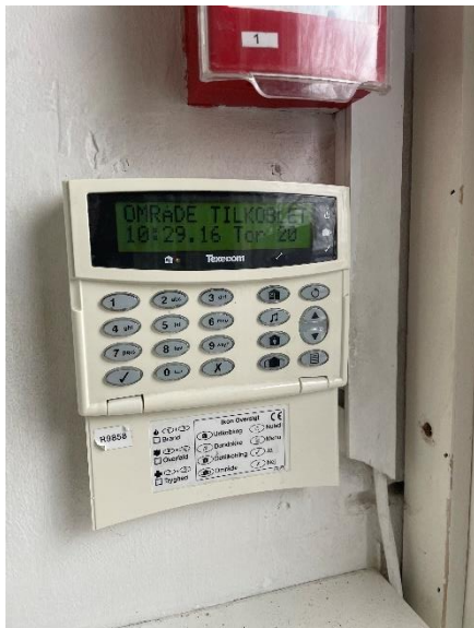
Texecom alarmpanel ved hovedindgangen.
