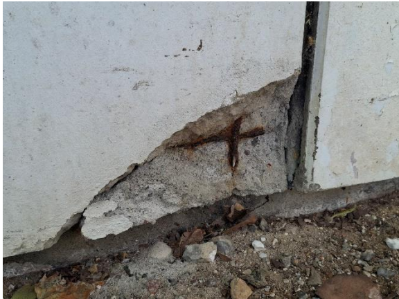
Der ses begyndende afskalninger på betonsandwichelementers nederste hjørnert.
