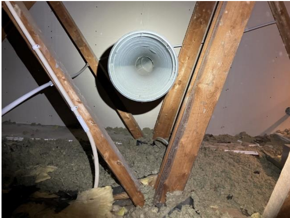
Rør uden tilslutning.
