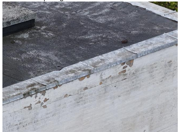
Sternkapsel på idrætshallens installationstårn er beskadiget med opfugtet murværk til følge.
