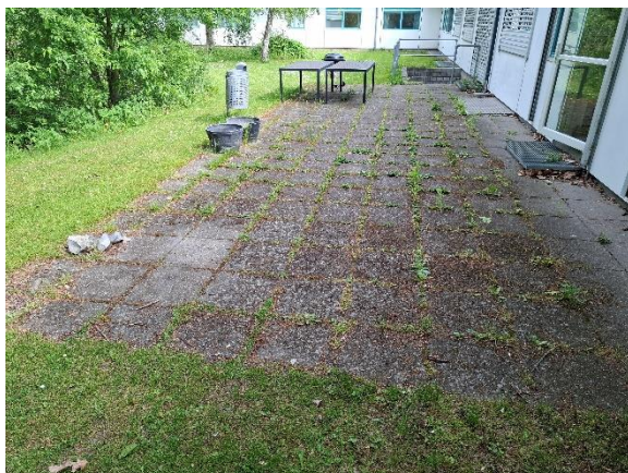
Flisebelægninger med mosbegrøninger på flader og i fuger
