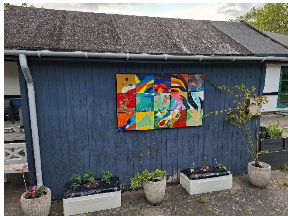
Skur til multihuset med afskalninger i maling og papbelægning med mosbegrøninger.
