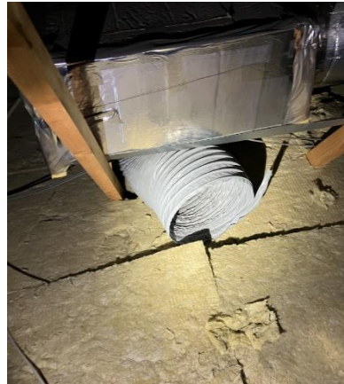
Flere armaturer installeret i loft, men ikke tilsluttet.
