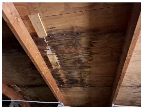
Spor efter indtrængende vand i multihusets undertag.
