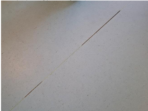
Manglende svejsefuger på linoleumsgulv.
