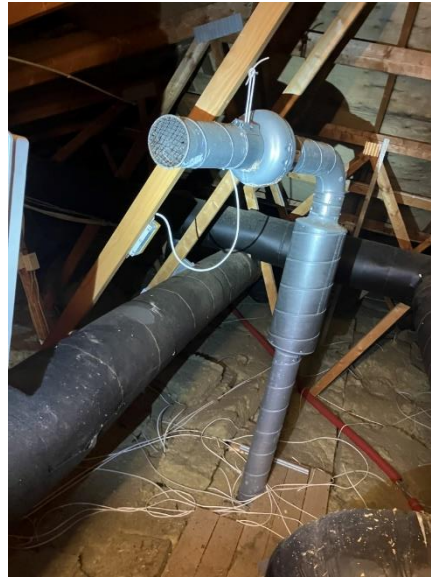
Installation i multihus der suger fra ukendt sted og ventilerer til loft. Det blev forsøgt at spore punktsug men uden held.
