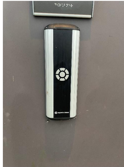
Automatisk døråbner sensor på Handicap toilet.
