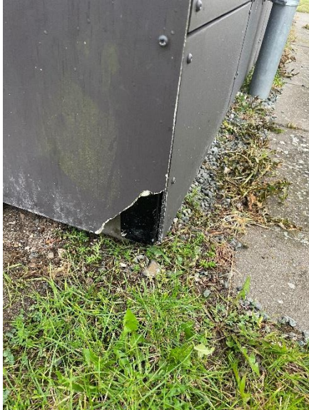
Ødelagt hjørne af facadebeklædningen
