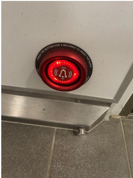
Alarmtryk på handicaptoilettet
