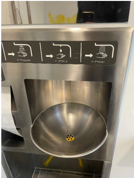
Automatisk vand-armatur indbygget med sæbe dispenser og håndtørrer
