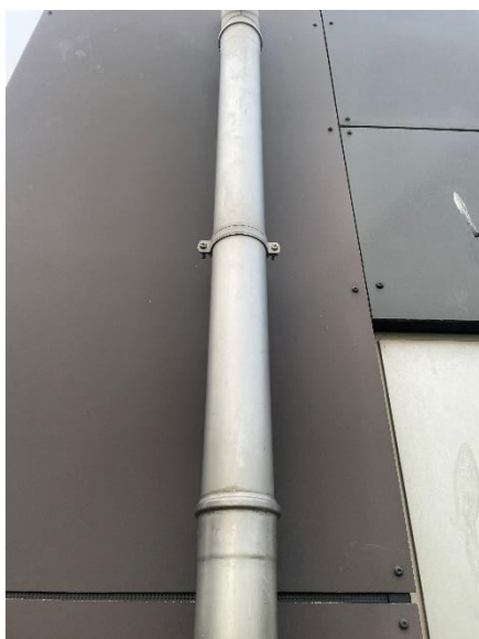
Tagrende nedløb på bagsiden af bygningen
