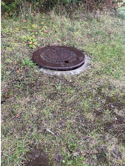
Dækselkarm til kloak ligger løst på topring
