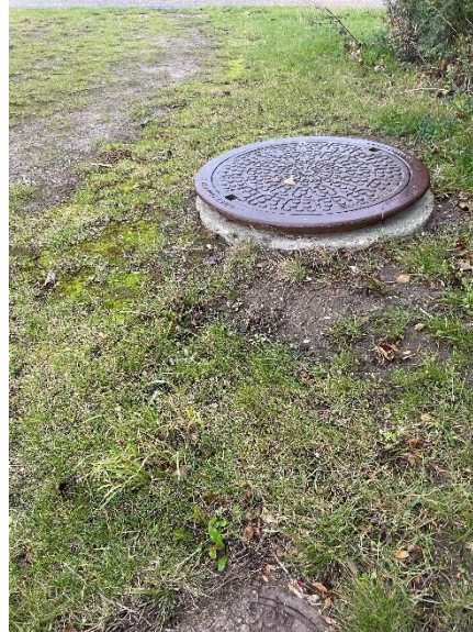
Topring og karm ikke korrekt udført
