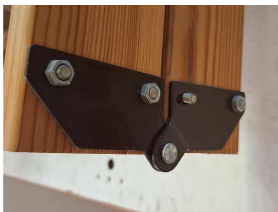
Der mangler møtrik på begge sider af loftstrappe til teknikloft.
