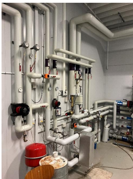
Moderne anlæg der afspejler bygningens alder.
