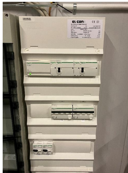
Tavle mangler opmærkning
