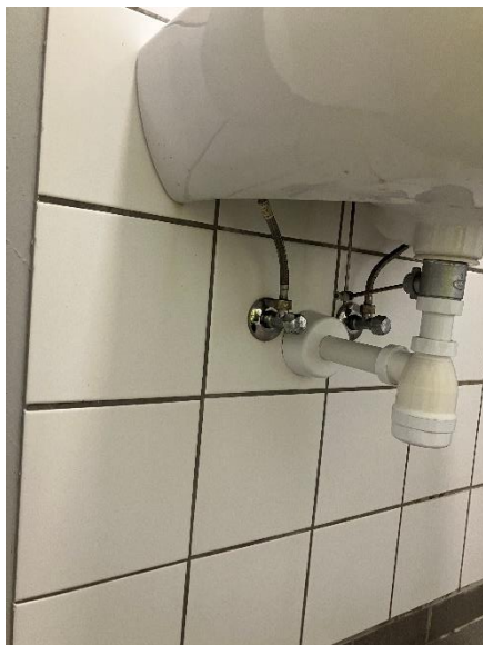
Moderne skjult installation i PP plast
