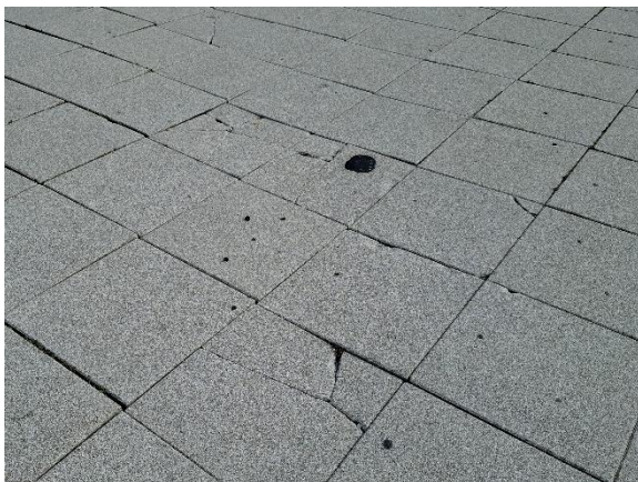
Knækkede betonfliser mod nord
