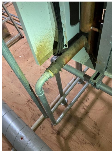
Plamager fra vand på gulv fra udlufter.
