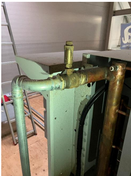
Automatudlufter på kaloriefere formentligt ude af funktion
