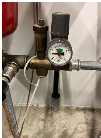
Varmeanlægget stod med meget for lavt tryk. Min. 1,5 bar
