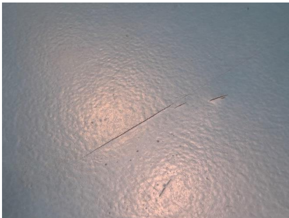
Revner i sportsgulv ved hovedindgang.
