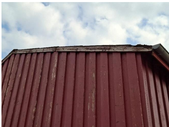
Vindskeder med nedbrudt træværk.
