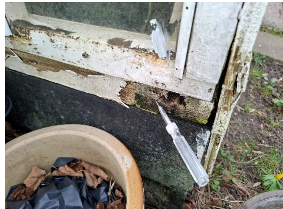
Nedbrudt træværk i drivhus. Krydsfinerplader er delamineret flere steder.
