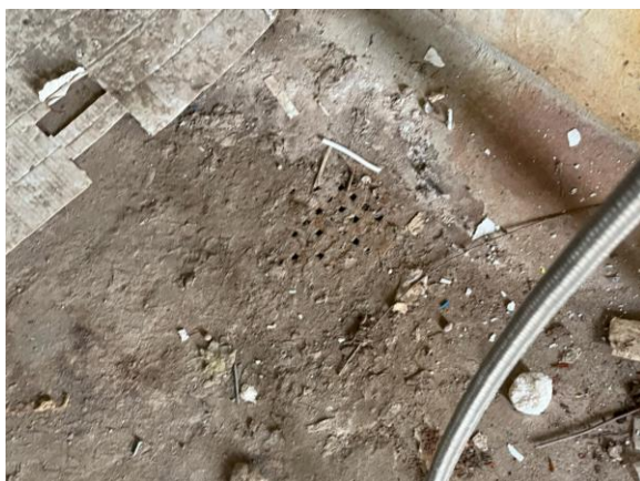
Stoppet gulv afløb
