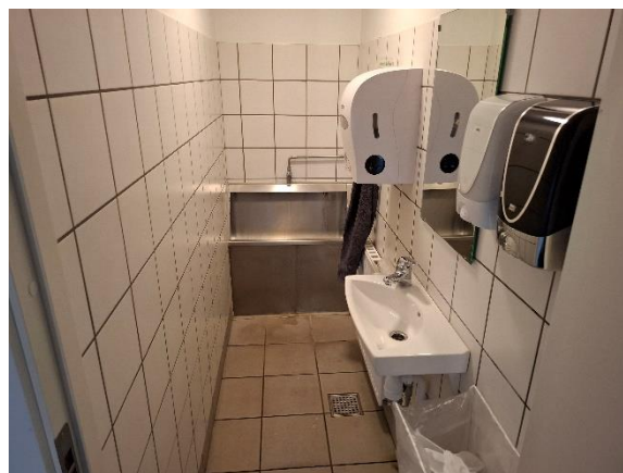
Urinal i bygning syd
