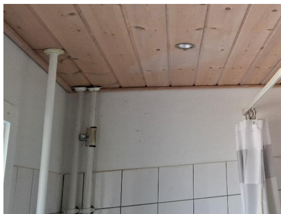
Midlertidig bandagemuffe på vandrør i baderum i baghus tyder på at installationen trænger til udskiftning.
