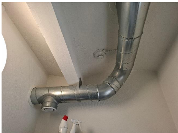
Udluftningskanal i forhus.
