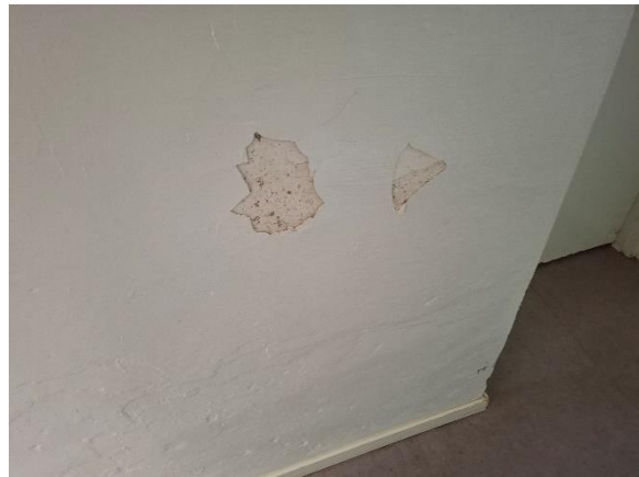
Afskallende puds på ydervæg i forhus.
