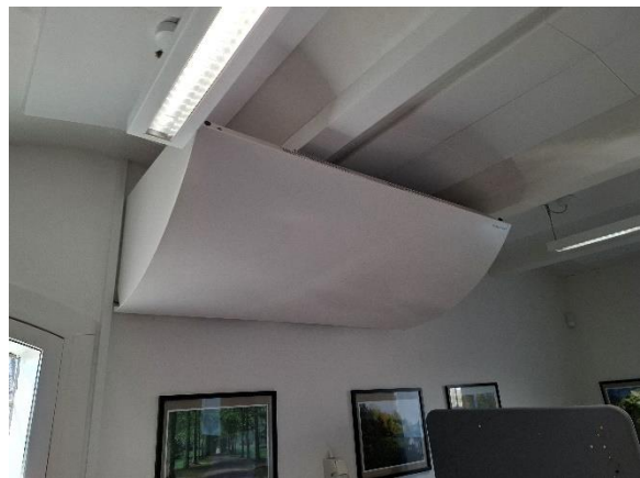
Luft til luft varmepumpe
