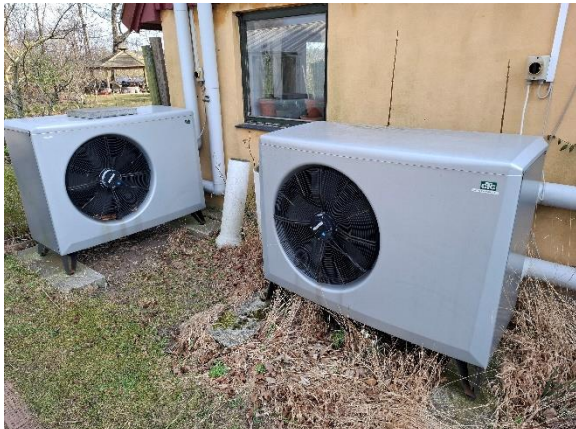
Ude del luft til vand varmepumpe
