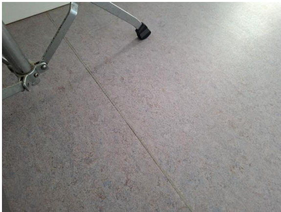
Svejsefuger slipper på linoleumsgulv i forhuset.
