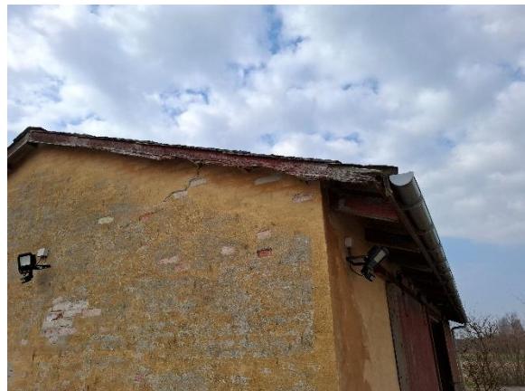
Garage med sætningsrevner og vindskede med nedbrudt træværk.
