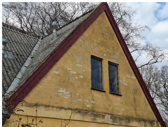
Afskallende puds på baghusets gavlvæg
