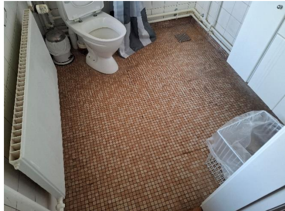
Slidt mosaikflisegulv i toiletrum i baghus
