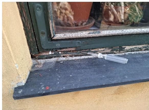
Trævindue på baghuset med 2 enkeltlags ruder er med nedbrydning i træværket.
