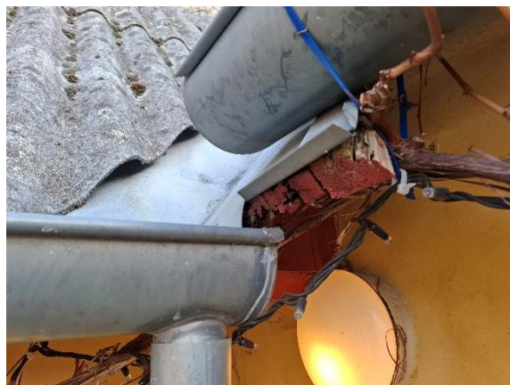
Nedbrudt træværk under skotrende mellem vestlænge og baghus.
