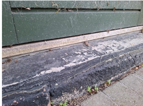
Fuge under dør i baghus mod nord mangler vedhæftning.
