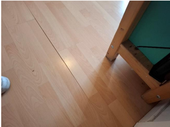
Ujævnhed i bøgelamelparket i kontor i baghus
