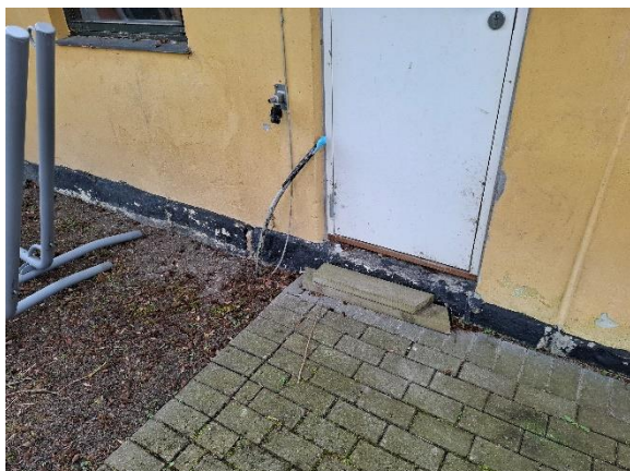
Sokler på baghus med afskalninger
