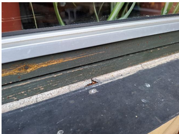
Udfaldende mørtelfuge på vindue i baghus
