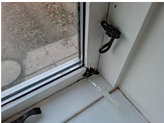
Trævinduer mod vest fra 1994 med nedbrudt træ i hjørne
