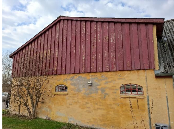
Afskallende maling på træbeklædning og opfugtet puds.
