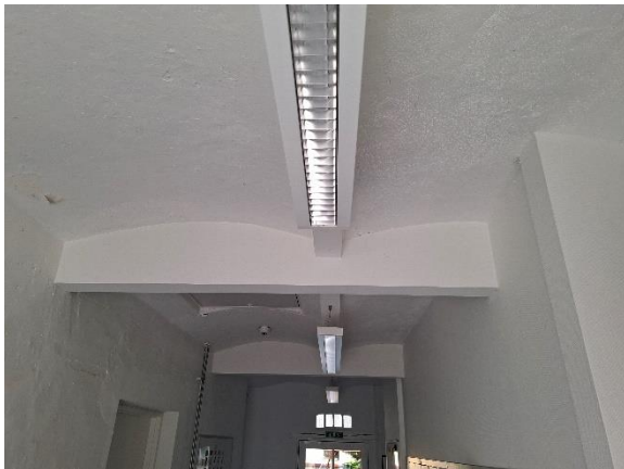
HF-armaturer med LED lyskilder
