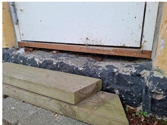
Dør fra 2013 til teknikrum er udført uden bundfuge.
