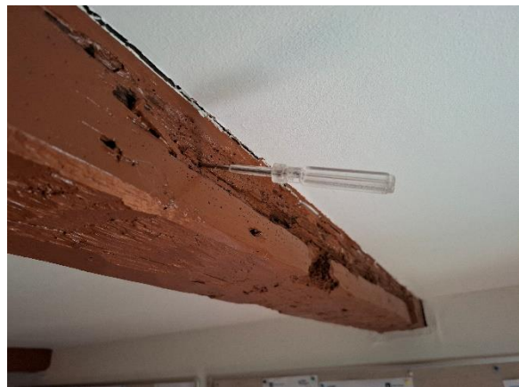
Bjælke i kontor i baghusets østvendte kontor er medtaget efter tidligere angreb af borebiller. Bjælkens bæreevne bør undersøges og bjælken udskiftes om nødvendigt.
