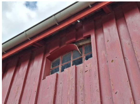
Sålbænke og lysninger ved vinduer i tremplens træbeklædning er udført med masonitplader. Disse er alle helt eller delvist faldet af.
