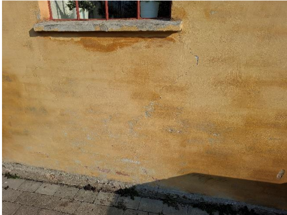
Revner i facade og tegn på opfugtning
