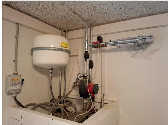
Ekspansionsbeholder og pumpe.
