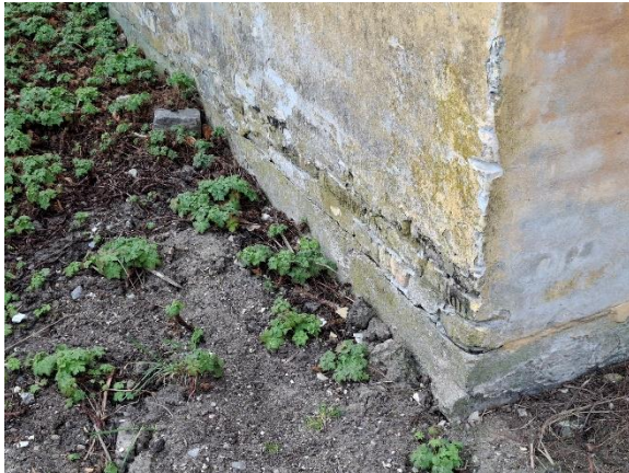
Murværk på garage med afskallende puds og fuger, hvor facaden er opfugtet.
