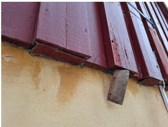
Ventilering af loftrumets facadebeklædning er tillukket med masonitplader. Flere af disse er faldet af.
