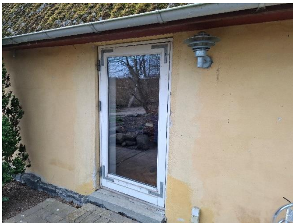
Dør fra 2001 i baghus mod nord med forstærkede hjørner
