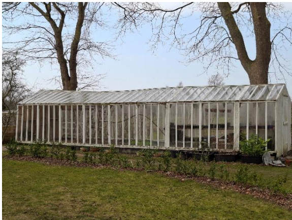
Drivhus i have mod nord er bygget i træ med plexiglas. Der er anvendt krydsfiner uden inddækninger. Trævært er med nedbrydninger i det meste af konstruktionen.
