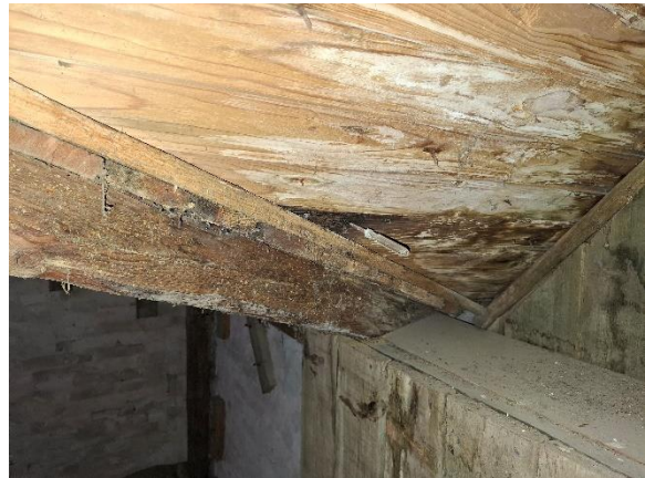
Utæthed i skotrende mod gårdens sydvestlige hjørne har forårsaget opfugtet og nedbrudt træværk.
