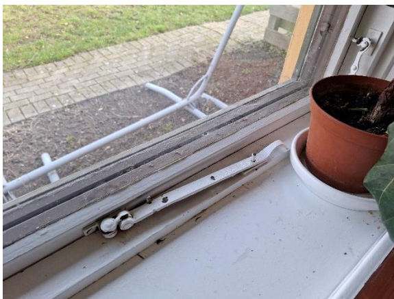
Gamle vinduer med 2 lag enkeltlags glas.
