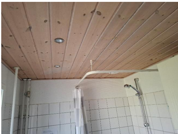
Træloft i badeværelse i baghuset er udført 115 cm over færdigt gulv. Materialet er uhensigtsmæssigt i baderum og driften bør sikre sig at spors lever op til kravene ift. lofthøjde og indbygningsmateriale.
