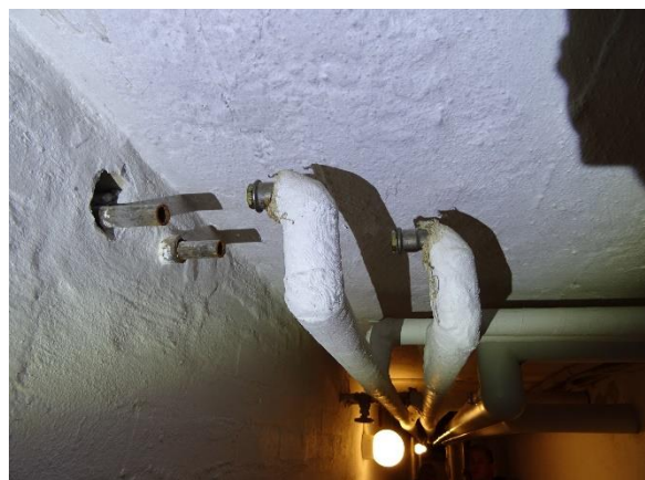
Afskåret rør i væg og døde rørender.
