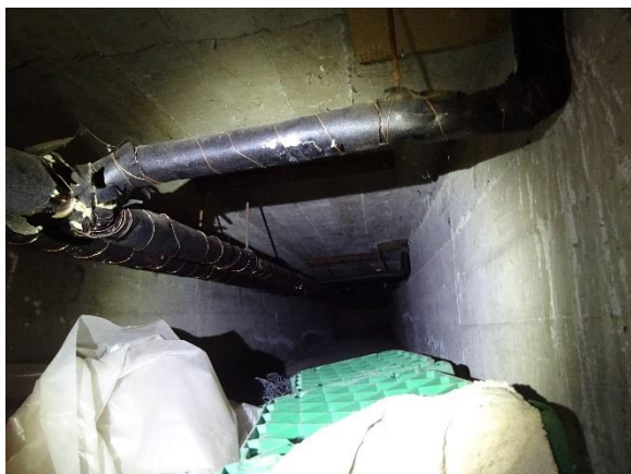
Installationskanal under bygning
