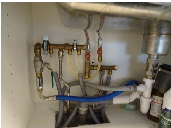
Fordelerrør og tilslutninger i køkken
