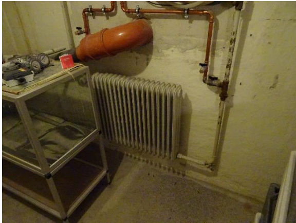
Søjleradiator i kælder
