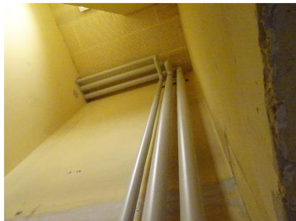
Brugsvandrør overførsel fra kælder til stuen i trapperum
