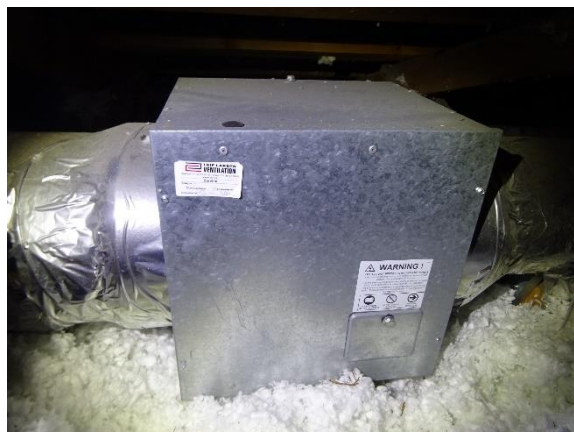
Udsugning fra køkken emhætte
