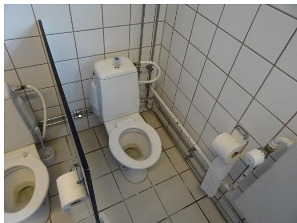
Fordelingsrør i rustfri og tilslutninger på toilet
