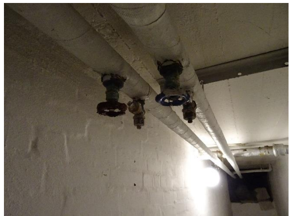
Ventiler i kælder, der er næsten tæret op
