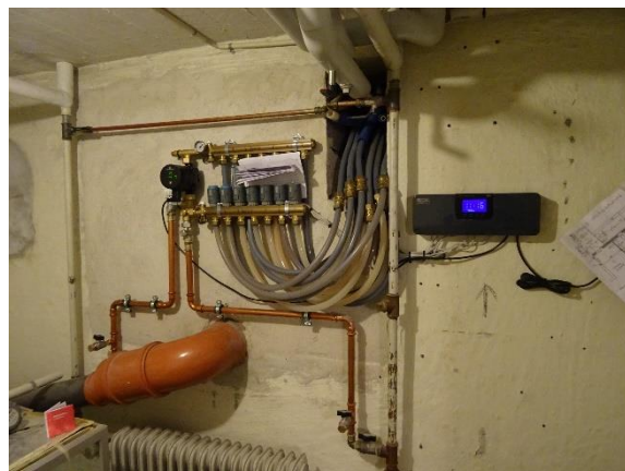
Gulvvarmeshunt til bygninger fra år 2000. Skiftet 2022.
