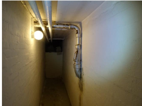
Støbejernsfaldstamme i kældergang
