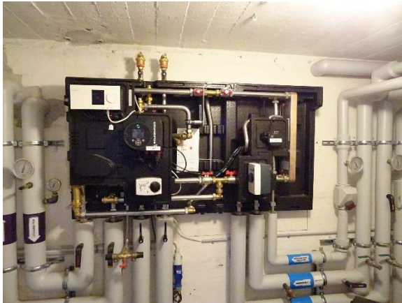
Varmstyring Danfoss ECL 310 på fjernvarmeunit
