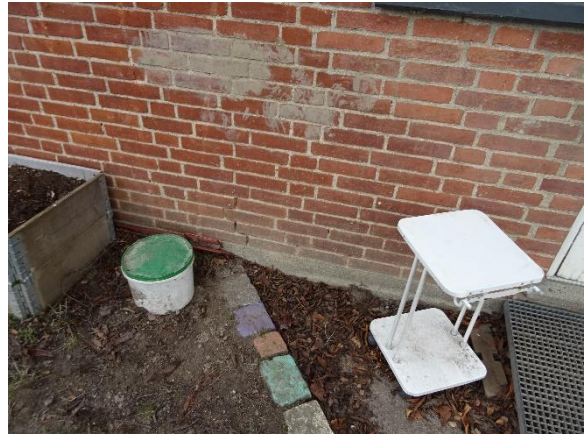
Mindre revne i murværk mod legeplads
