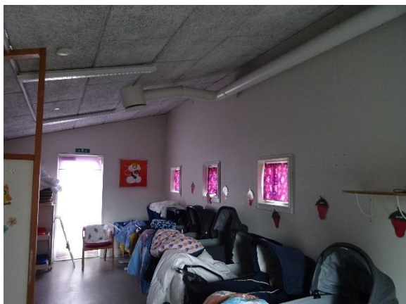
Ventilationskanaler og spjæld i liggehal
