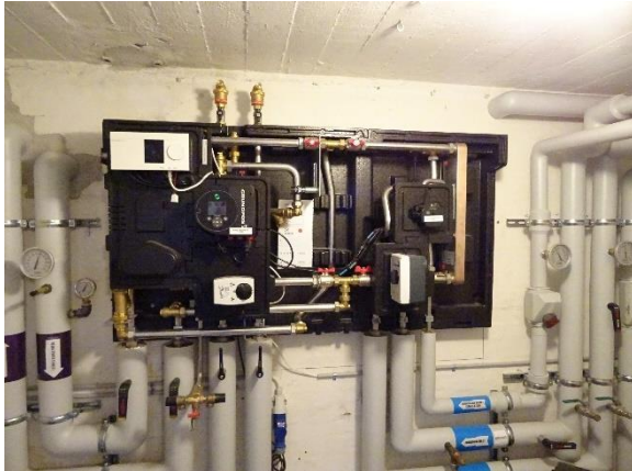
Varmtvandsproduktion i højre side af fjernvarmeunit
