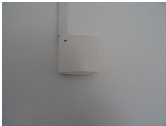
Rumføler for ventilation
