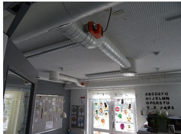
Ventilationskanaler og spjæld på stue
