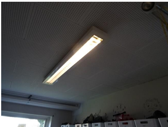
Det mest udbredte belysningsarmatur med lysstofrør
