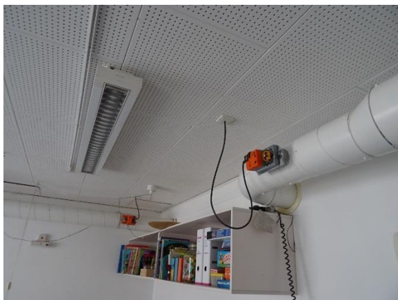
Spjæld på ventilationskanal, installeret pr. stue
