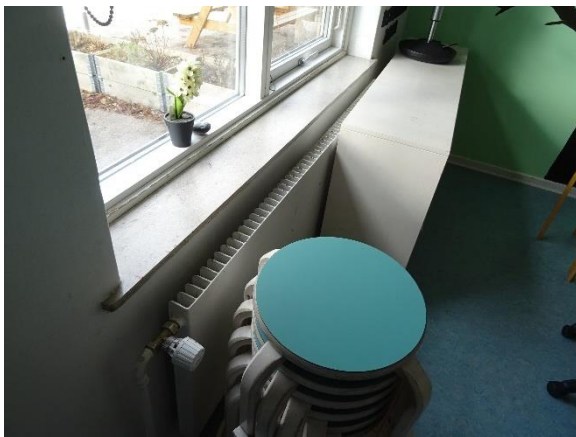
Pladeradiator på stue
