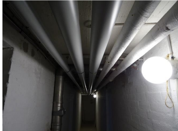
Hovedfordeling i kælder
