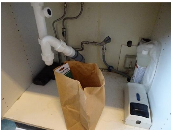
Tilslutningsslanger under vask
