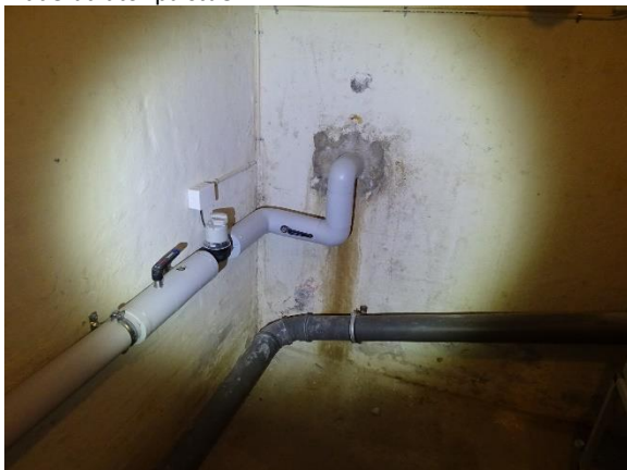
Lette vandindtrængning gennem rørgennemføring
