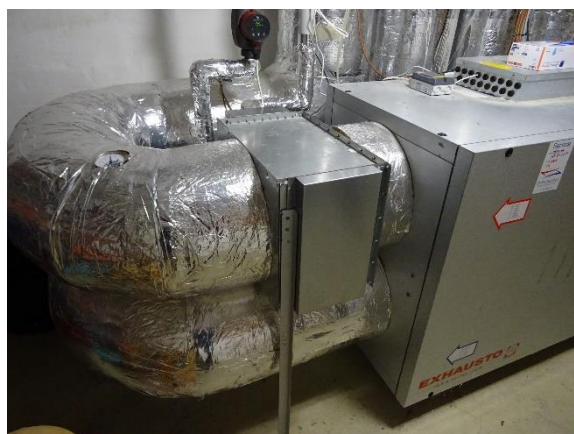
Varmeflade på indblæsningskanal
