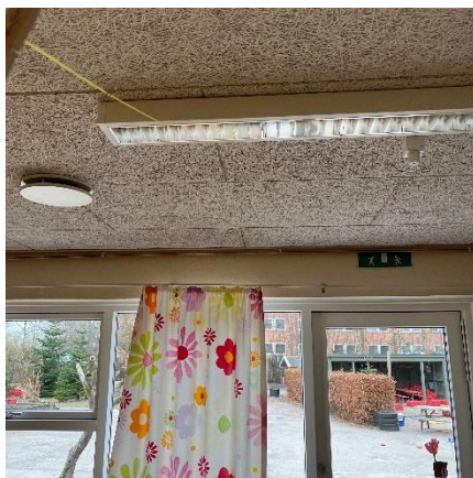
HF-armatur med 28W lysrør
