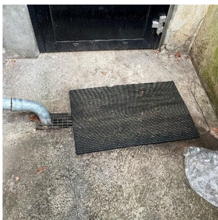
Måtte forhindrer, at vand kan sive ned i afløb
