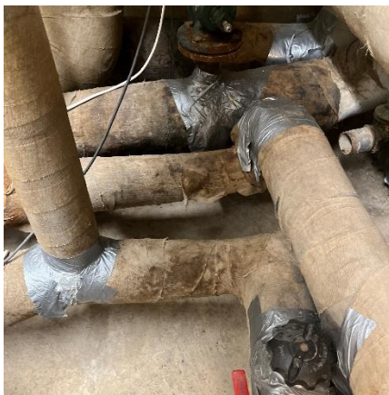
Rørisolering i teknikgang
