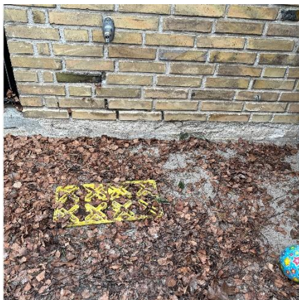
Facade mod SV mod gård, beskadiget sokkel
