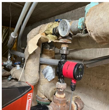
Pumpe i teknikrum i kælder
