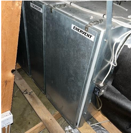
Ventilationsanlæg på loft
