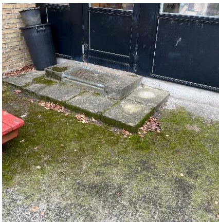
Mos begroning ved indgang til tilbygning
