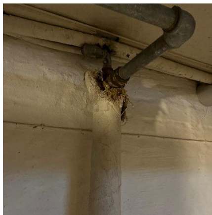
Brudt isolering ved samling
