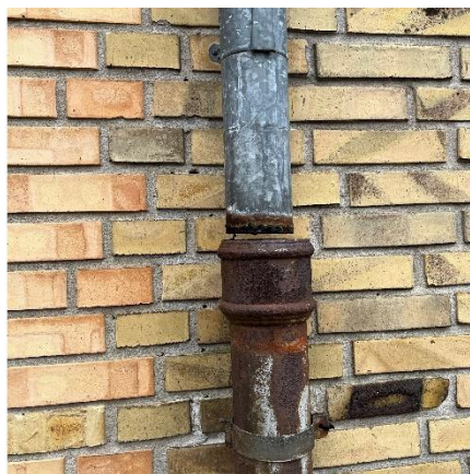
Brudt samt tæret nedløbsrør ved bygning mod NV
