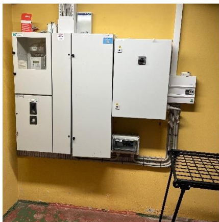
Tavler i teknikrum, kælder
