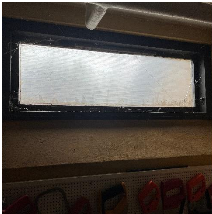
Vindue i kælder med revnet etlags glas
