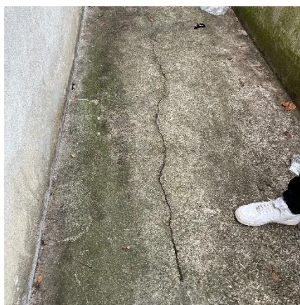
Revne i betonrampe
