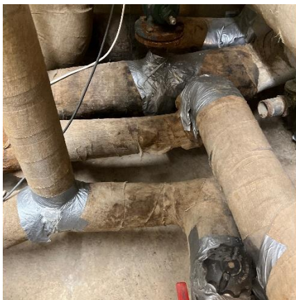
Rørisolering i teknikrum, kælder
