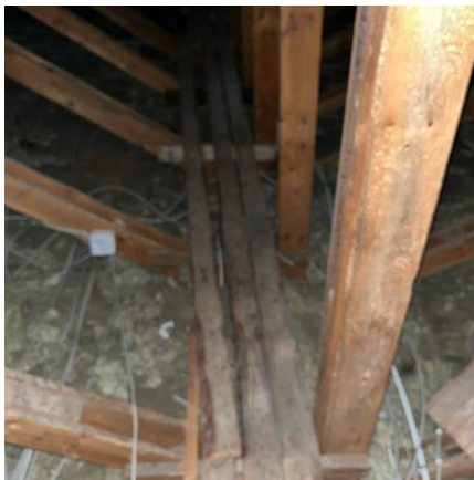
Gangbro og isolering på loftsrum
