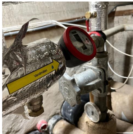
Vandmåler i teknikrum, kælder
