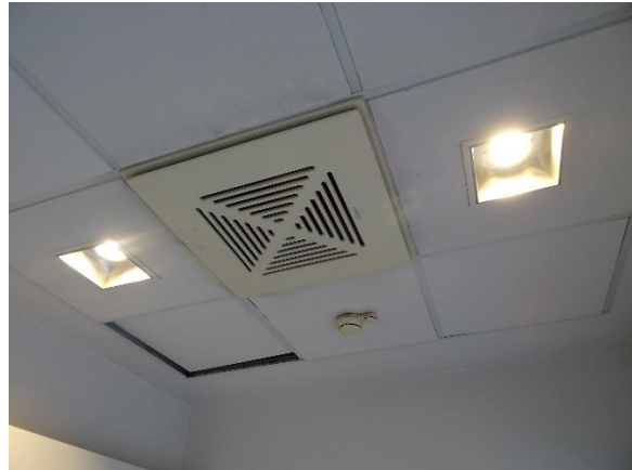
Lufttæppe i indgangsparti
