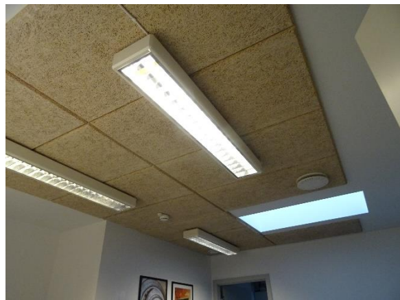
Ældre armaturer med lysstofrør
