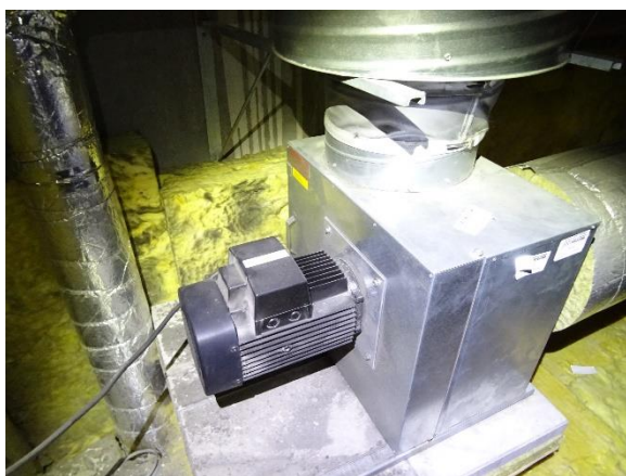
Boksventilator på loft
