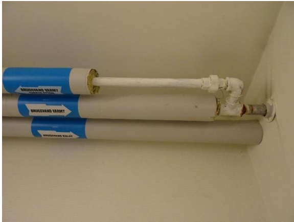
Galvaniserede rør kulturhus,
