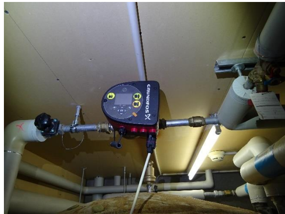
Pumpe og rørstrøm uisolaret
