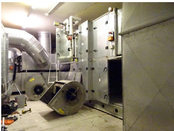
Ventilationsanlæg for kulturhuset
