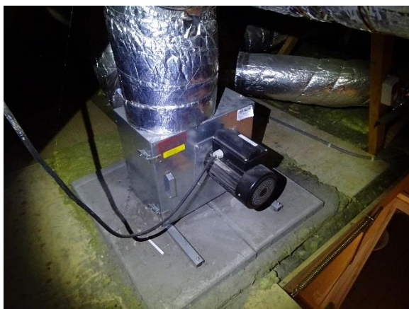
Udsugningsanlæg for omklædningsrum
