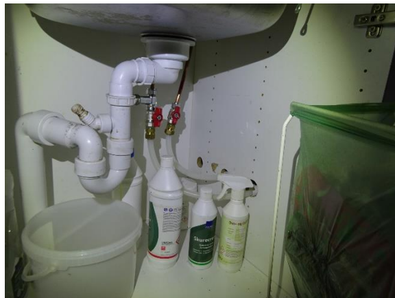
Afløb under køkkenvask
