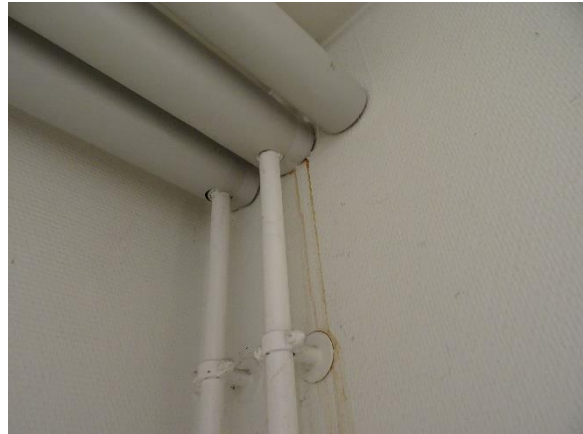
Galvaniserede rør kulturhus, løbere på væg fra tæring
