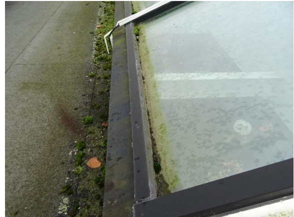
Problemer med dræning og afløb fra rytterlys
