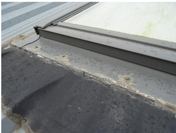
Fuger omkring Velux vinduer er nedslidt
