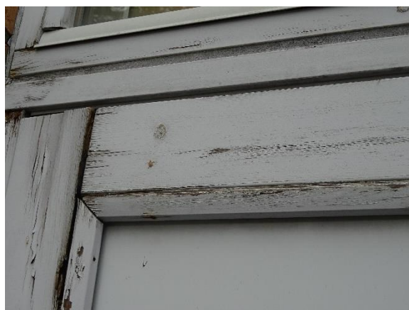
Skader på udgang fra sal
