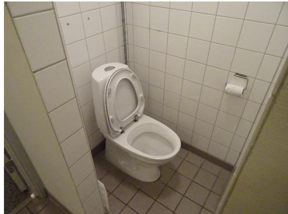
Toilet med to skyl
