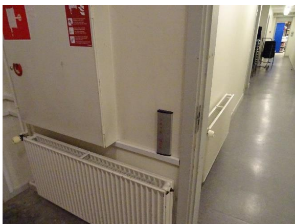
Radiatorer for opvarmning fra 1999
