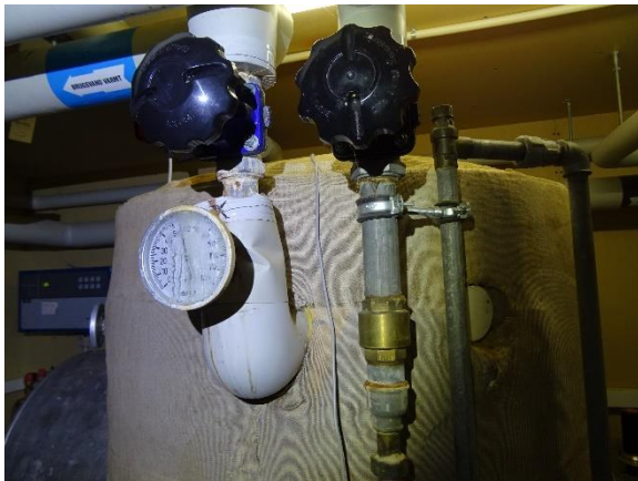
Varmtvandsbeholder kulturhuset, 800 L
