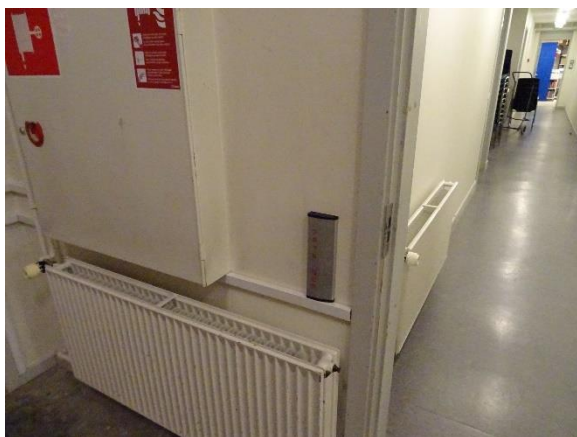
Radiatorer for opvarmning fra 1999
