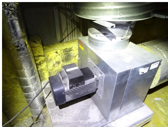
Udsugningsanlæg for toiletter
