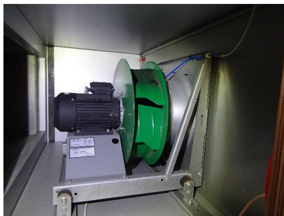
Ventilatorer for biblioteket
