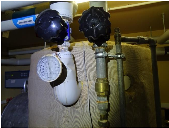
Varmtvandsbeholder kulturhuset, 800 L
