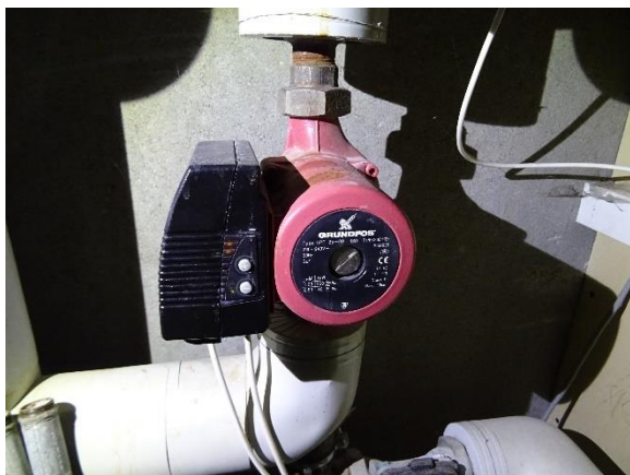
Pumpe i varmecentral fra 1999
