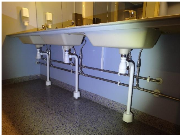
Afløb under håndvaske toilet
