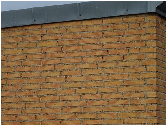
Murværk over tag, sydgavl, mindre skader på fuger
