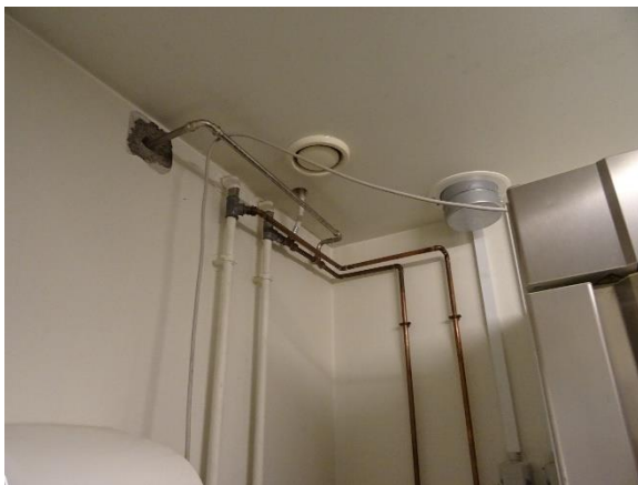
Knopskydning i 4 forskellige rørmaterialer indenfor 1 m
