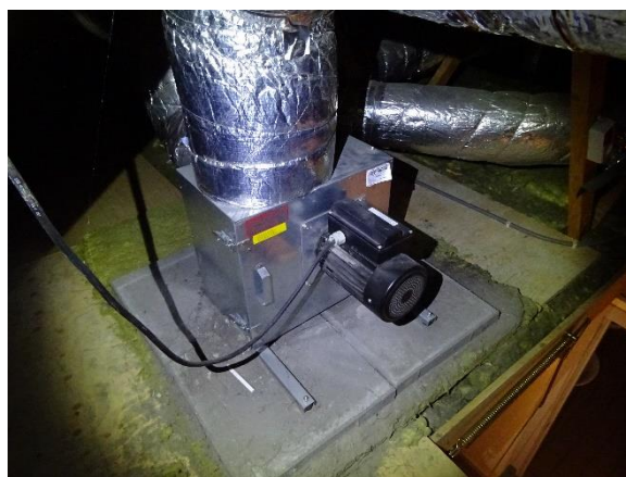
Boksventilator på loft
