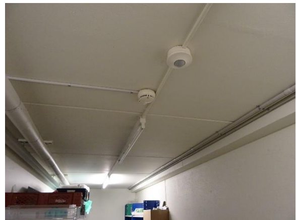
Depot med PIR
