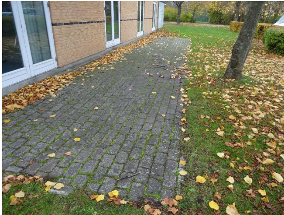
Beton holmegårdssten med rodopskud og lunker
