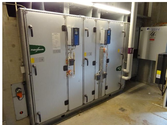
Ventilationsanlæg for bibliotek
