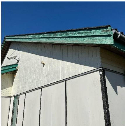
Manglende malervedligehold af vindskede og gavle
