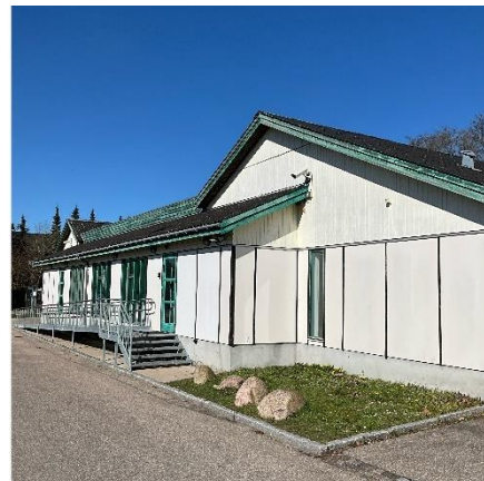
Generel misvedligeholdt facade.
