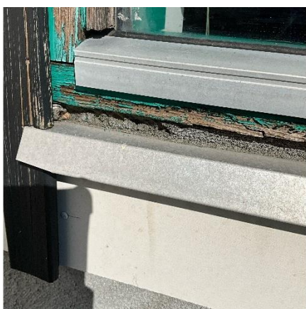
Utæt fuge i bundkarm
