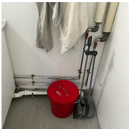
Brugsvandinstallationer i køkkenet
