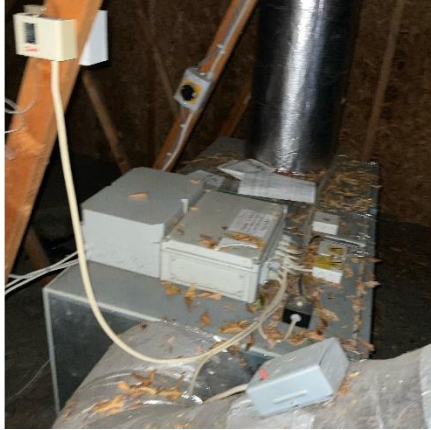
Ventilationsanlæg på loft
