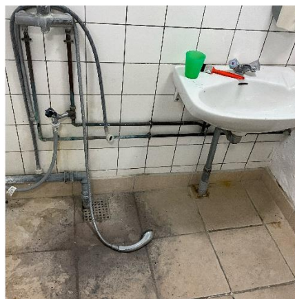
Håndvask og brusearmatur i kælder tilsluttet med kobberør
