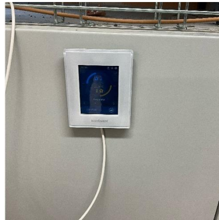
Automatik til anlæg
