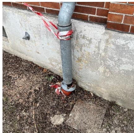
Uafsluttet overgang mellem nedløbsrør og kloakrør
