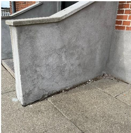
Revnet puds på trappe mure
