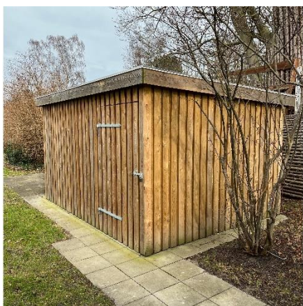
Skur i baghave mangler malerbehandling
