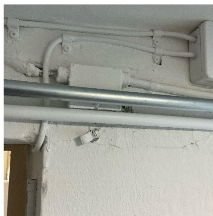
Rør ført ulovligt foran elldåse
