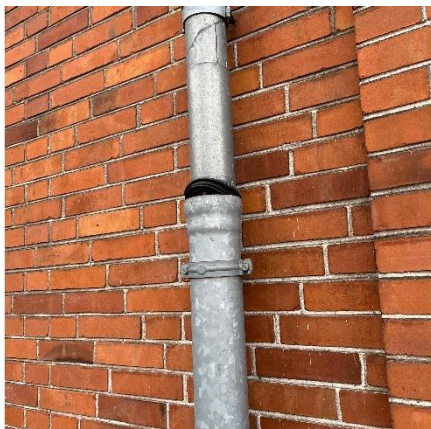
Gummiring ikke monteret korrekt
