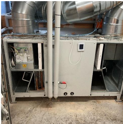
Ventilationsanlæg i kælder
