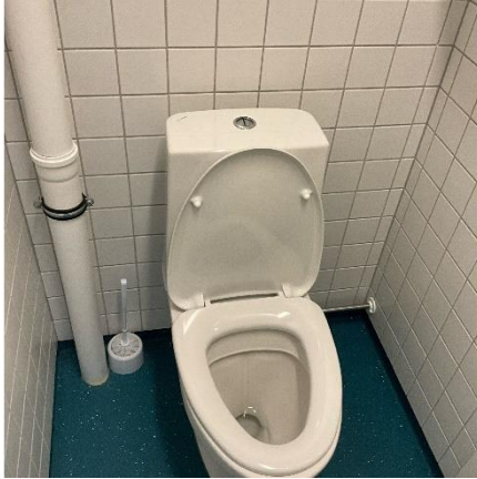
Faldstamme i plast på personaletoilet
