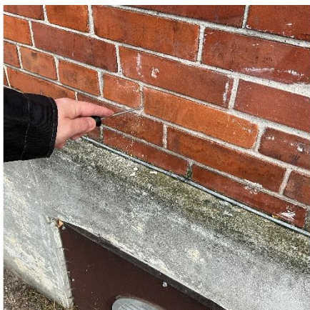
Løse fuger i murkonstruktion
