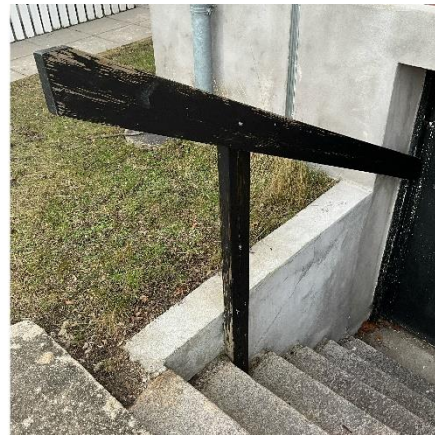
Afskallet maling og råd på gelænder ved trappenedgang
