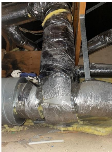
Alle vent rør på loft er isoleret
