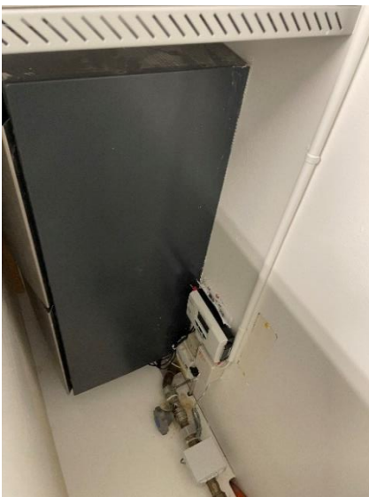
Varmer installation gemt bag opskruet let væg
