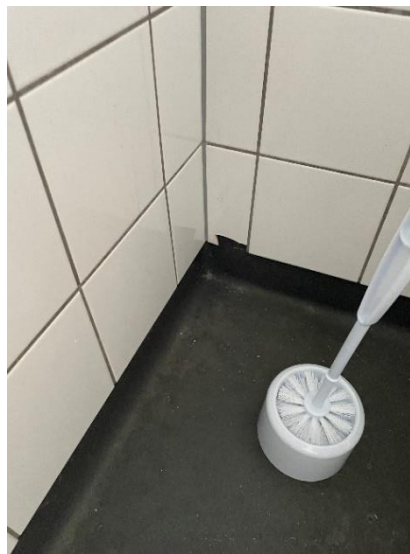
Beskadiget vægflise på toilet
