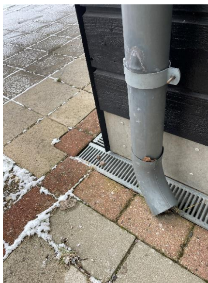
Sokkelplade bag nedløbsrør
