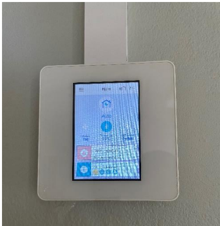
Betjeningspanel til ventilation
