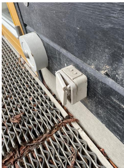
Beskadiget udendørs stikkontakt ved hoveddør
