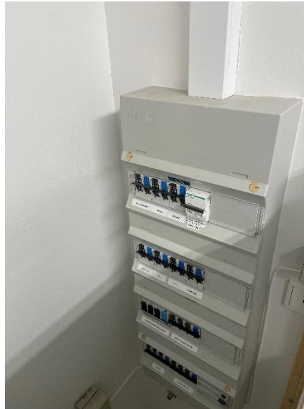
El tavle placeret i teknikbryggers bag væg se næste billede.
