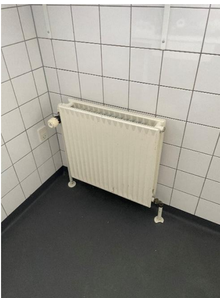
Radiator med termostatventil
