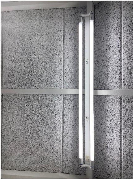
Belysning med LED rør i loft
