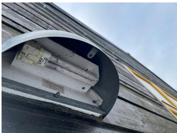
Udendørs lamper med kompaktør ved bygningens ende- gavl
