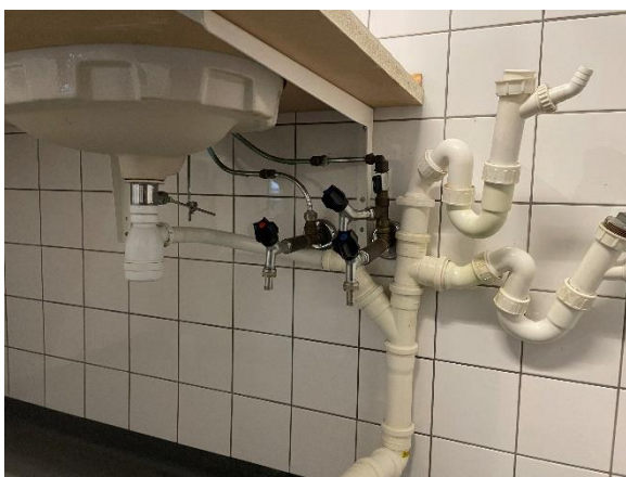
Vandlås installation på toilet
