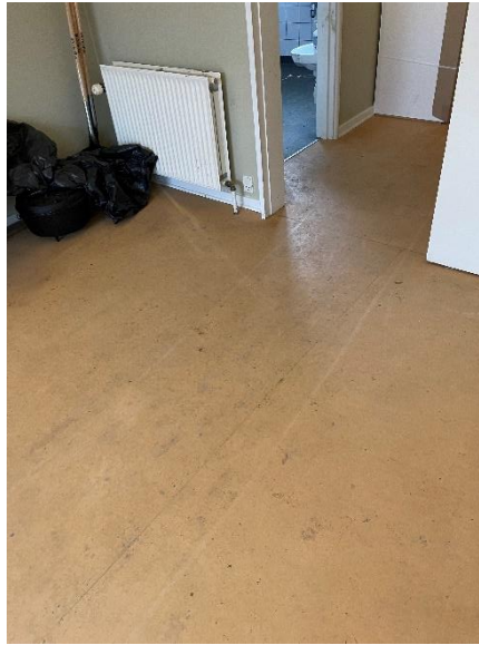
Linoleumsgulv har præg af beskidt fodtøj slider på det
