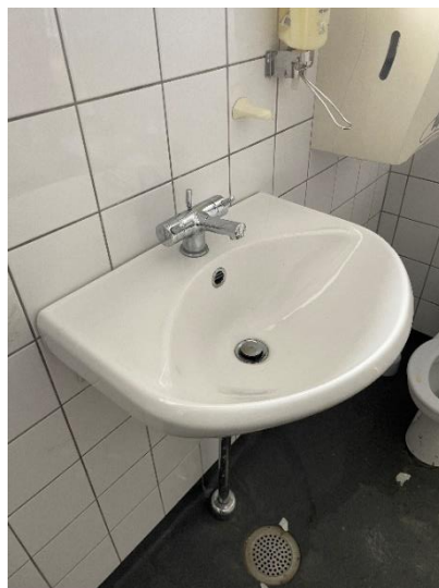
Afløb under håndvask
