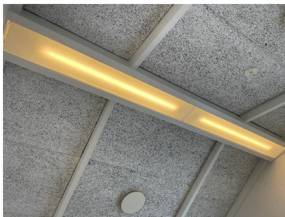
Belysnings armatur med spolerør i loft.
