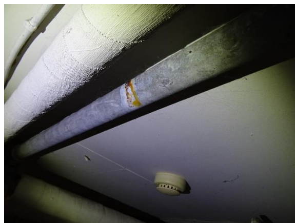
Tæring på galvaniseret rør
