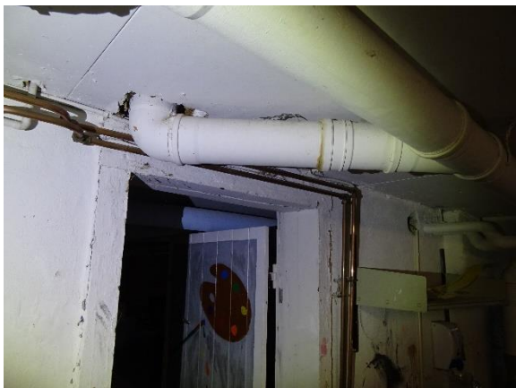
Plast afløbsledninger i kælder
