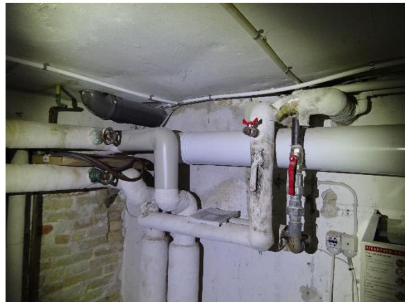
Ældre rør og afspærringsventiler
