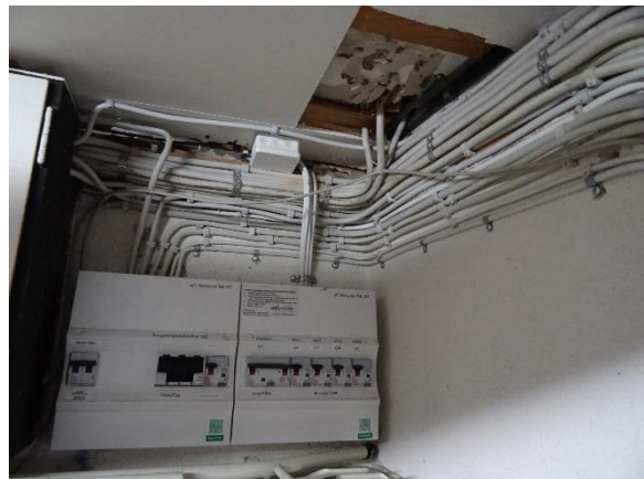
Eltavle i kælder og gennemføringer til stueetagen
