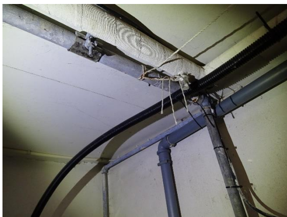
Galvaniseret rør med bandage og tæring
