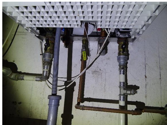
Gasforsyning under gasfyr
