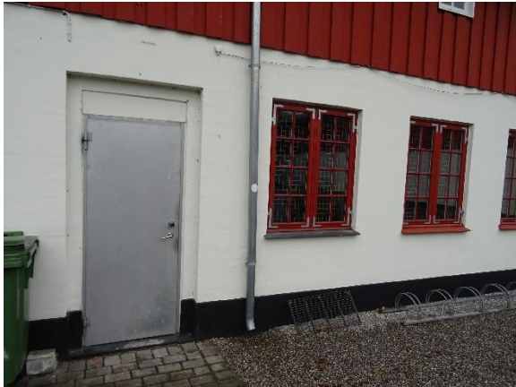
Ståldør fra vestre længe mod gård med eftermonteret elektronisk lås
