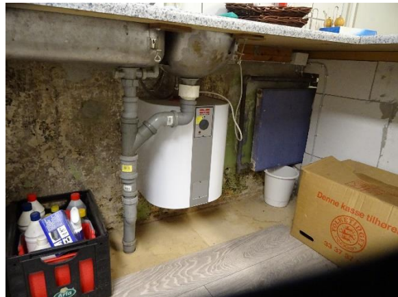
Varmtvandsbeholder BRC tekøkken.
