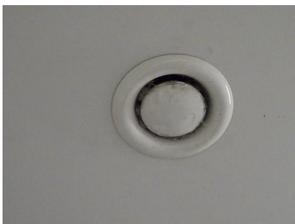
Beskidt kontrolventil fra toilet i stuehuset
