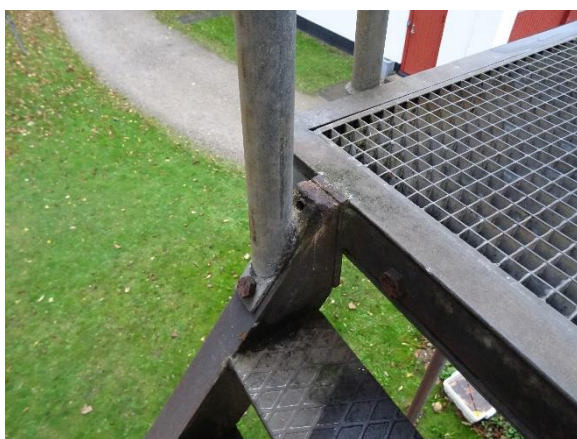
Tæring og manglende bolt på brandtrappe
