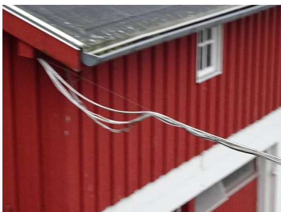
Kalbelforbindelse mellem bygninger
