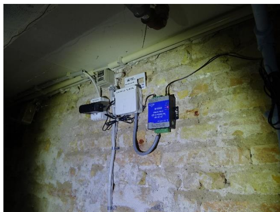
GSM modul for grundvandspumpe
