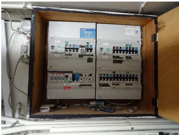
Eltavle i kælder stuehuset
