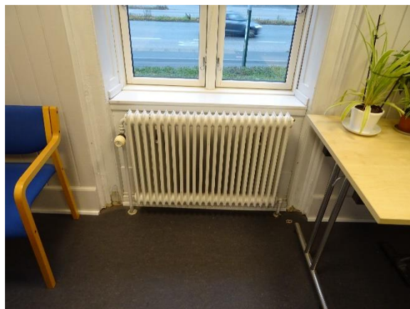
Søjleradiator i stuehuset
