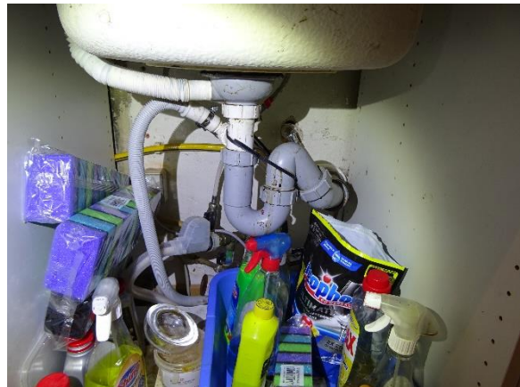
Afløb køkkenvask forening i vestlænge
