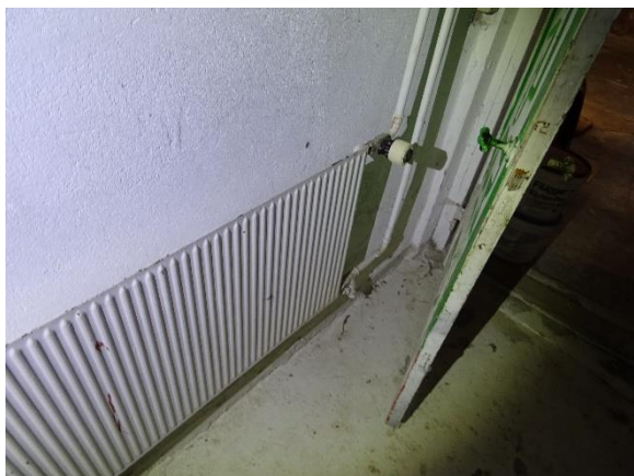
Etlags radiator i kælder
