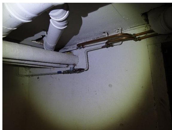
Kobberrør koblingsledninger i kælder
