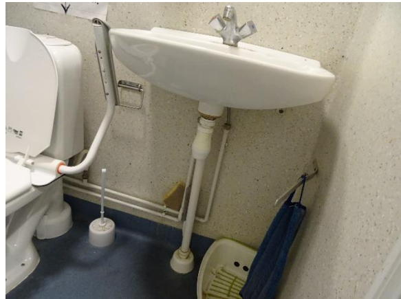
Afløb fra håndvask
