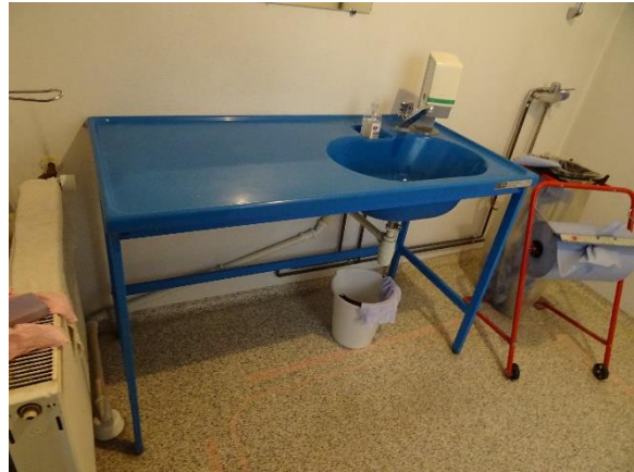
Håndvask / vaskebord i BRC toilet
