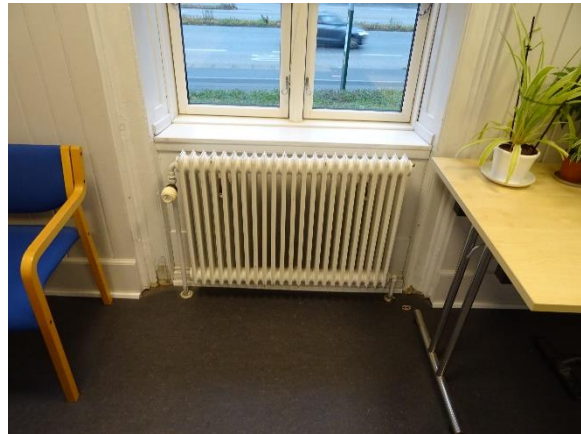
Søjleradiator i stuehus
