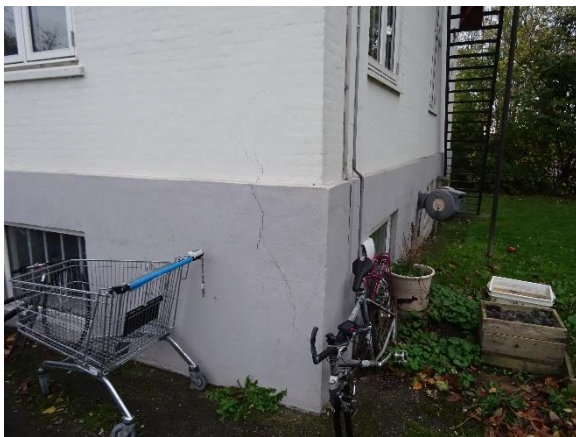
Mindre revne på nordvest hjørne
