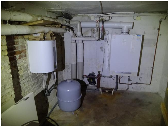
Gasfyr installation og blandepotte
