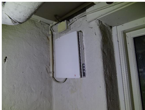
DUKA ventilator i kælder!
