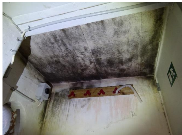
Mulig skimmelvækst i loft under hovedtrappe
