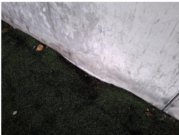
Indvendig fugtskade efter tilstoppet sandfangsbrønd
