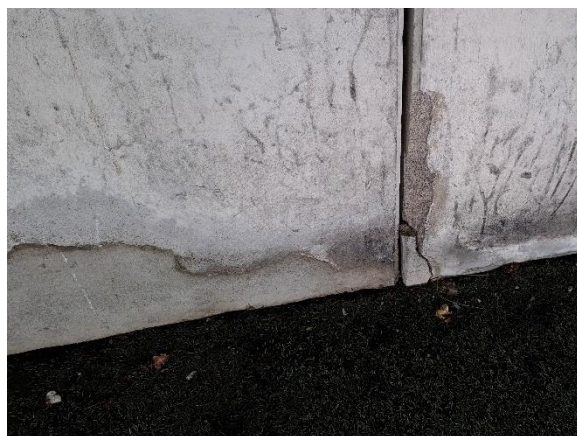
Afskallende hjørne og reparation af betonelement.
