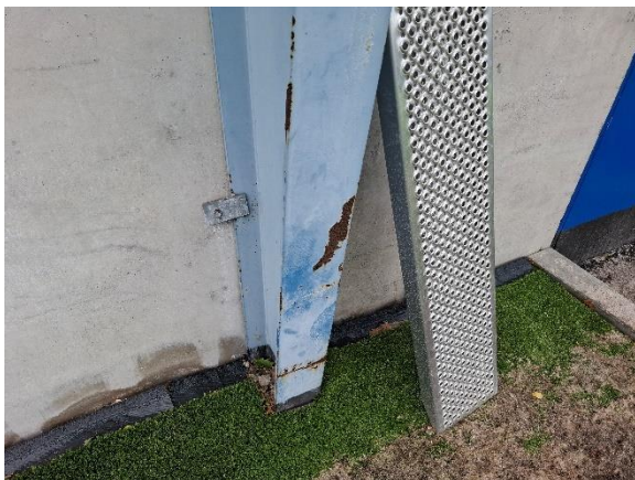
Afskallende maling på stålsøjle med rust.
