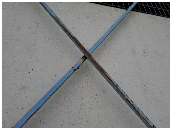
Rust på vindkryds
