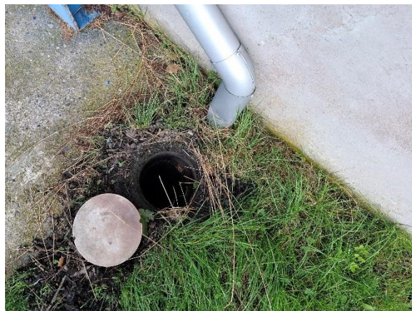
Sandfangsbrønd nyligt renset efter tilstopning.
