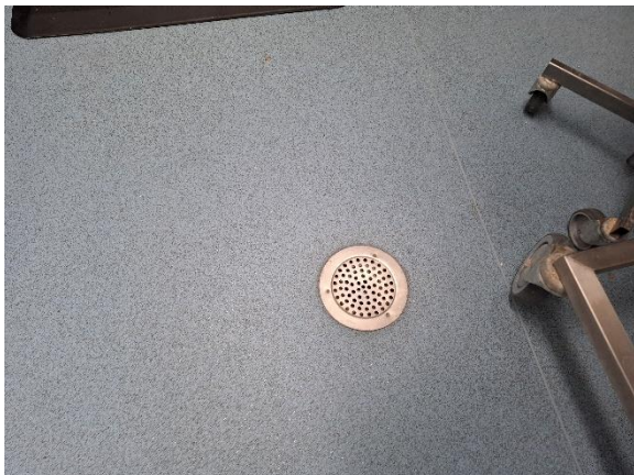
Gulvafløb i toiletrum
