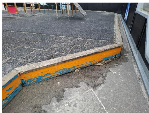
Træværk omkring faldsikker belægning er med nedbrudt træ.
