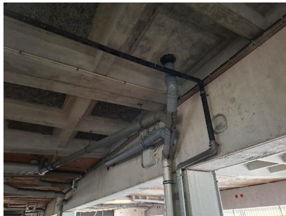
Utæthed i afløbsrør til udvendigt afløb under etagedæk
