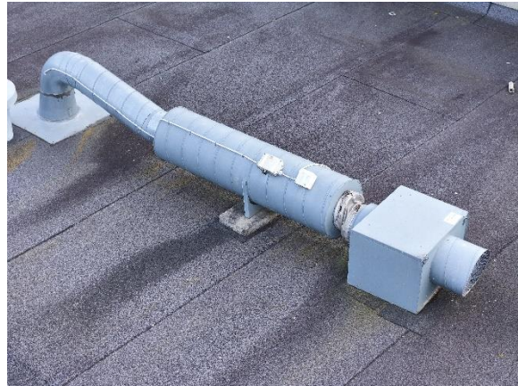
Ventilator til køkken fra 2010
