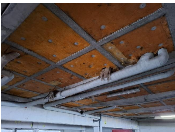
Rørføring isoleret under institutionen
