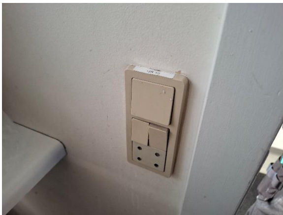
Ældre oprindelig stikkontakt
