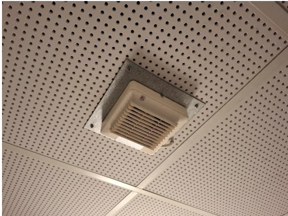
Udsugningsventilator i badeværelse
