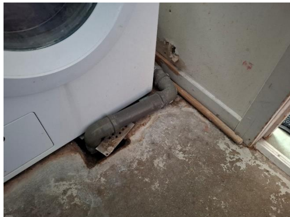
Afløb i teknikrum
