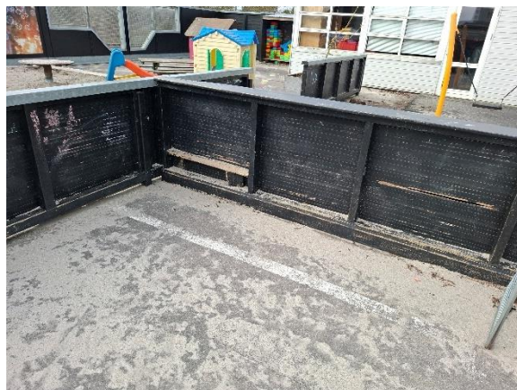
Plankeværk ved hockeybane er nedbrudt.
