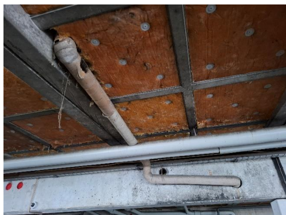
Rørføring isoleret under institutionen
