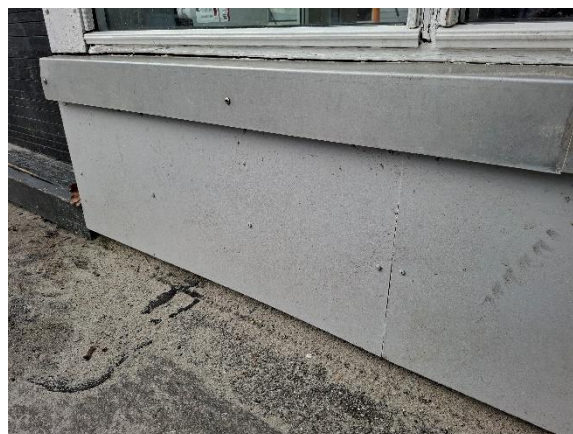
Brystning i liggehal. Vinduesparti med nedbrudt træværk.
