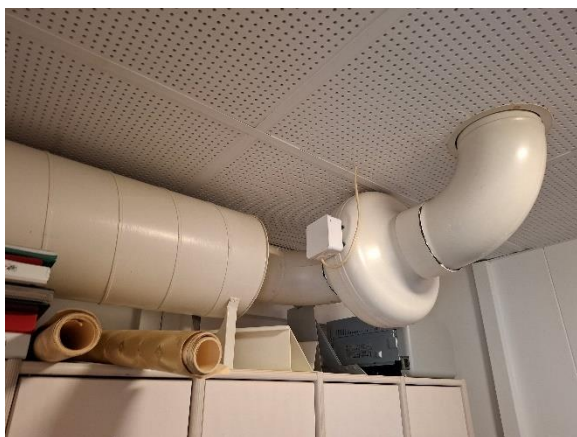
Udsugningsventilator i personaletrum
