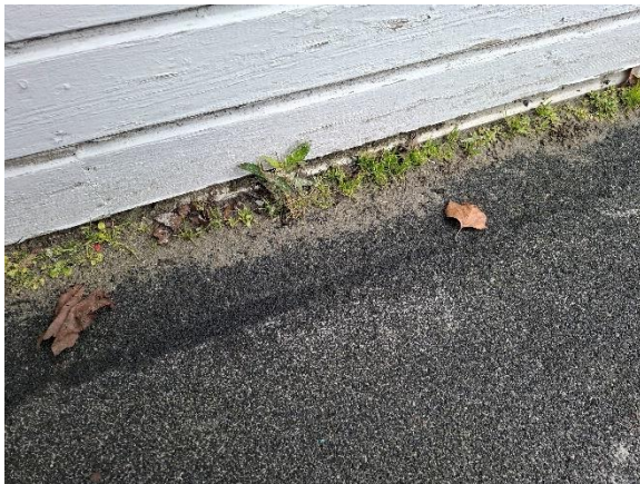
Facade ved gang til liggehal er med råd hvor der er bagfald på belægning, der tilmed er udført over facaden.
