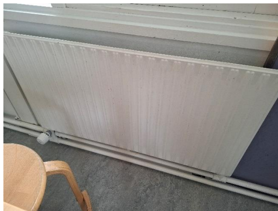
Radiator med termostatventil
