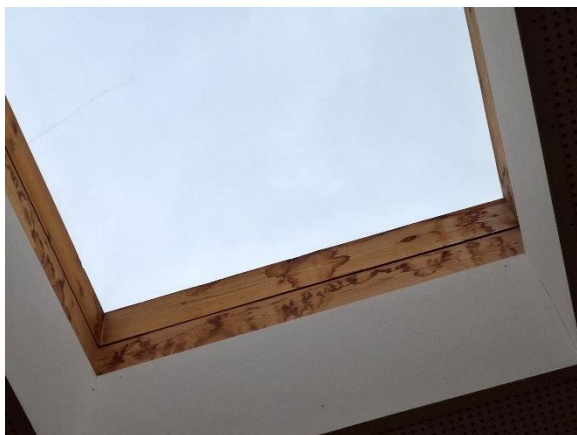
Fugtskjolder på træværk i ovenlyskuppel
