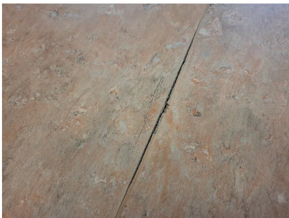
Svejsninger er revnet og linoleum med revner på gamle gulvflader.
