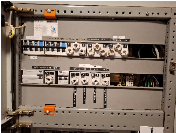
Tavle mangler afdækning
