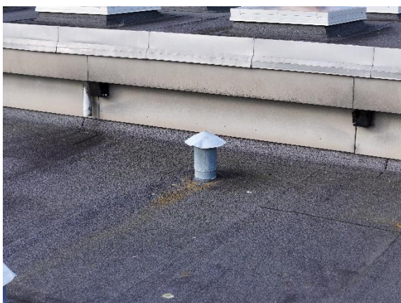
Nedløb fra forskudt tagflade mangler udkaster.
