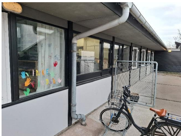
Vinduer i facade
