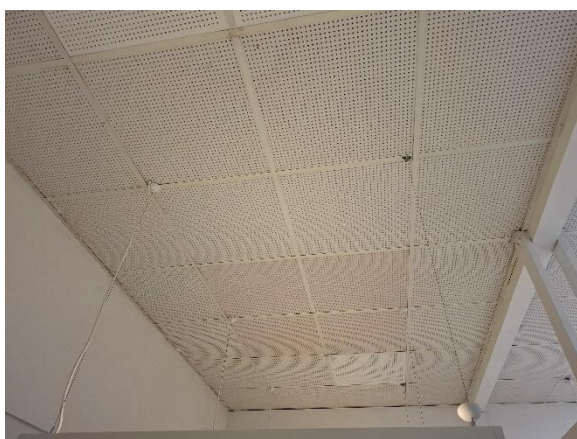
Løfter er primært system med akustikgipsplader.
