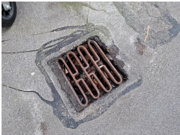
Udvendige afløb mangler oprensning
