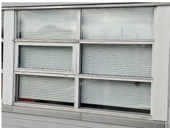
Vindue i liggehal trænger til malergennemgang.
