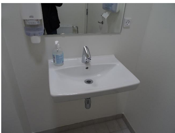
Håndvask m. berøringsfrit armatur voksentoilet
