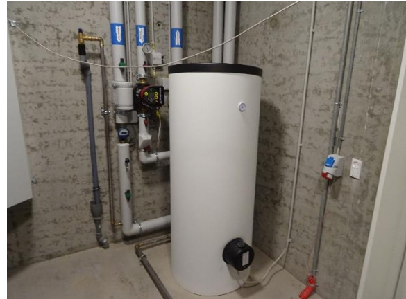
Varmtvandsbeholder og brugsvandscirkulation
