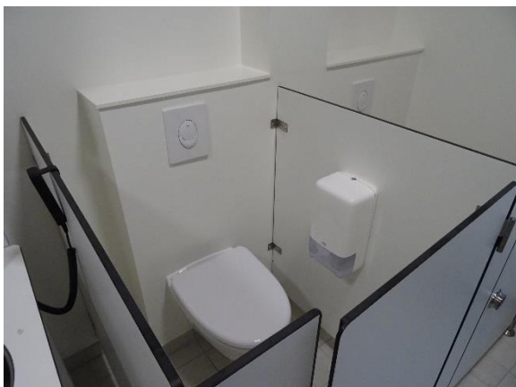
Børnetoilet med væghængt cisterne
