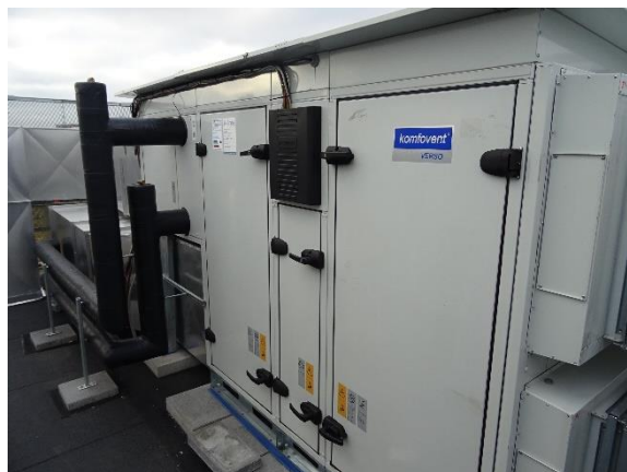
Komfortanlæg på tag
