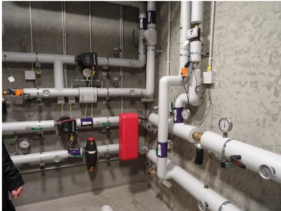
Varmecentral og veksler
