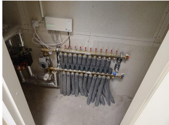
Gulvvarme shunt i skab
