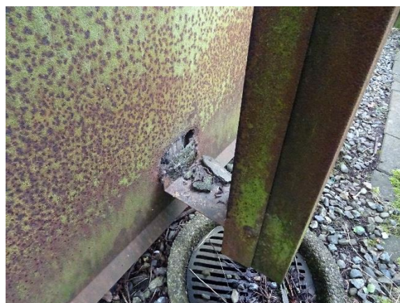
Gennemtæring i monteringsbeslag for tagedløb
