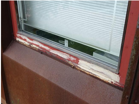
Oprindeligt trævindue med krakeleret maling
