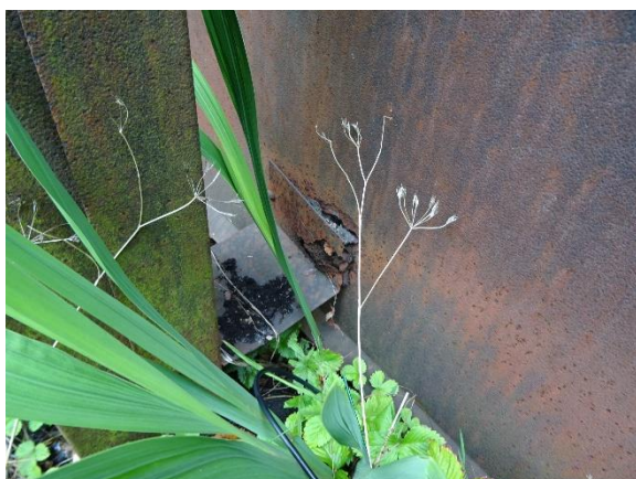
Gennemtæring i monteringsbeslag for tagedløb
