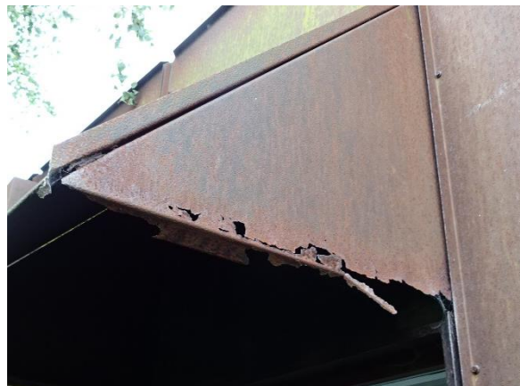
Gennemtæring på solafskærmning
