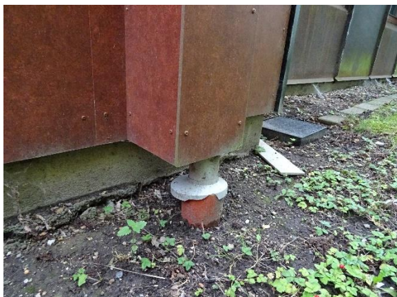
Skjult nedløb bag facadeplader på tilbygning fra 2021
