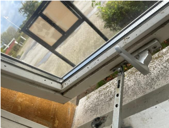
To lags termorude med kold kant ved offentligt toilet stue- etage. Bygn.20
