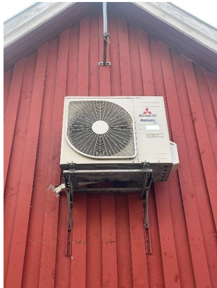
Mitsubishi varmepumpe luft-luft byng.18
