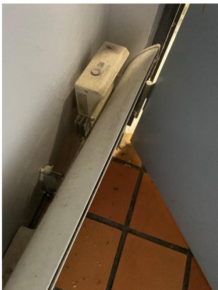
El-radiator i bagrum ved produktionskøkken der er defekt. Bygning.20
