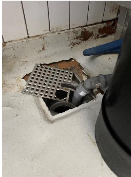
Afløb i produktionskøkken bygn.20
