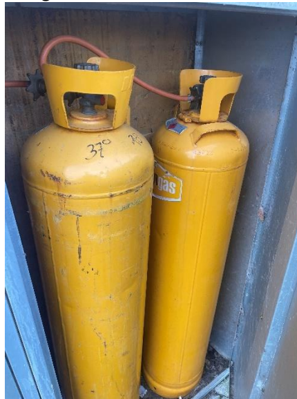
Gasflasker ikke sikret mod Væltning
