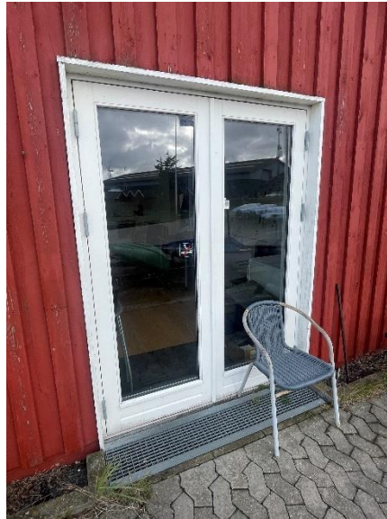
Dør med energiruder i bygn.18
