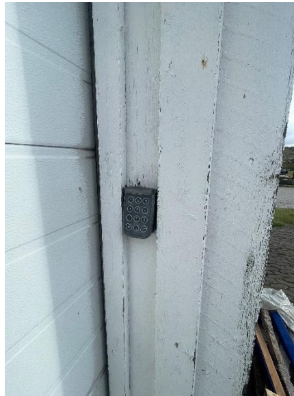
Adgangstastatur på garageport bygn.18
