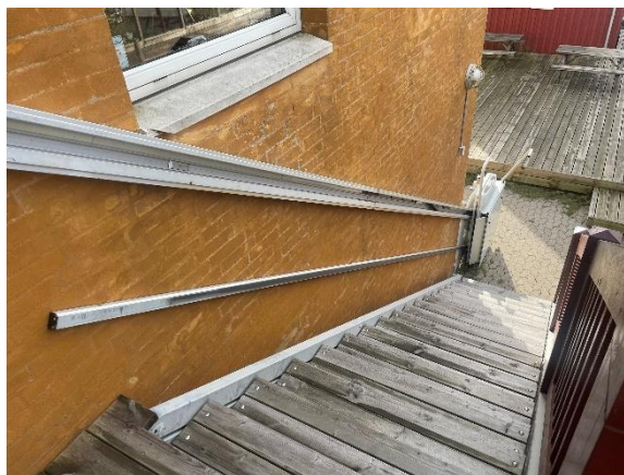
Handicap elevator op til terrasse i bygn.20
