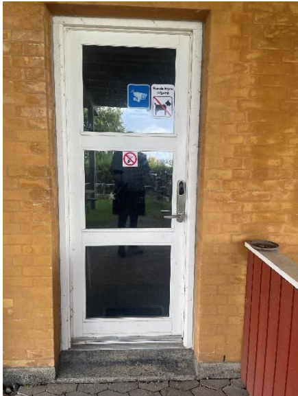
Dør med energiruder i bygn.20
