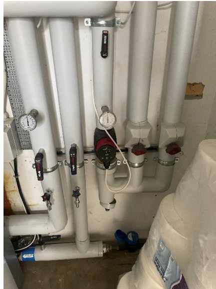
Vandinstallation i bygn.20
