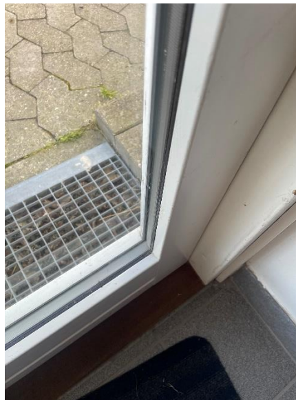
Glas dør med 2 lags energirude i bygn.18
