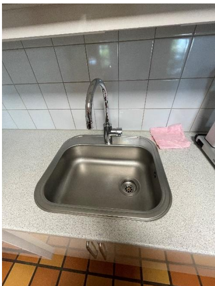
Håndvask i køkken stueetage bygn.20
