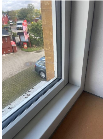
2 lags energirude varm kant 1. sal Bygn.20
