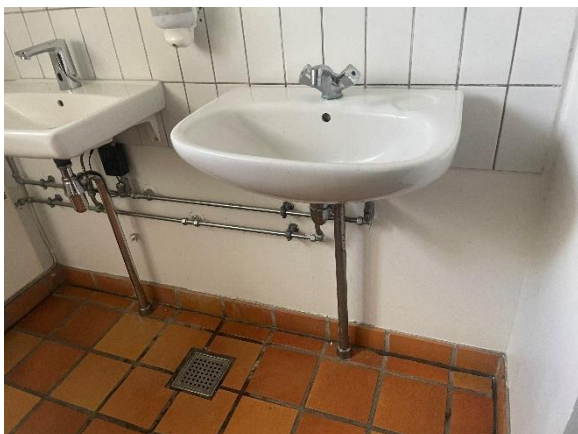
Håndvaske og afløb i offentligt toilet bygn.20
