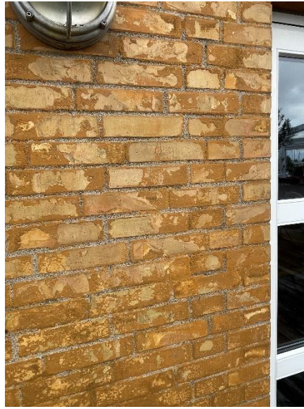
Murværk på bygn.20 lettere slidt af vind og vejr.
