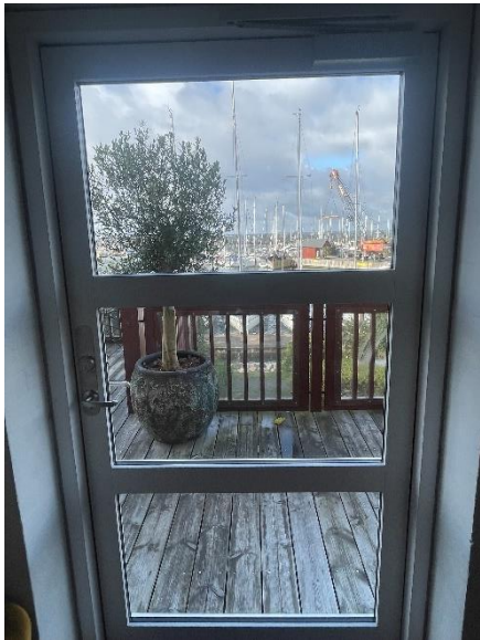
Glasdør med 2 lags energirude mod 1.sal Tereses bygn.20
