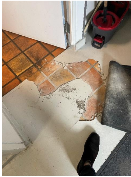
Skader på gulv i køkken/opvask i restaurant på 1.sal i bygn.20
