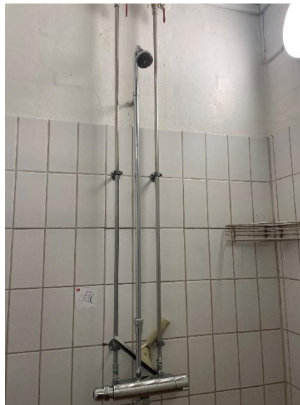
Bruserarmatur og vandrørsinstallation ved sejlklub bygn.20
