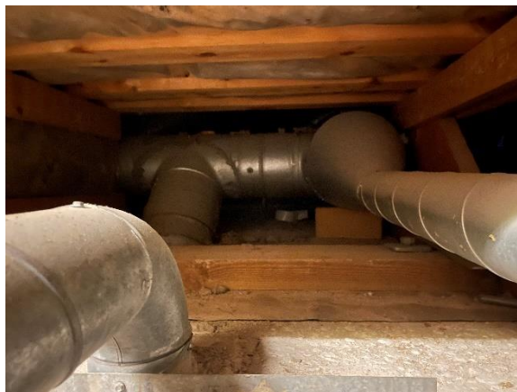
Mekanisk ventilationsanlæg type Exhausto VEX4 bygn.20
