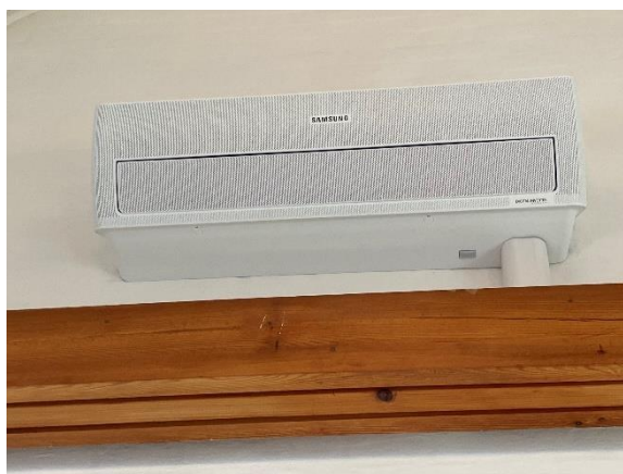
Varmepumpe inder installation i bygning.20 1.sal
