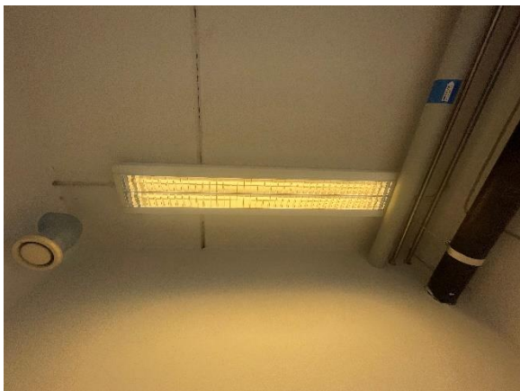
Mekanisk udsug i sejlklub stueetage bygn.20
