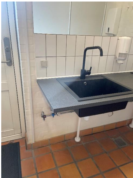
Håndvaske og afløb i sejlklubs toilet bygn.20
