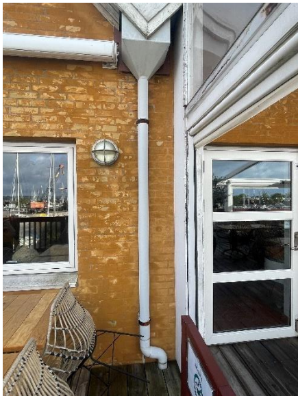
Afløb for tagrende gennem 1.sal terrasse bygn.20
