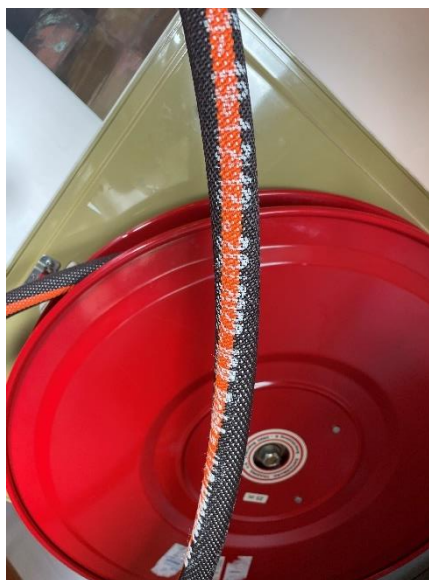
Slangevinder i restauranten i bygn.20
