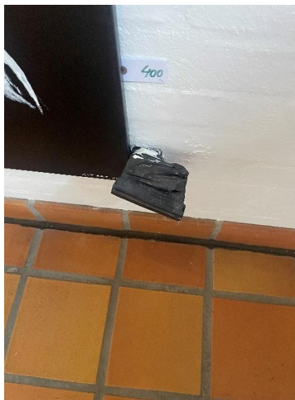
Afblændet stik til el radiator stueetage bygn.20
