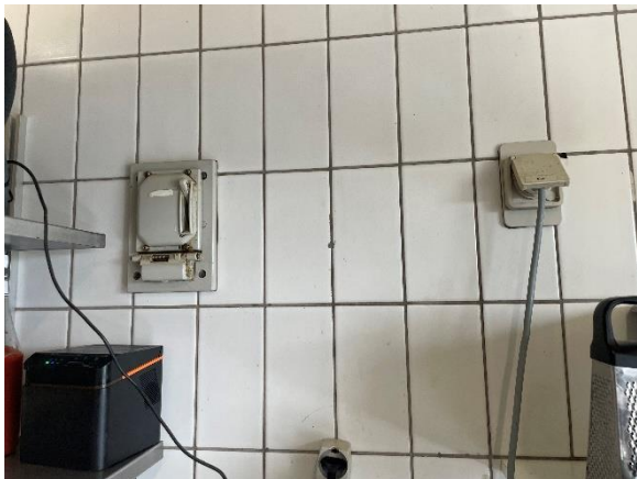
Kraftstik og installationsmateriel i restaurant køkken bygn.20
