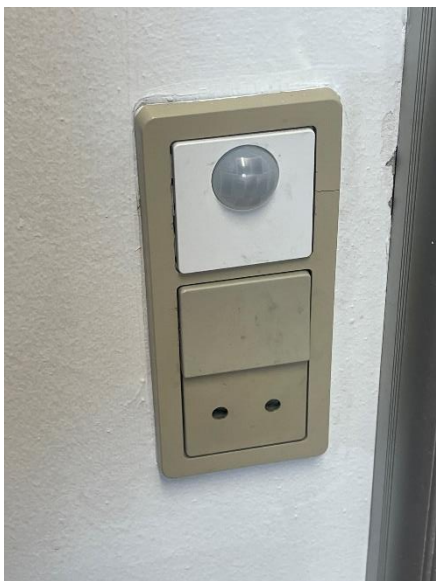
Ældre installationsmateriale med sensorstyring af lys bygn.20
