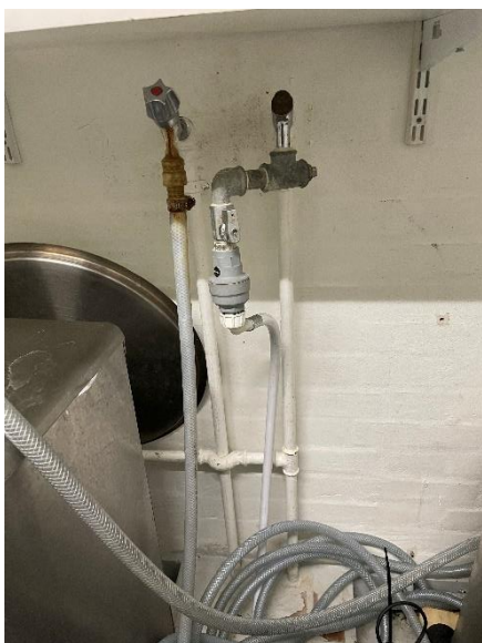
Vandinstallaioner i køkken i bygn. 20
