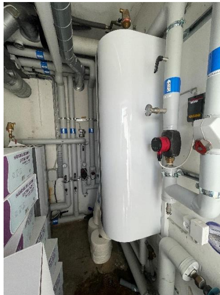
Vandinstallation inkl. varmtvandsbeholder i bygn.20
