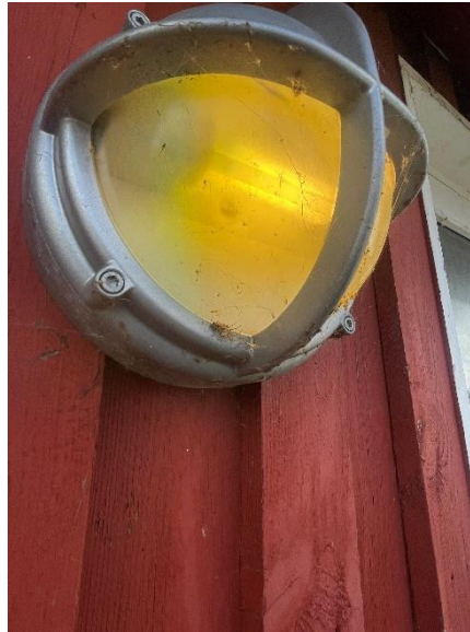
Udvendigt belysningsarmatur på bygn.18
