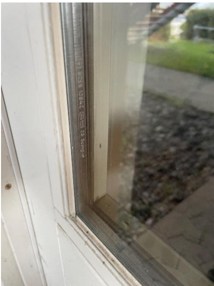
To lags termorude med kold kant ved sejklub, stueetage. Bygn.20
