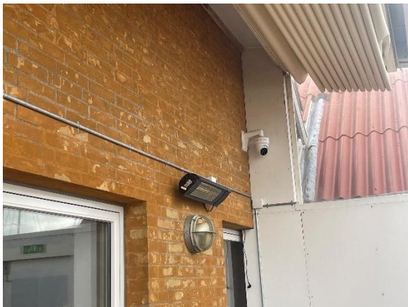
Overvågningskameraer på terrasse 1.sal bygn.20
