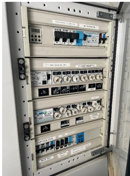
Tavlefelt i hovedtavle teknikum stueetage bygn.20
