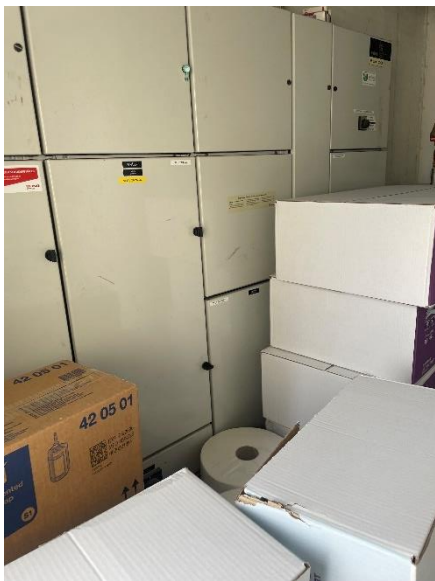
Blokeret hovedtavle teknikum stueetage bygn.20
