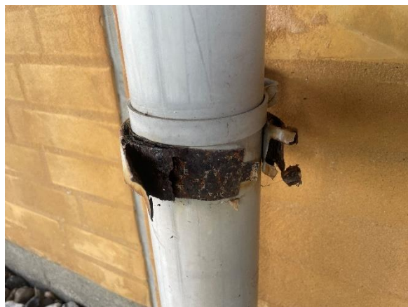
Beslag til tagrende afløb der er hårdt angrebet af rust. bygn.20
