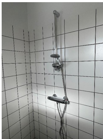
Bruserarmatur i bygn.18
