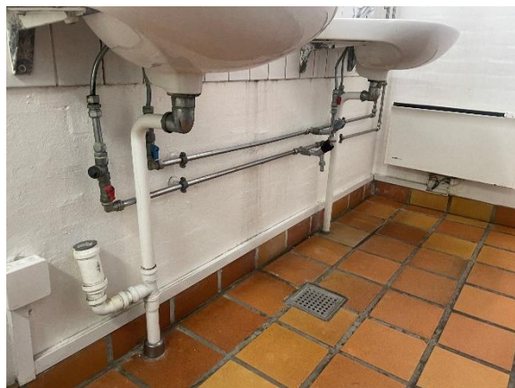
Håndvaske og afløb i offentligt toilet bygn.20
