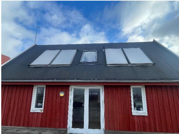
Solvarmeanlæg fra 2008-9 på bygn.18
