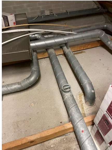
Mekanisk udsugsinstallation over loft 1.sal bygn.20
