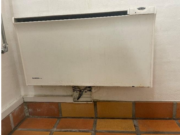
El radiator i bygn.20
