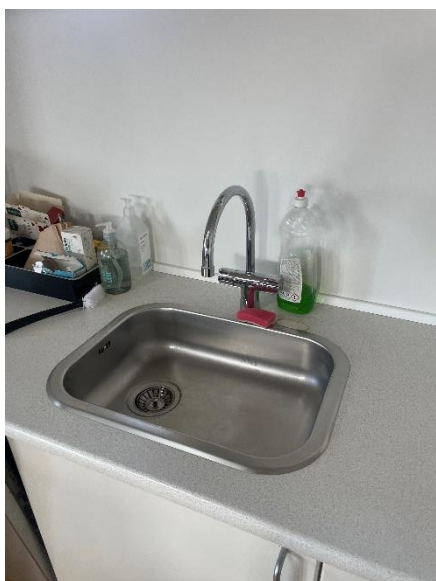
Håndvask i køkken bygn.18
