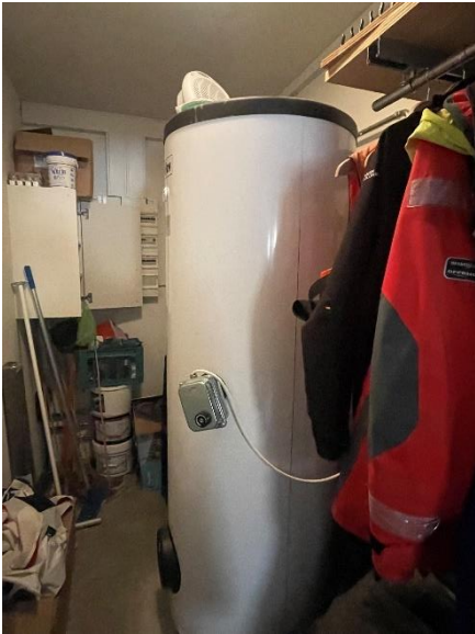
470 l varmtvandsbeholder i bygn.18
