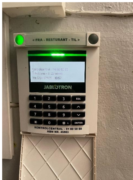
Alarm panel ved bagdør til køkken bygn.20
