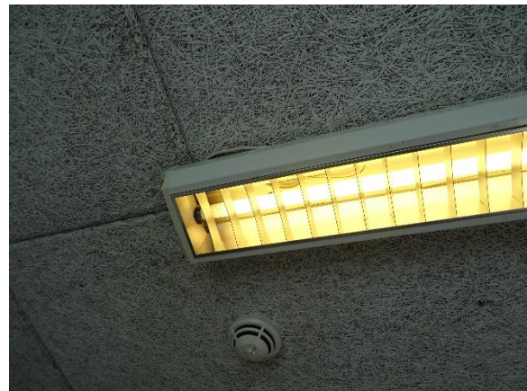
Ældre lysstofrør armatur
