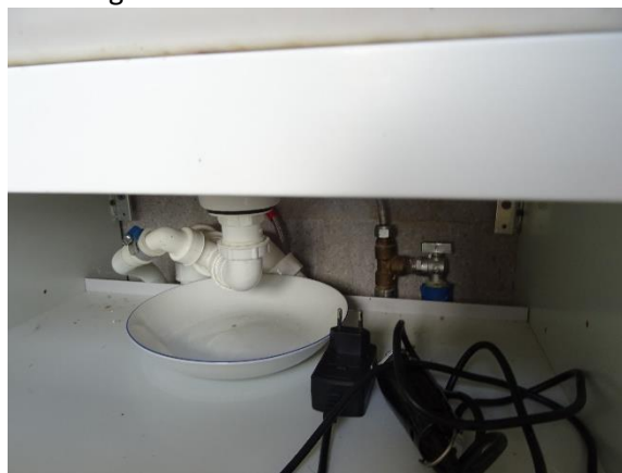
Afløb under vask, skål pga. utæthed
