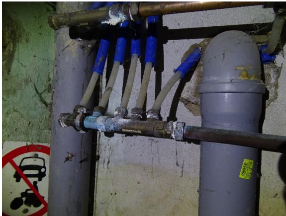
Fordelerrør i kælder i messing
