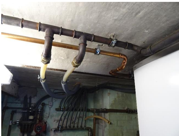
Fordelerrør til slangevinder
