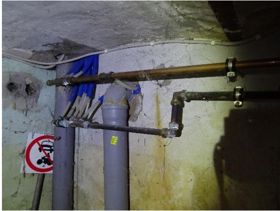
Koldt og varmtvandsrør i kælder
