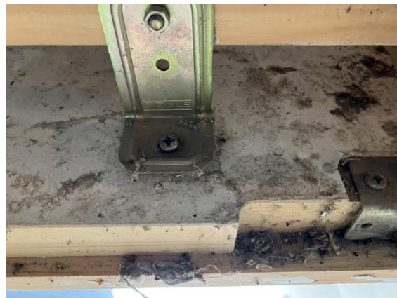
Loftstrappe, løs skrue
