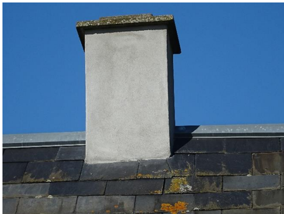
Skifer er let hævet og revner omkring skorsten
