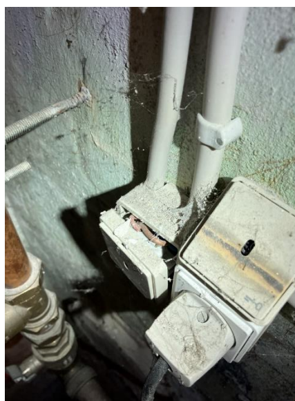
Løse stik på dåser i kælder
