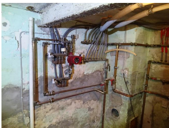
U-isolerede varmerør i kælder
