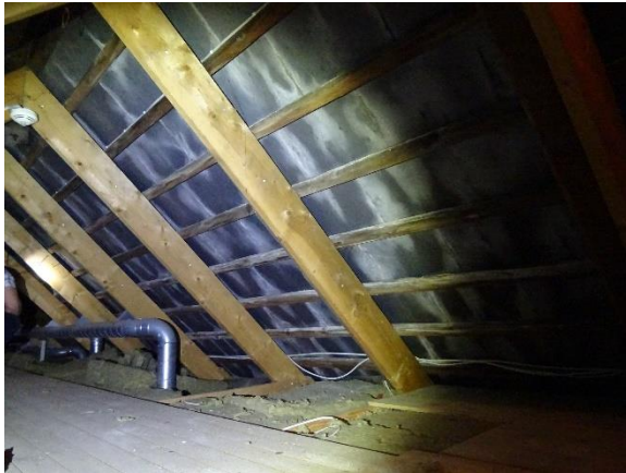
Udsugningskanaler på loft til ventilator ved gavl
