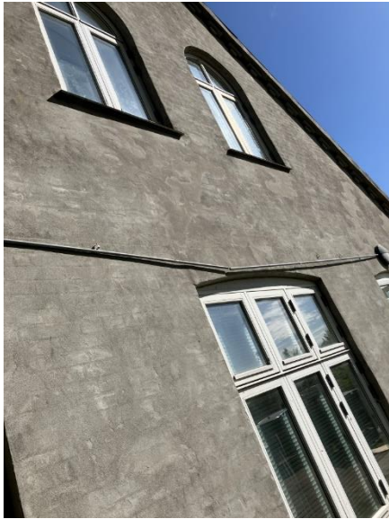
Føringsrør til udendørs belysning revet ud af bøjler
