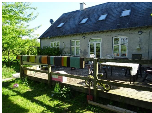
Terrasse bærer præg af brug.
