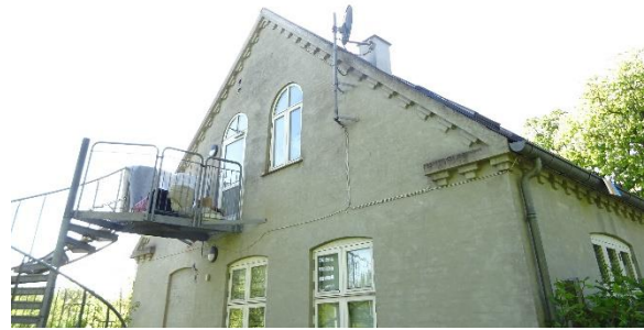
Løse ledninger på nord gavl
