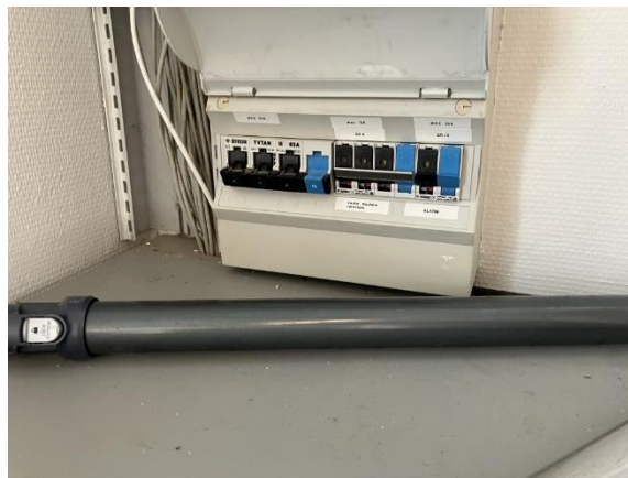
Enkelt gruppe mangler korrekt opmærkning af forbruger.
