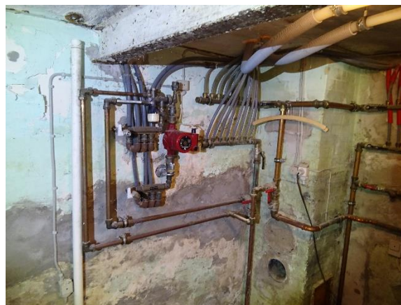
Fordelingssystem og gulvvarmeshunt
