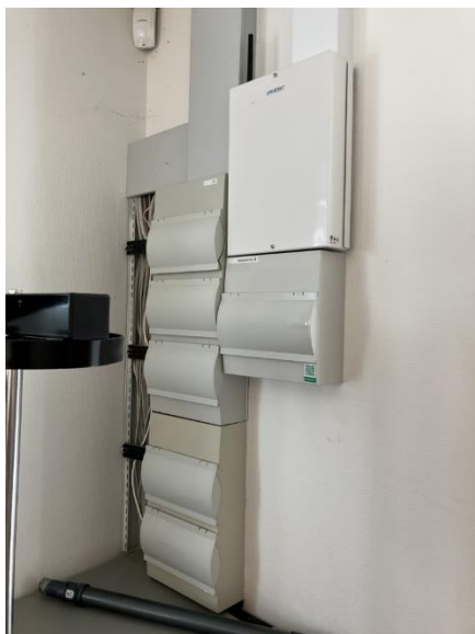
Generelt god stand. Mangler dog dækplade på kabelkanal.
