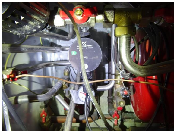
Alpha2L 15-60 130 på varmfordelings unit
