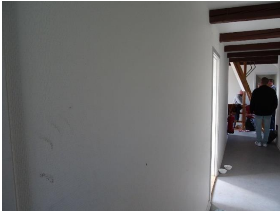
Vægge står med få skader, men mangler nedvaskning.
