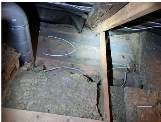
Isolering løftet af og ikke reetableret
