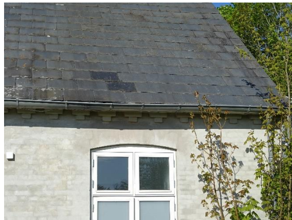
Tagrende har bagfald før nedløb
